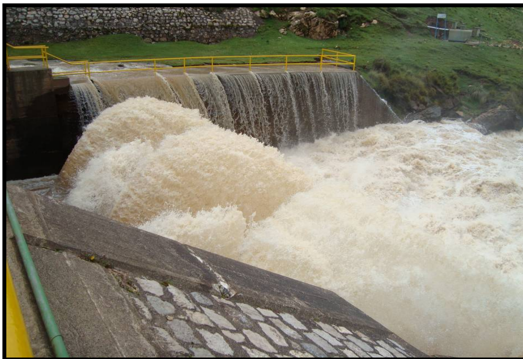
Fotografía N° 6: Descarga de las aguas almacenadas en la Represa Upamayo a través de las compuertas y aliviadero de demasías, por haber alcanzado la cota máxima de almacenamiento.
