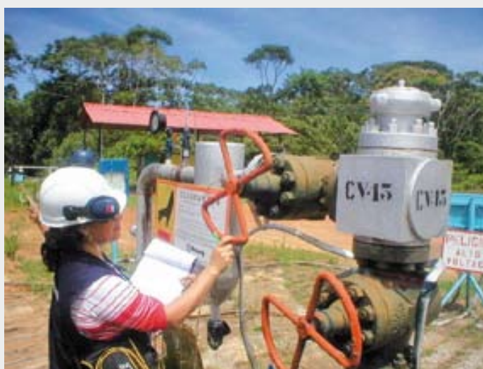
Cierre del pozo CN 13 lote 1 AB.
