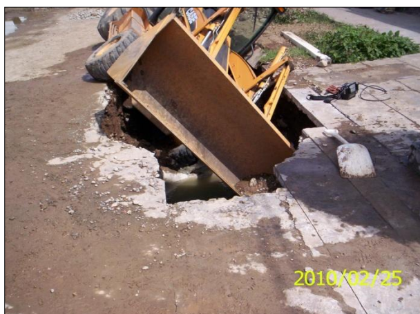
Hundimiento de retroexcavadora en la cuadra 9 de la Av. Félix Divos
