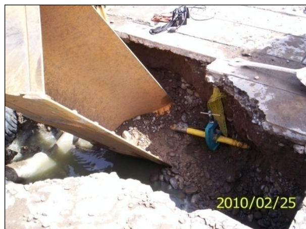
Impacto de la pala con la tubería de polietileno y la prensa que controló la fuga de gas natural
