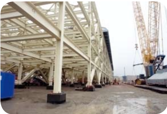
Parte de las estructuras metálicas y aero enfriadores instalados en el Proyecto Pampa Melchorita
