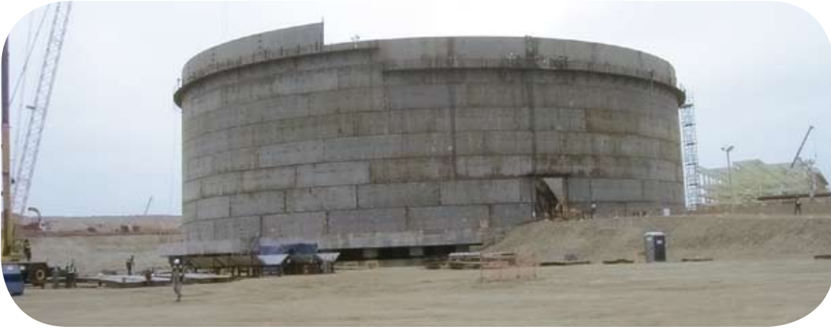
Construcción de uno de los tanques de GNL del Proyecto Pampa Melchorita
