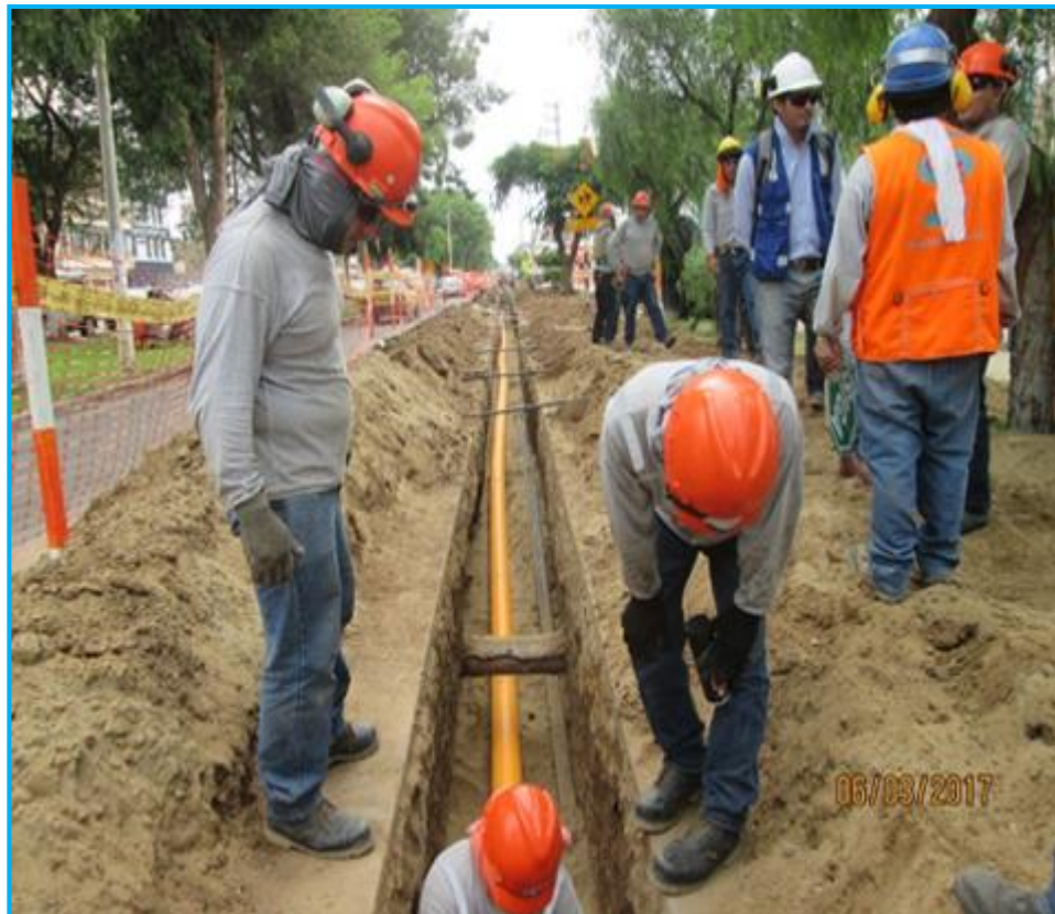
- Redes Trujillo, vista de instalación de tubería de PE de Ø200 mm, Avenida Túpac Amaru, cuadra 4.
