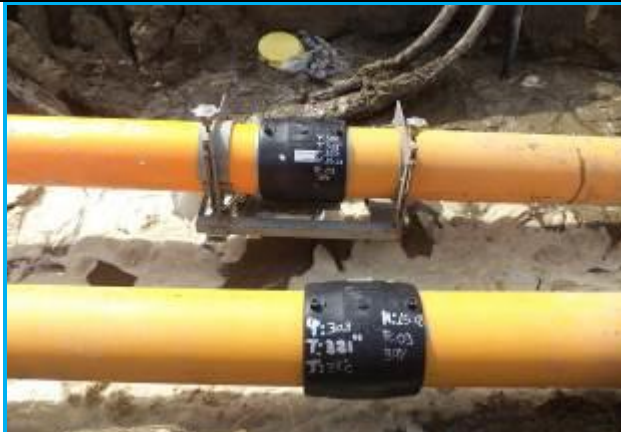
Foto 19.- Redes Chimbote.- Inspección visual de accesorios de unión por electrofusión, Ø200mm en Jr. Santo Toribio.
