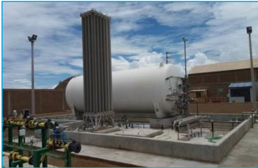
Foto 09.- Vista de la zona de procesos de la estación de distrito, se aprecia el agua de lluvia acumulada en la zona de drenaje del cubeto.
