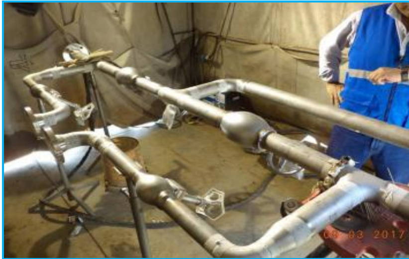
Foto 18.- Vista de los trabajos de armado y soldeo de prefabricados en zona de procesos.
