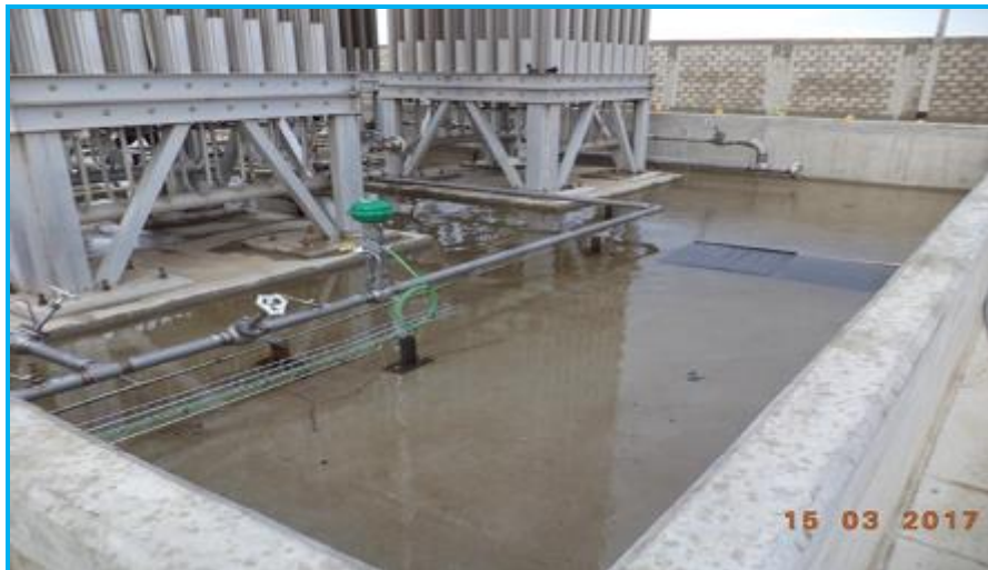
Foto 05.- Vista de la zona de gasificadores, se paralizaron los trabajos por fuertes lluvias y acumulación de agua en el interior de la estación de distrito.
