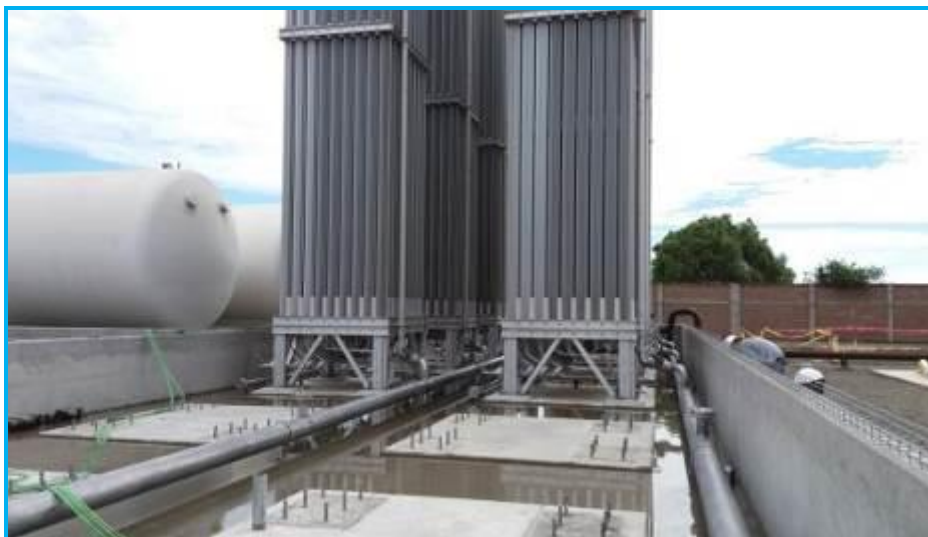
Foto 2.- Vista de la Estación de Distrito Trujillo, zona de gasificadores
