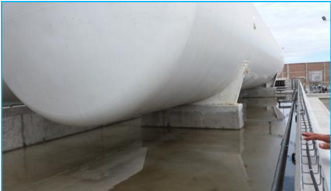
Foto 06.- Vista del interior de cubeto de tanque de GNL. El agua de lluvia se concentra en la zona de drenaje.
