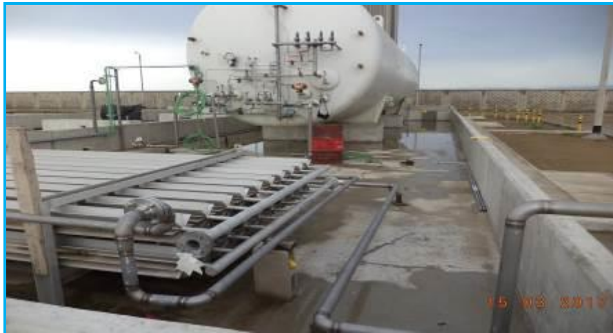
Foto 04.- Vista de la zona de tanque de GNL, se paralizaron los trabajos por fuertes lluvias y acumulación de agua en el interior de la estación de distrito.
