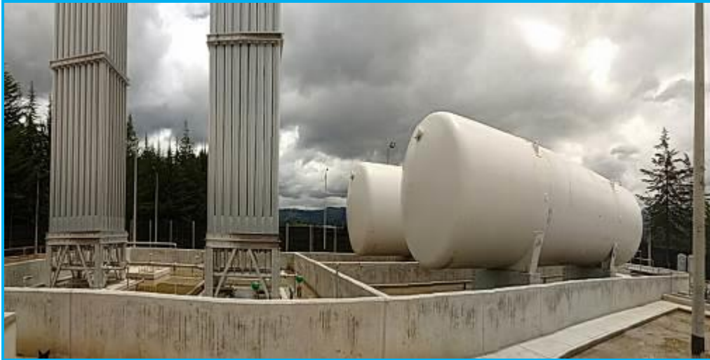
Foto 11.- Vista panorámica de E.D. Cajamarca, se aprecia agua retenida en cubetos a causa de la lluvia.
