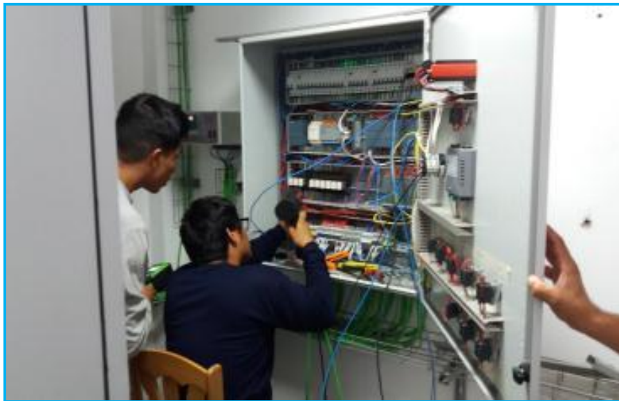
Foto 10.- Vista del panel de PLC, se encuentran en pruebas de funcionamiento de controles de mando desde sala de control.
