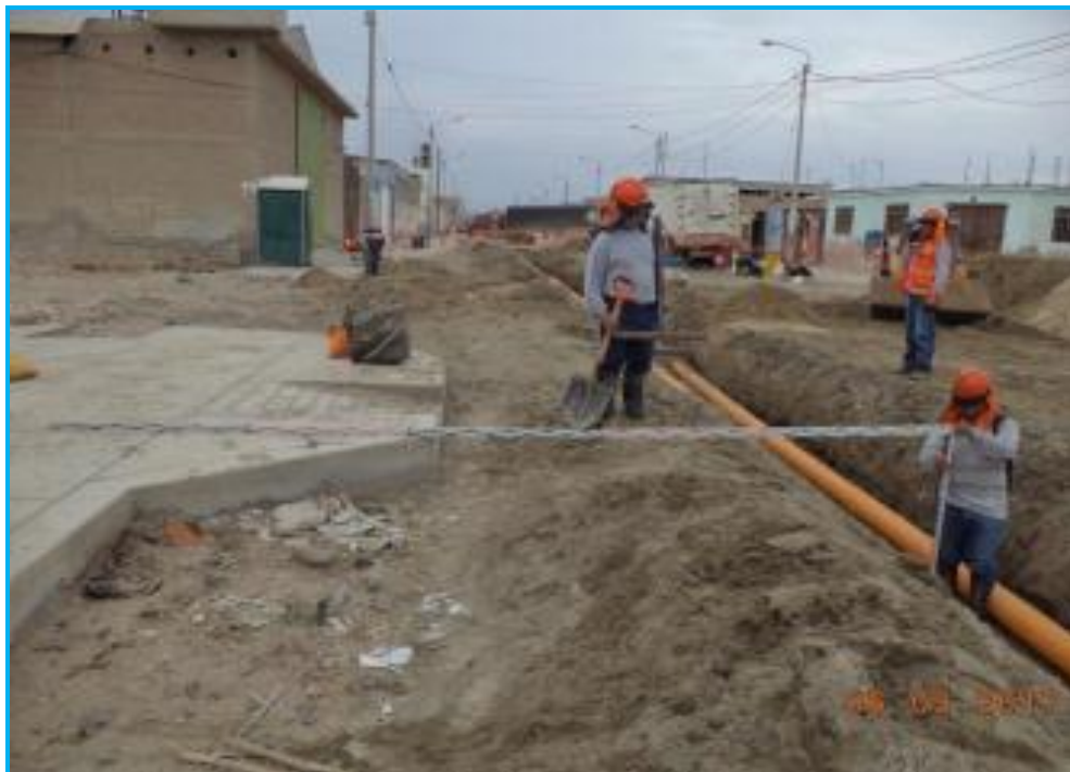
Foto 16.- Redes Chimbote, vista de Av. Brasil, Cuadras N° 3 y 4, verificación de la medida entre la tubería de gas y edificaciones.
