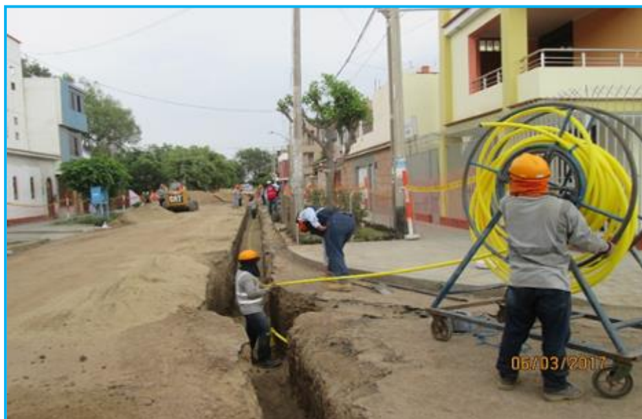
Foto 08.- Redes Trujillo, Instalación de tubería de PE 80 de \varnothing 32mm en cama de arena, Proyecto: Plan Piloto de Urb. El Bosque Trujillo.
