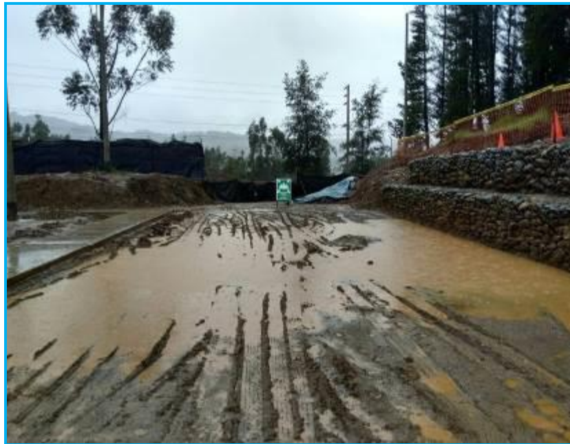
Foto 20.- Vista del ingreso a la estación de distrito, terreno con presencia de agua por precipitaciones de lluvias.
