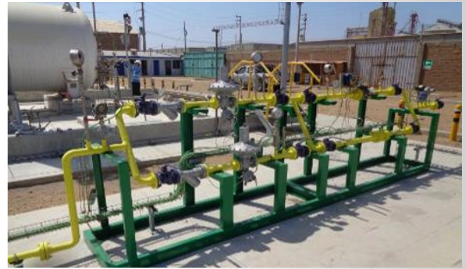
Vista de la Estación de Distrito de Pacasmayo, zona de la ERM .
