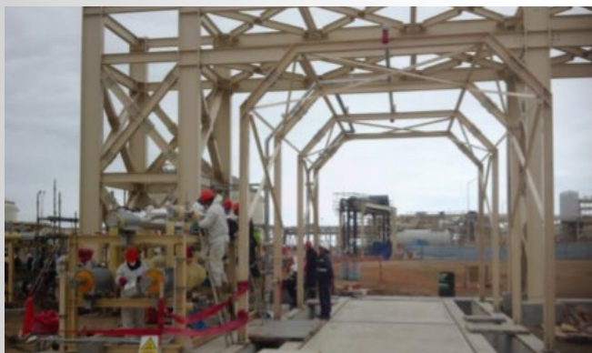
Vista de balanza de carga instalada y trabajos de aislamiento térmico de tuberías de la unidad de carga de GNL.
