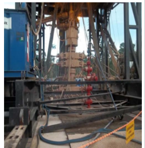
Locación Sagari AX. Vista del conjunto BOP (Blowout Preventer, utilizado para evitar un reventón), sistema de seguridad del Equipo de Perforación del pozo. D.S.043-2007-EM
