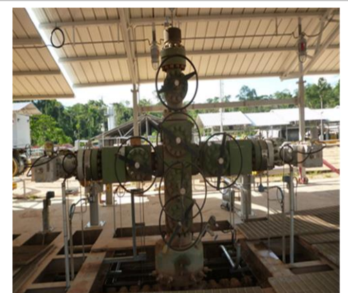
Cabezal de Producción de pozo en Sagari AX, con válvulas principales (master valves) y válvulas laterales (wing valves) de control de flujo y de seguridad. D.S.032-2004-EM
