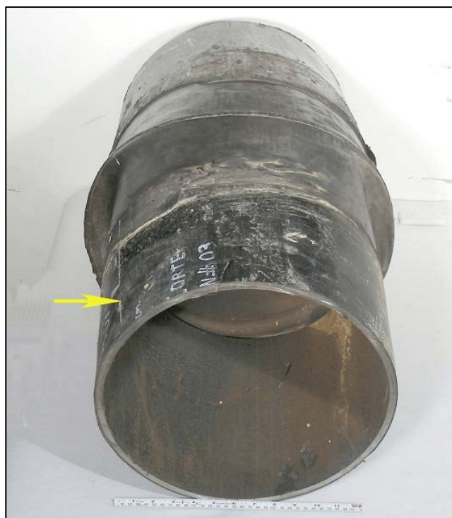
FOTO N° 09: Junta 084/83, vista oblicua del tubo pandeado. Con una flecha se indica la parte superior, marca 12 h. (Fuente: Informe Laboratorio de Stork)
