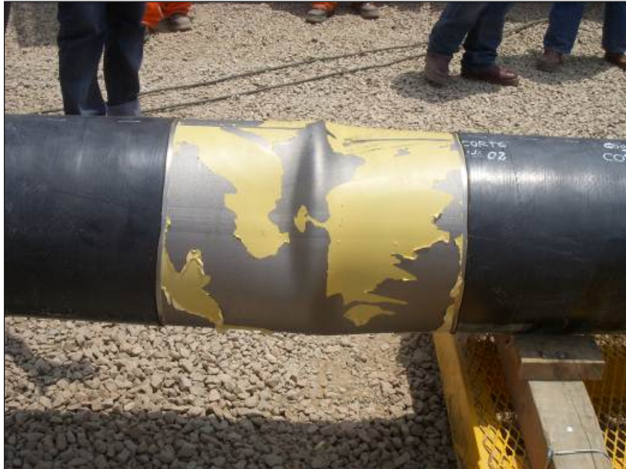
FOTO N° 04: Arruga aguas arriba de la Junta 084/83, un doblez con pliegue. No presentaría fuga.
