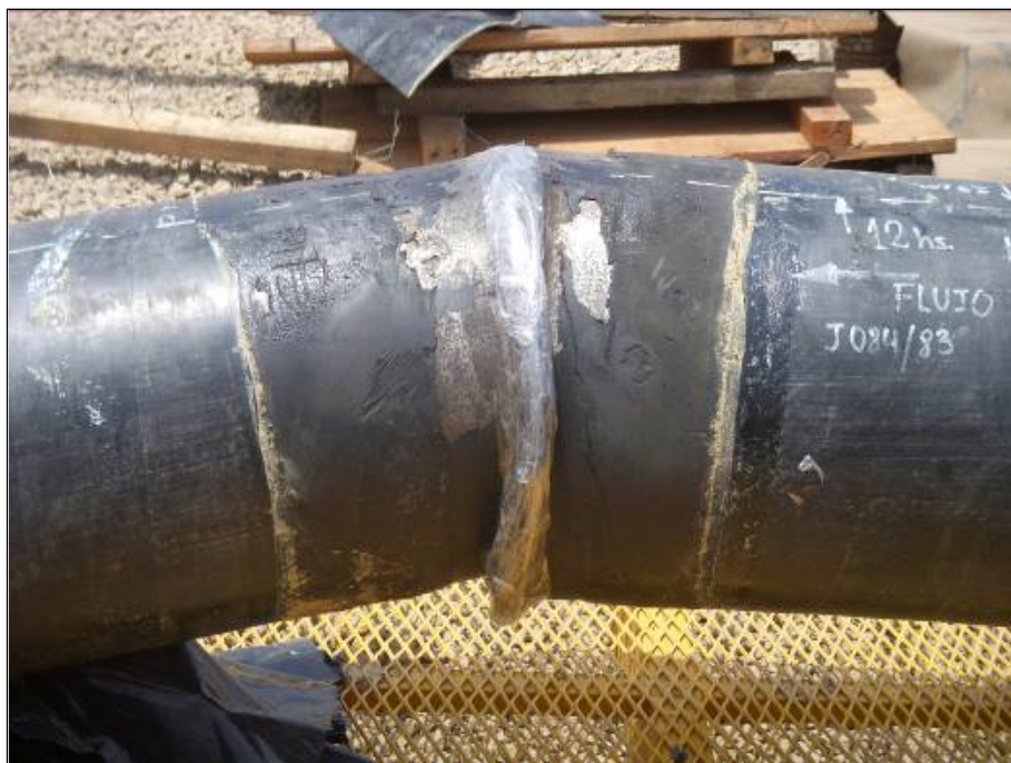
FOTO N° 05: Junta 084/83, se observa arruga y junta soldada agrieta por donde se produjo la fuga.
