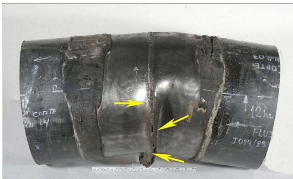
FOTO N° 06: Junta 084/83, vista del Vista de la parte superior de la tubería pandeada, indicado por la marca 12 h. La dirección del flujo se indica de derecha a izquierda. Las flechas indican las grietas en el doblé. (Fuente: Informe Laboratorio de Stork)
