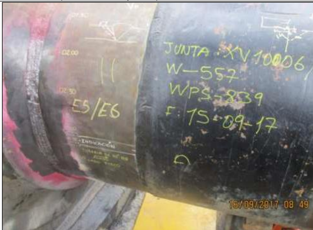
Figura 05: KP 179+412, vista de la junta reparada por fisura transversal externa superficial.
