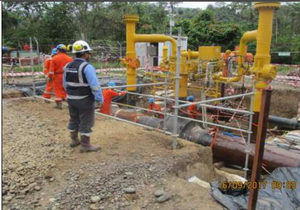
Figura 06: KP 179+412, supervisión de Osinergrmin durante los trabajos de reparación de la condición de riesgo detectada.
