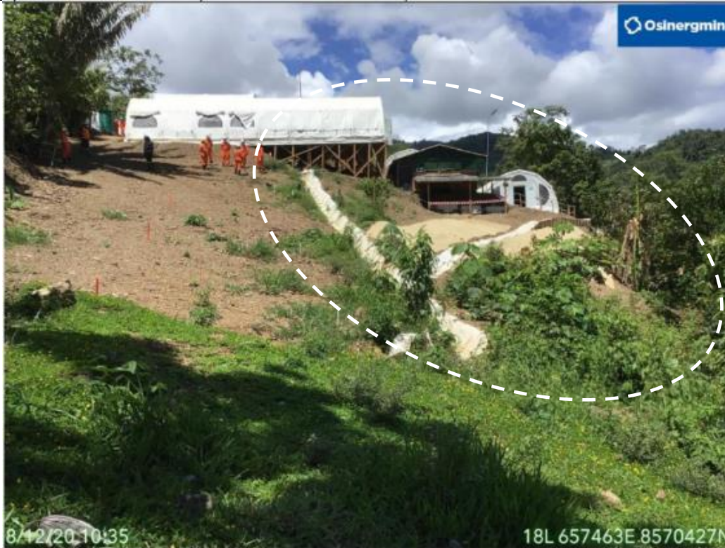
Figura 07: 181+800, verificación del lado derecho del DDV donde se realizaron trabajos de sellado de grietas y la construcción de obras de drenaje. La zona se halla cubierto con biomanto y estable.
