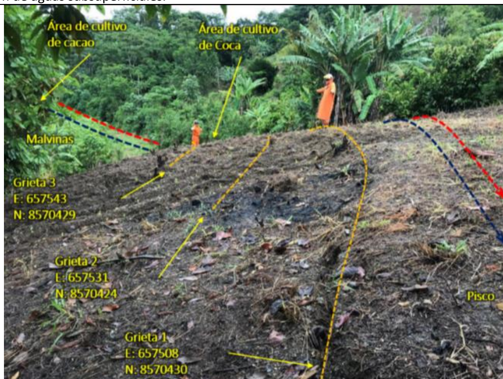
Figura 02: Vista Panorámica de la progresiva KP 181+800, donde se señala las tres grietas de tracción de longitud entre los 27m y los 32m a una distancia de 2m del ducto de gas natural. (Fuente TGP)
