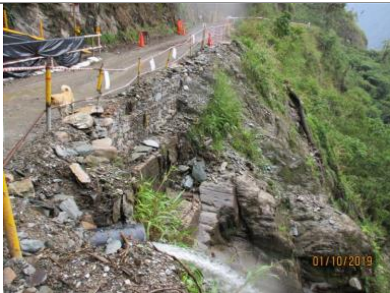
Figura 04: KP-194+989 del DDV de TGP / (WGS84, 18L 648127E 8566759N). Vista panorámica de la zona de cruce quebrada, progresiva del evento de mantenimiento del ducto de LGN. Presenta descole sobre macizo rocoso.
