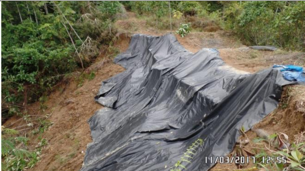
Figura 04: KP 003+400, panorámica del área afectada producto por un deslizamiento que descubrió y suspendió la tubería de 16", el cual se encuentra protegido con geomembrana para controlar los procesos erosivos producto de la escorrentía superficial.
