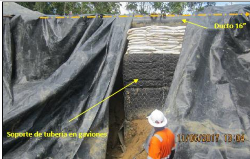
Figura 06: KP 003+400 – Verificación de soporte del ducto de 16" en gaviones, seguimiento realizado por Osinerghmin en el mes de mayo de 2017.
