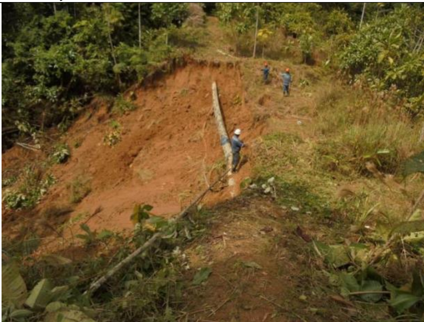
Figura 02: Vista de pista afectada, se aprecia inflexión sobre la pista propia de la topografía.
