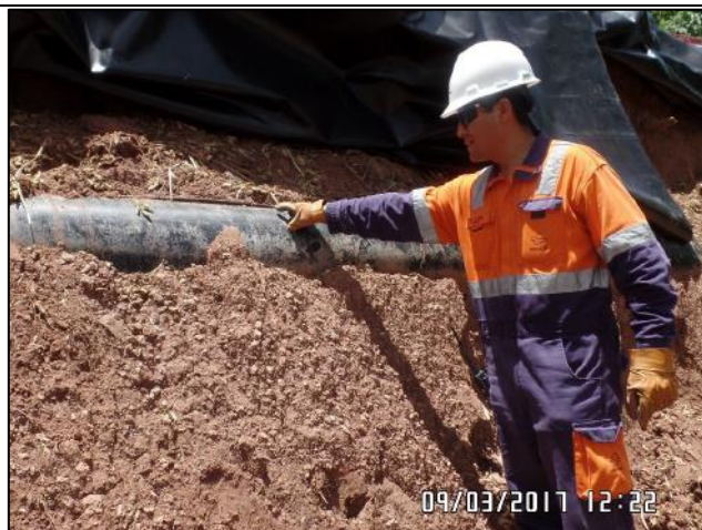
Figura 05: Verificación del ducto parcialmente descubierto. Se visualiza cable de fibra óptica expuesto.
