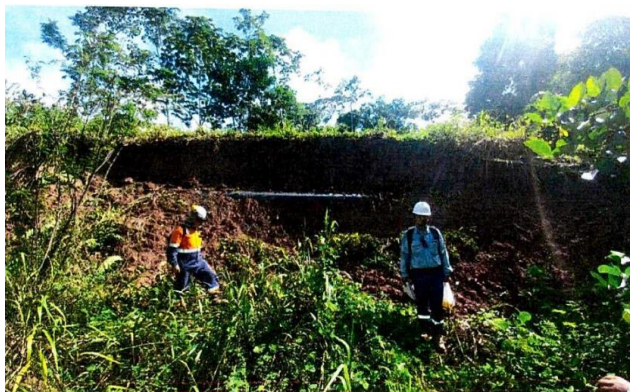
Figura 02: Deslizamiento con escarpe vertical y sobresaturación de agua que expone parcialmente el ducto. (Fuente: Repsol)
