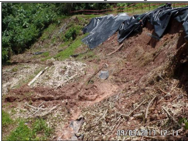
Figura 04: Verificación de trabajos de desbroce manual en la zona del deslizamiento para visualizar posibles daños al ducto.
