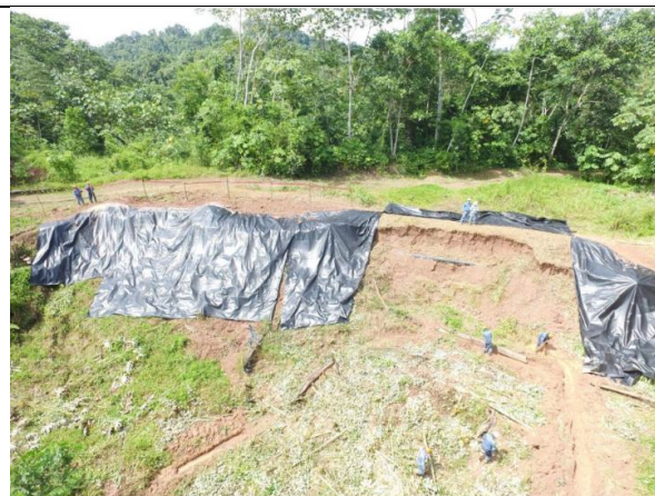
Figura 03: Recubrimiento temporal con geomembrana en la zona del deslizamiento. (Fuente: Repsol)
