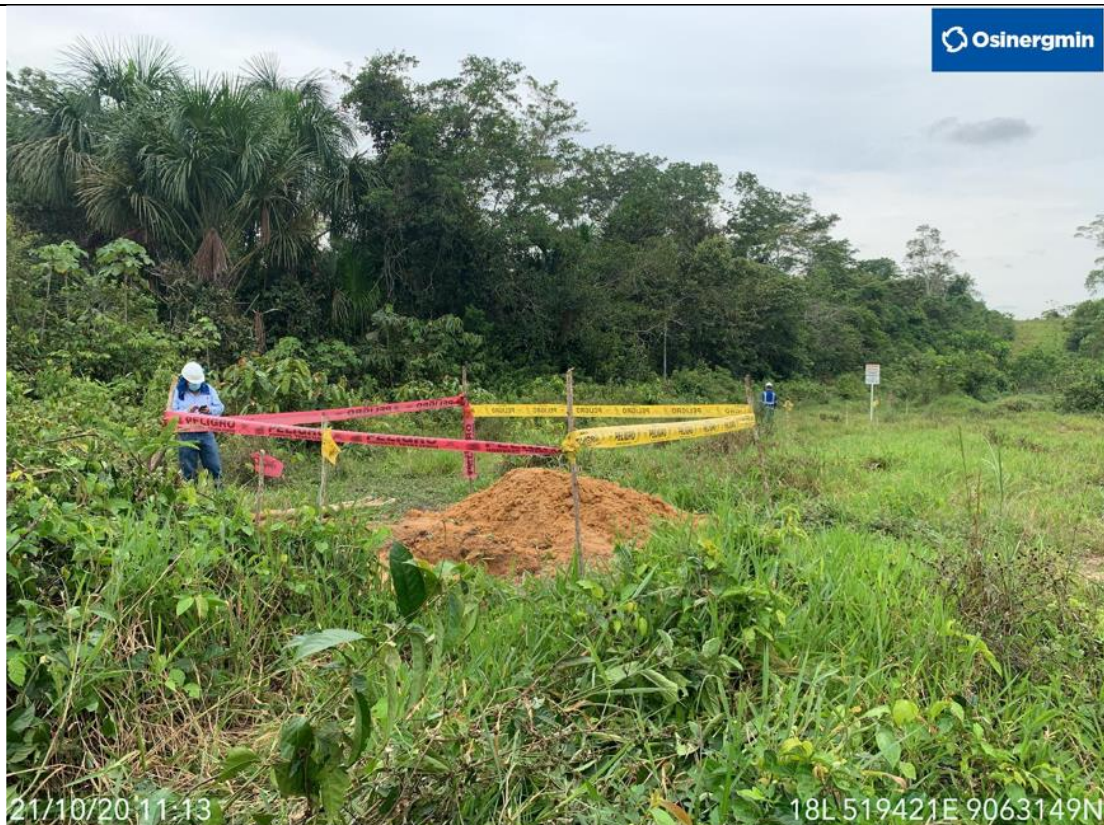
Figura 02: KP 64+000 - Ducto de 4” de LGN del Tramo Estación Neshuya – Planta de Fraccionamiento Condición de Riesgo donde se evidenció que la zona identificada se encontraba señalizada para impedir su ingreso.
