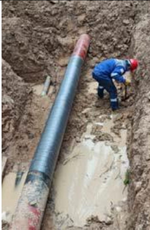
Figura 03: Vista de la sección del ducto reemplazado a la altura de la progresiva KP 16+940 del tramo Planta de Gas – Estación Neshuya.
