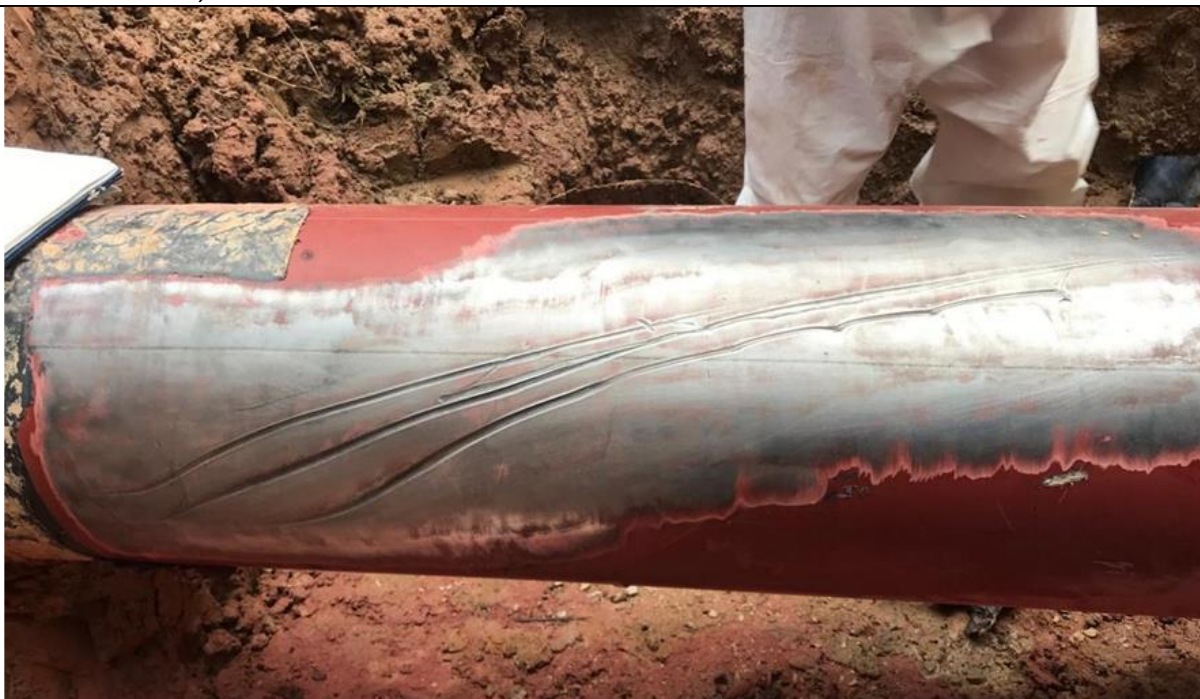
Figura 02: Vista de la condición de riesgo a la altura de la progresiva KP 16+940 del tramo Planta de Gas – Estación Neshuya.
