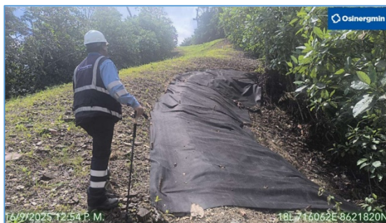
Área 2: KP 76+035. Vista del DDV en zona identificada como riesgo geotécnico.
