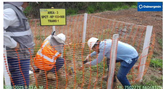
Visita técnica del personal de OCI: Inspeccionando la medición del potencial del sistema de protección catódica (KP 132+970).
