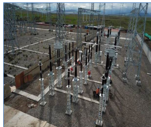
Bahía Subestación Tintaya
