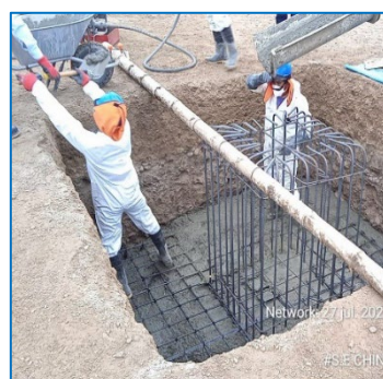
Bases de Estructuras de Patio de Llaves
