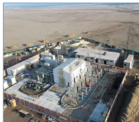
Vista Panorámica de la S.E. Lomitas
