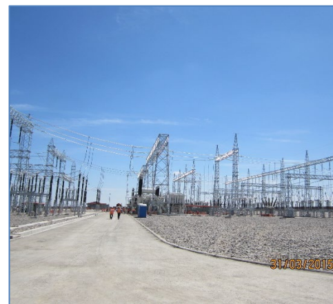
S.E. San José Existente 500/220 kV
