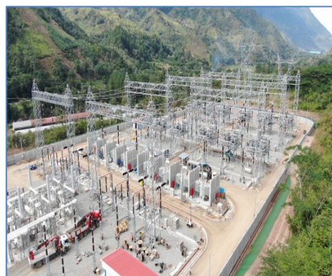
Vista de los bancos de Reactores de Línea Enlace Colcabamba
