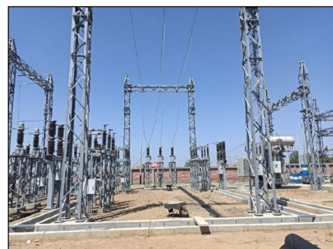
Patio de Llaves de la S.E. Las Lomas
