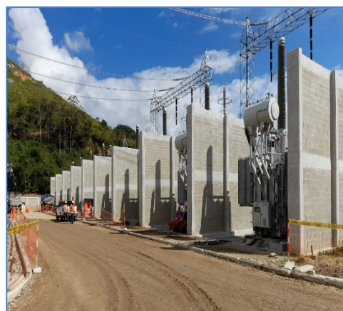
Banco de Autotransformadores Monofásicos 250 MVA c/u - 500/220/33 kV c/u (cuatro unidades)
