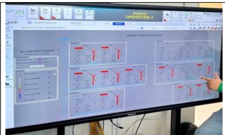
Pruebas de Comisionamiento Aerogeneradores
