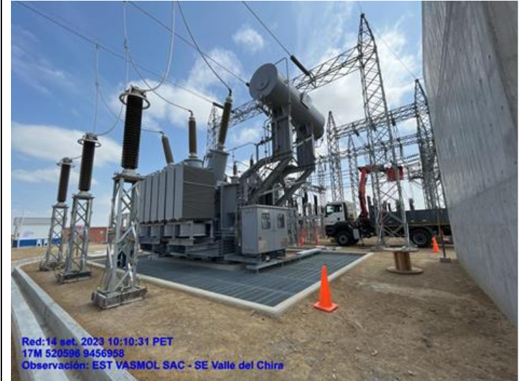
Transformador de Potencia
