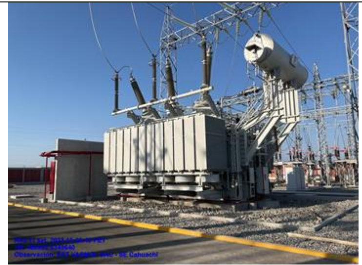
Transformador de Potencia 220/60/10 kV 50/60 MVA ONAN/ONAF HYOSUNG CHINA
