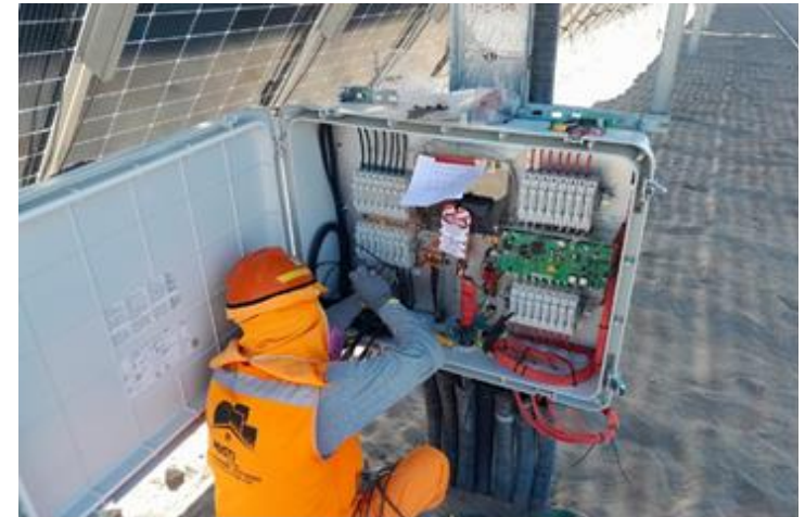
Vista de conexionado de string box
