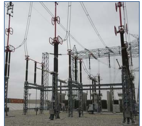
Equipos existentes en la S.E. La Niña 500 kV
