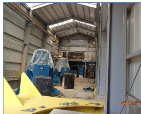
Generadores en la Casa de Máquinas
