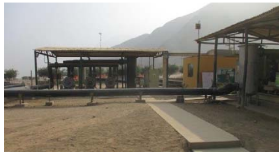
Ilustración 7: Sistema de Compresión y Limpieza de Biogás (C.B. La Gringa V)
