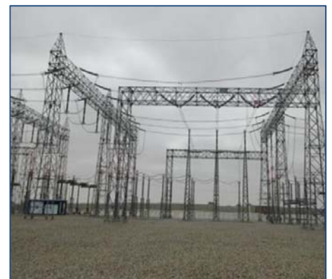
Zona de ubicación de los reactores de barra
