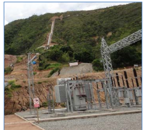
Subestación de salida
