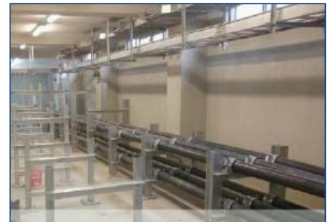
Interior de galería de SE Industriales
