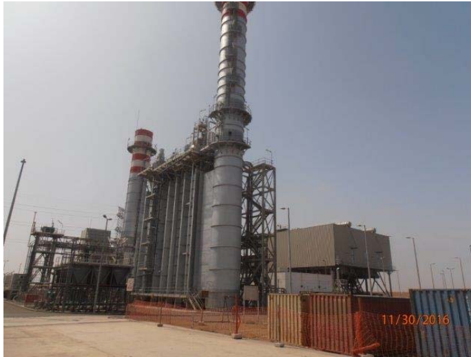
Ilustración 5: C.T. Chilca 2 (Caldera de Recuperación y Aerocondensador)
