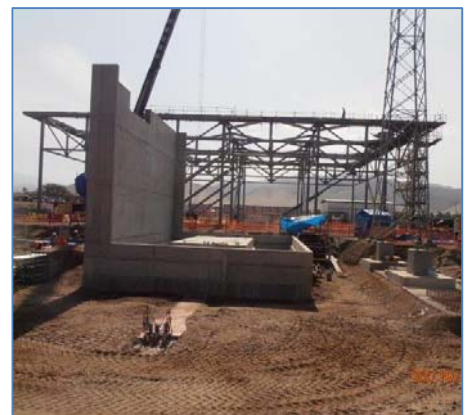
Base del Transformador Principal
