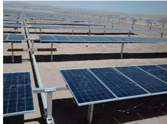
Ilustración 6: Módulos Fotovoltaicos C.S. Moquegua FV
