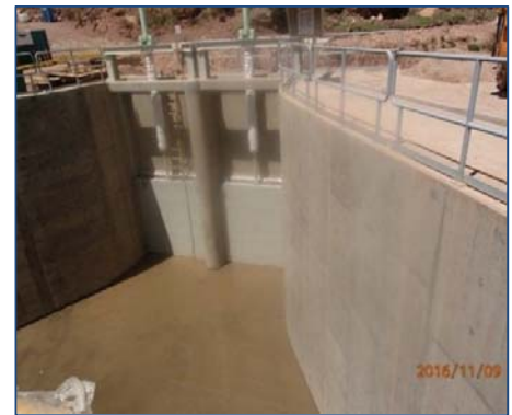
Compuertas Radiales de la Bocatoma
