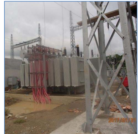
Transformador de 50 MVA – 13,8/60 kV
