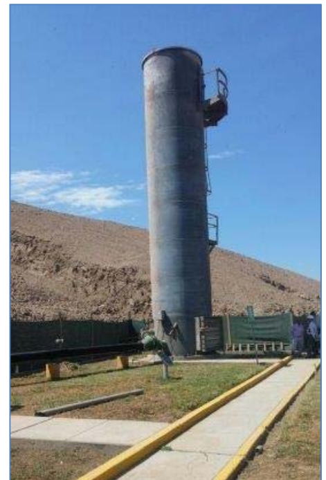
Chimenea de eliminación de CO2
