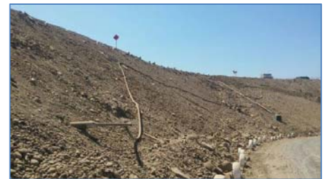
Tuberías de extracción y colectoras de biogás
