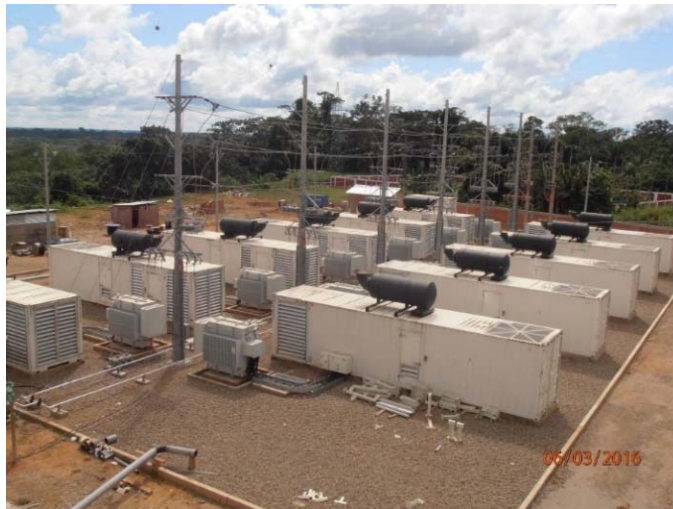
Ilustración 4: Grupos de Generación (C.T. Puerto Maldonado – Reserva Fria)
