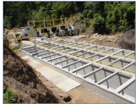
Bocatoma y Desarenador
