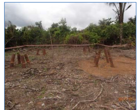
Base para Torres de Línea de Transmisión
