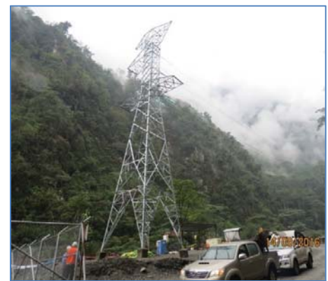
Vista de Torre N° 1 (Anclaje y Stub)
