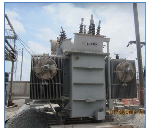
Transformador para la S.E. Chala
