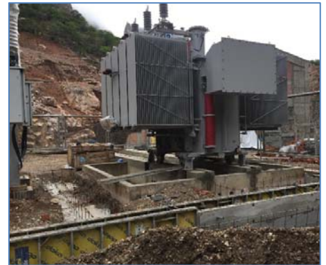
Transformador de potencia
