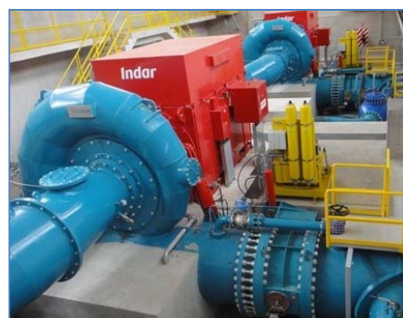
Casa de Máquinas con dos turbinas
