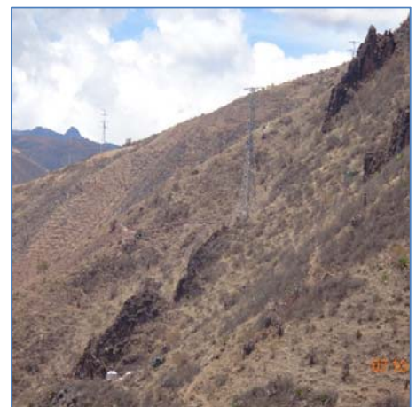
Torres de la Línea de Transmisión
