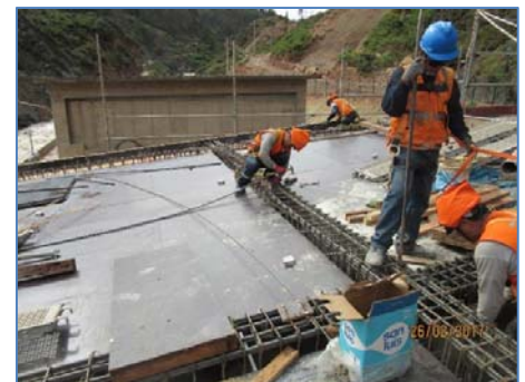
Techo S.E. Marañon
