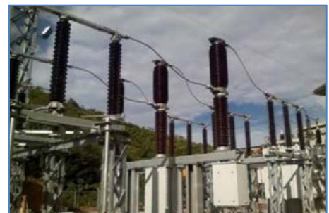
Conexión de equipos AT en la Subestación de salida
