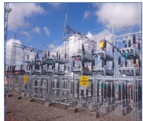
Subestación Puno (Bancos de Compensación Capacitiva)
