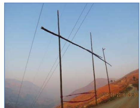
Pórtico para Tendido de Conductores
