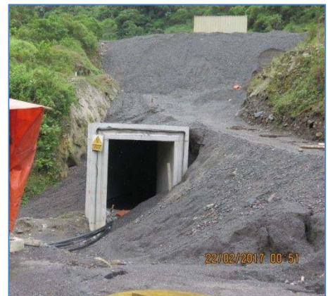
Conducto de descarga para aguas turbinadas
