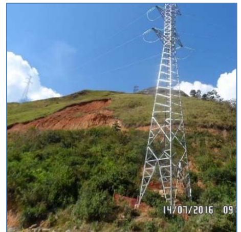
Torre de Línea de Transmisión
