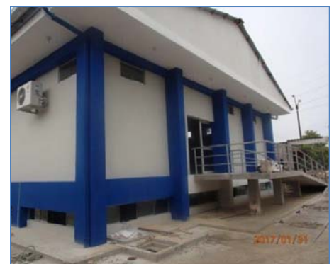
Subestación de Llegada en Electro Oriente
