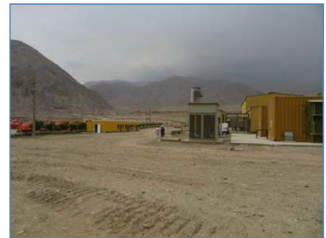
Vista general de la CT Biomasa Huaycoloro
