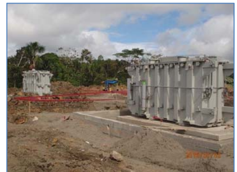
Subestación de Salida – 2 Transformadores instalados
