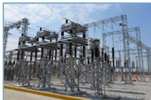
Compensación Reactiva 220 kv-S.E. Piura Oeste
