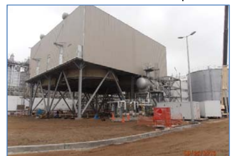
Vista del Aerocondensador
