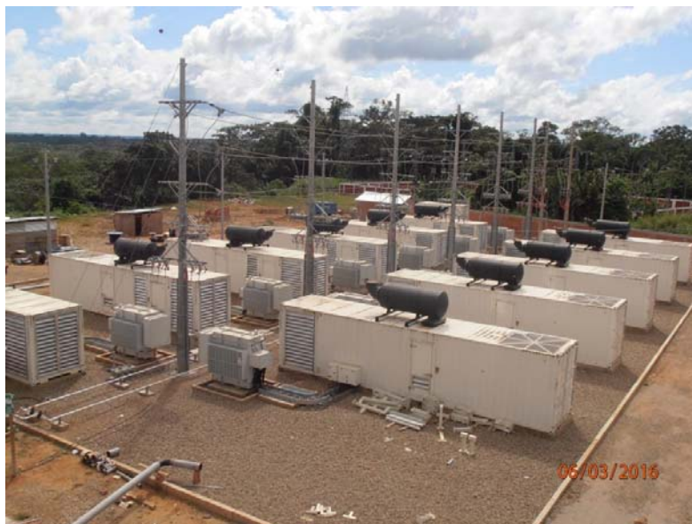
Ilustración 4: Grupos de Generación (C.T. Puerto Maldonado – Reserva Fría)
