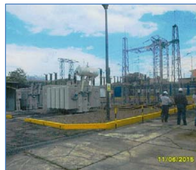
Patio de Llaves S.E. Iquitos Existente
