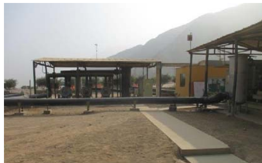
Ilustración 7: Sistema de Compresión y Limpieza de Biogas (C.B. La Gringa V)
