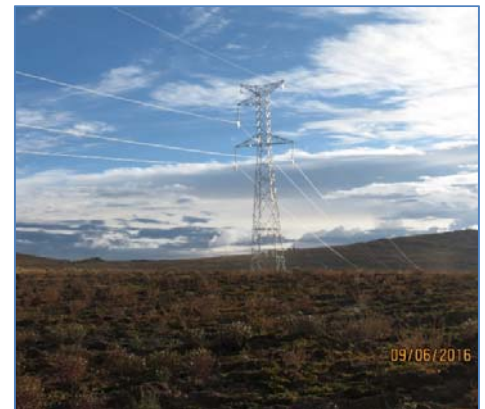
Cable de conductor y de guarda en torre simple terna
