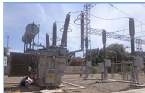
Reactor R-10 - Celda de Conexión en 220 kv-S.E. Talara
