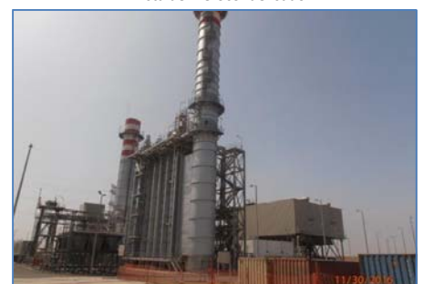
Vista de la CT Chilca 2
