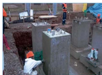
S.E. Quencoro (Pórtico de la Ampliación)
