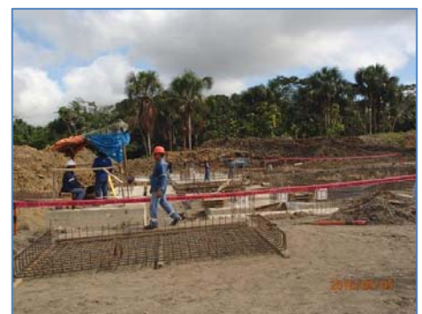
Pórtico de Subestación de Salida
