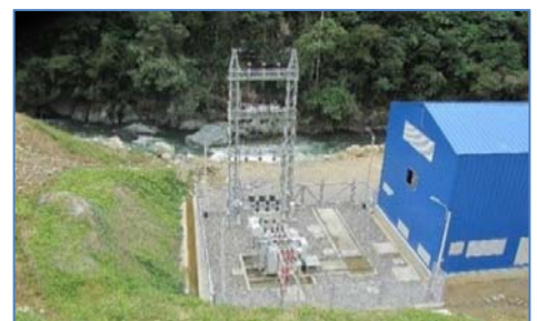
Subestación El Carmen
