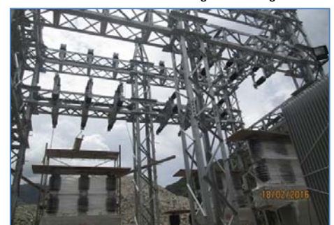
Pórtico de salida de la SE 8 de Agosto
