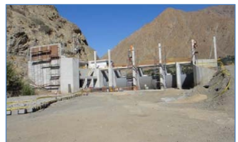
Bocatoma con sus compuertas radiales
