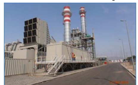
Chimeneas de los Ciclos Simple y Combinado
