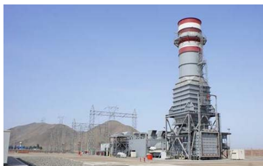
Ilustración 3: Vista Panorámica C.T. Santo Domingo de los Olleros
