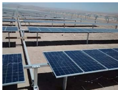
Ilustración 6: Módulos Fotovoltaicos C.S. Moquegua FV
