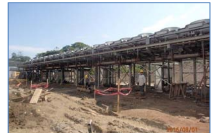
Sistema de Refrigeración
