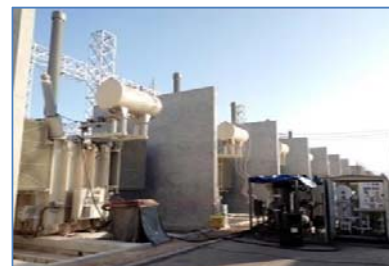
SE Poroma: tratamiento de aceite en reactores
