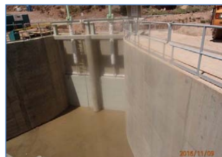
Compuertas Radiales de la Bocatoma
