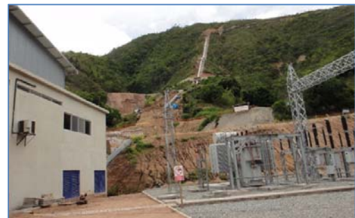
Subestación de salida
