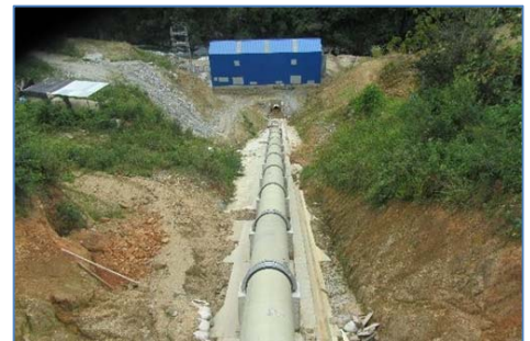
Casa de Máquinas concluida y tubería forzada
