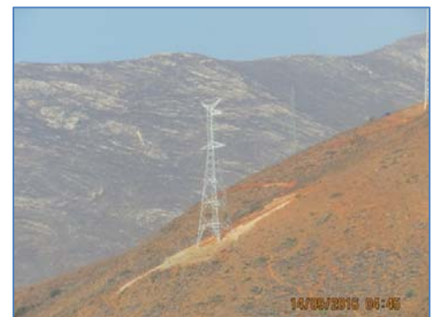
Torre de suspensión en simple terna
