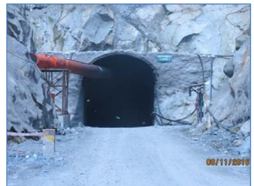
Túnel de acceso a la Casa de Máquinas de la C.H. Ángel I
