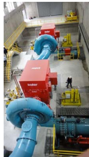
Ilustración 1: Generadores Hidráulicos (C.H. Carpapata III)
