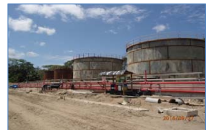
Tanques de Combustible
