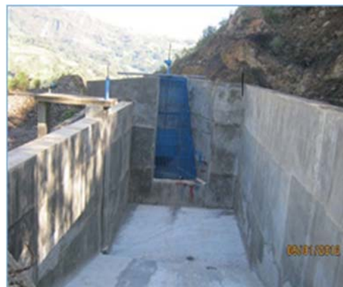
Rejillas de Cámara de Carga
