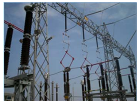
S.E. Chilca Existente
