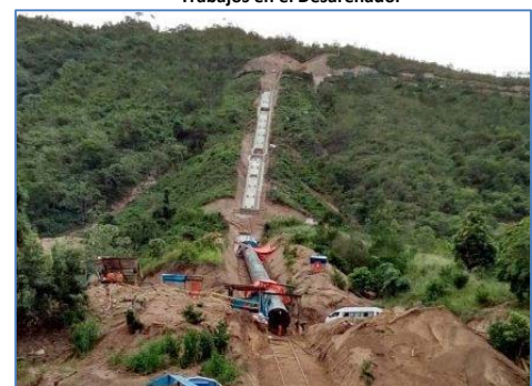
Tubería Forzada – Tramo en Superficie
