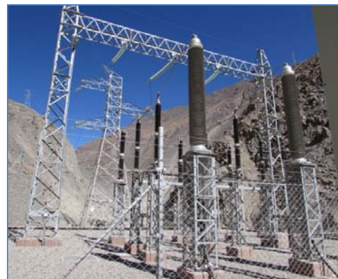
Patio de llaves S.E. Cheves
