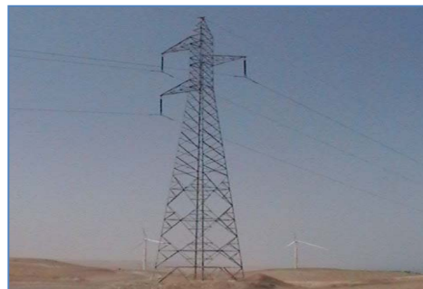
L.T. 220 kV S.E. P.E. Marcona – S.E. Marcona
