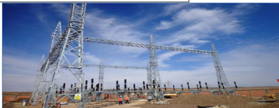
Vista Subestación Marcona
