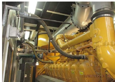
Ilustración 5: Grupo Generador N° 2 (C.B. La Gringa V)
