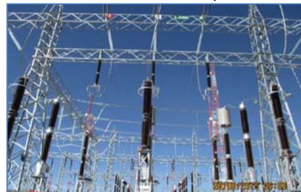
Vista de la S.E. Cotaruse
