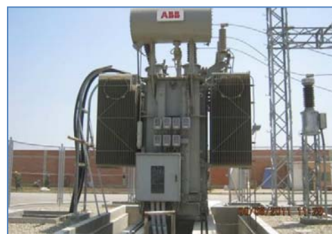
Transformador ABB de 42 MVA 60/13,8 kV
