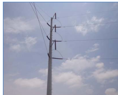
L.T. 220 kV Piura Oeste - Cementos Piura (Poste N° 10)
