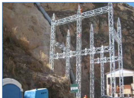
Pórtico de la S.E. Canchayllo
