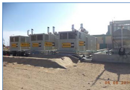
Sistema de Arranque Black Start (3x2,5 MW)
