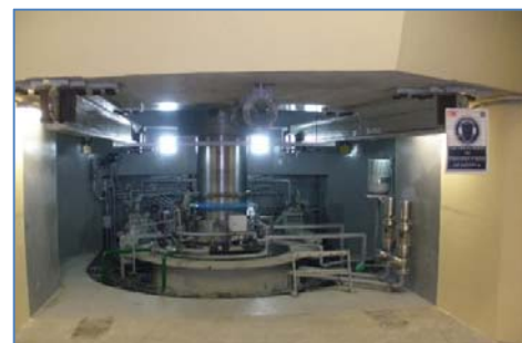
Eje de Acoplamiento Turbina-Generador Eléctrico
