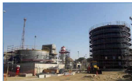
Tanque de transferencia de Diesel B5
