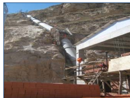
Vista de la Tubería Forzada-Casa de Máquinas
