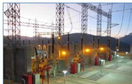
Vista Panorámica de S.E. Abancay
