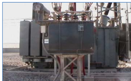
Transformador de 35 MVA – 220 kV
