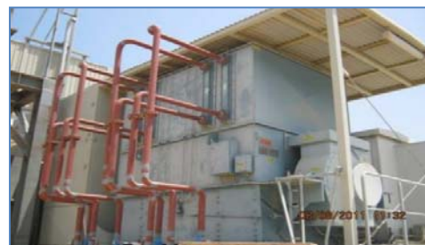
Generador Eléctrico ABB de 30 MW
