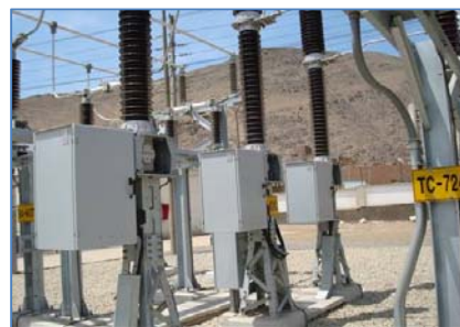
Interruptores instalados S.E. Chavarría
