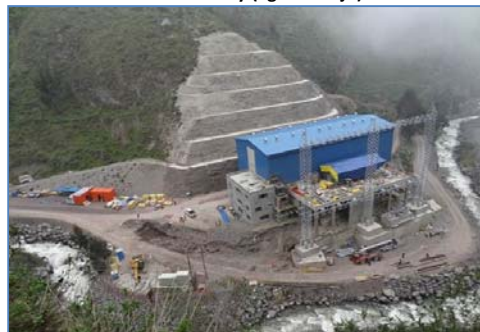
Casa de Máquinas y Subestación
