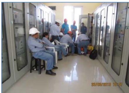
Pruebas End To End en S.E. Piura
