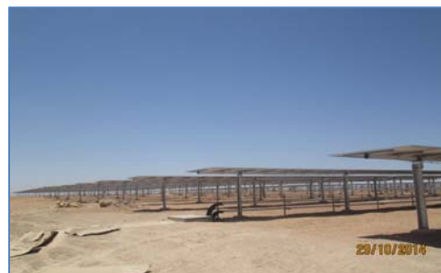
Módulos fotovoltaicos instalados
