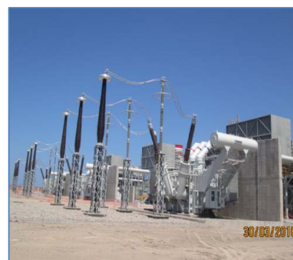
Transformadores de la C.T. Puerto Bravo
