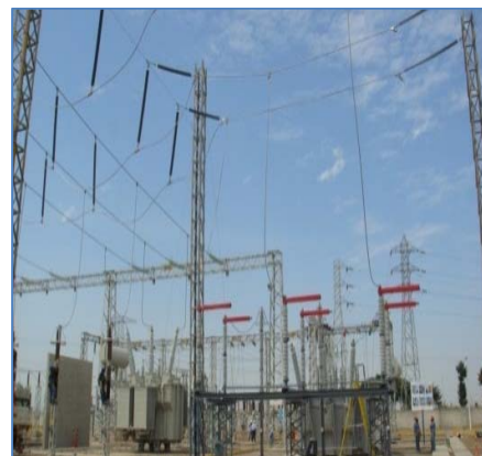
Transformador Provisional en la S.E. Guadalupe
