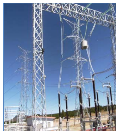
Llegada a la subestación Cajamarca Norte
