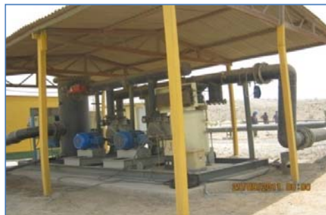
Planta de tratamiento de Biogás
