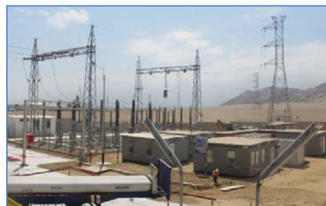
S.E. Éten y L.T. 220 kV S.E. ÉTEN – S.E. Reque
