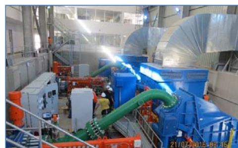
Casa de Máquinas
