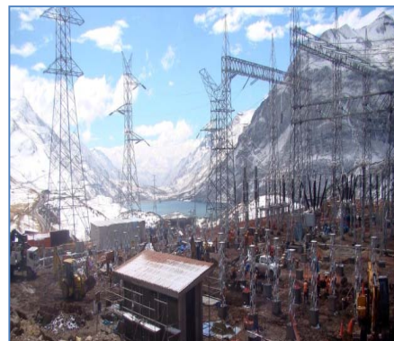
S.E. Pomacocha, bahía 220 kV
