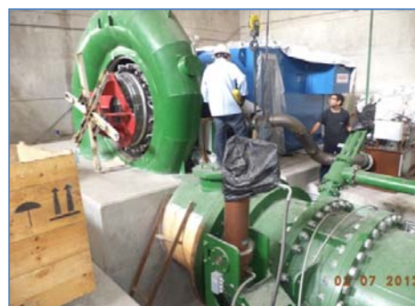
Turbina Rodete N° 2
