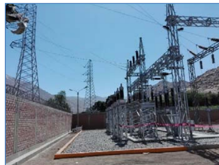
Torre de Llegada a S.E. Andahuasi
