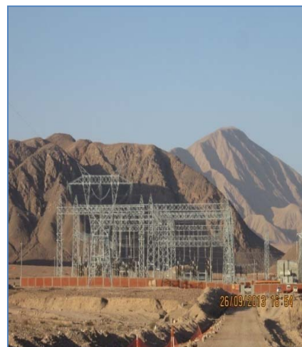
Vista Panorámica Exterior de la S.E. Montalvo
