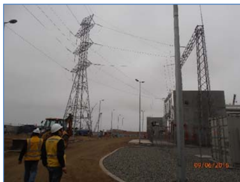
Pórtico y 1ra estructura de la L.T.
