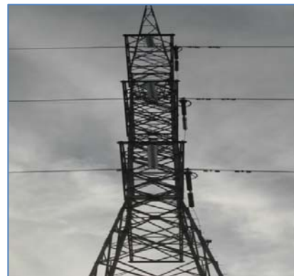
Torre 31N, cadenas de aisladores alineadas
