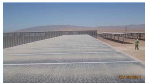
Vista de los módulos instalados
