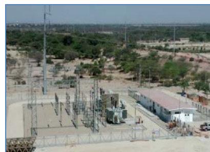
S.E. Cementos Piura
