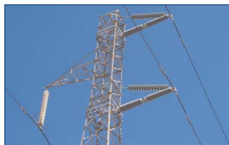
Conjunto de Aisladores Line Post en L-2209
