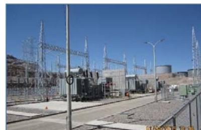
Transformadores 220/34,5 kV-150 MVA (S.E. San Luis)
