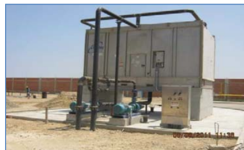
Torre de Enfriamiento de la Planta
