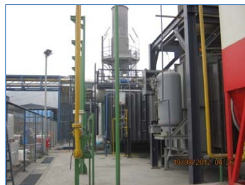
Instalaciones de C.T. Huachipa
