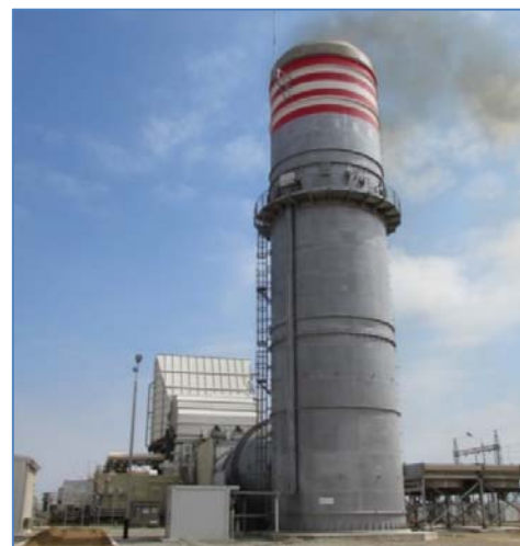
Unidad de generación turbina a gas
