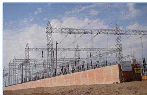
Subestación San José
