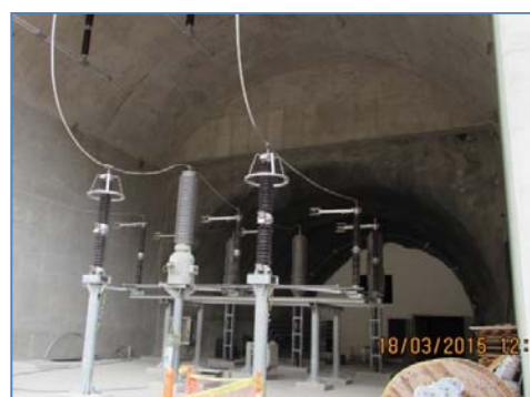
Transformador de potencia en caverna (S.E. Quitaracsa)
