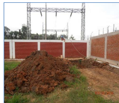
Subestación Puerto Maldonado de Electro Sur Este
