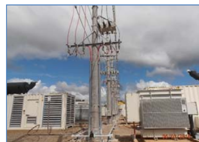
Transformador de distribución y sistema de barras
