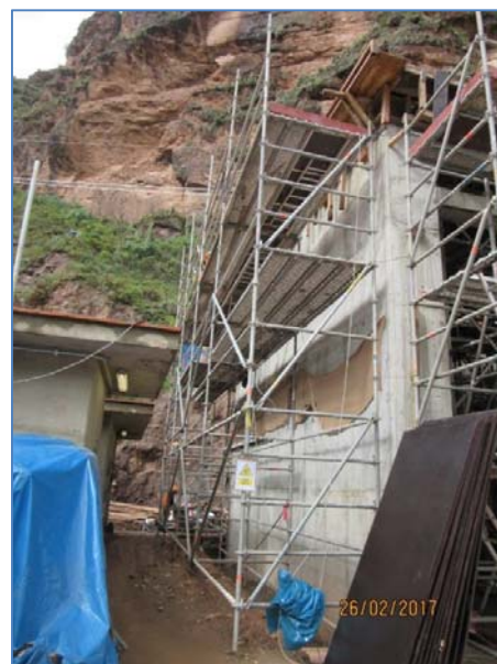
Vista lateral S.E. Marañón
