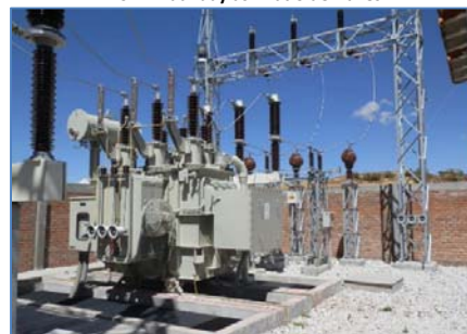
Subestación Chilcayoc-Patio de Llaves
