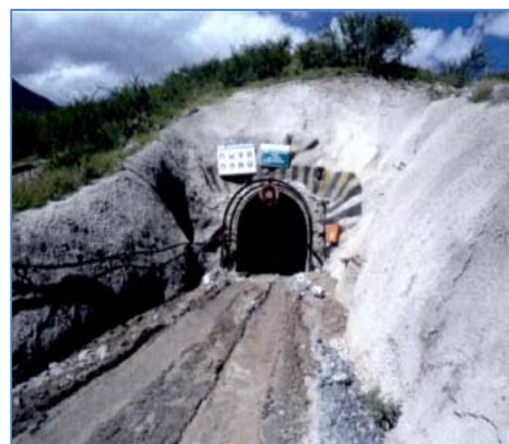
Túnel Principal Portal Salida, Tubería Baja Presión
