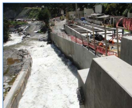
Canal de Descarga y Desarenador
