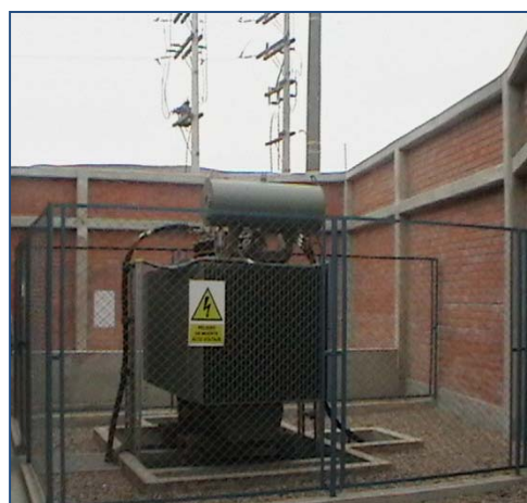
Transformador de Potencia
