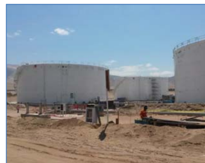
Tanques de almacenamiento de Combustible
