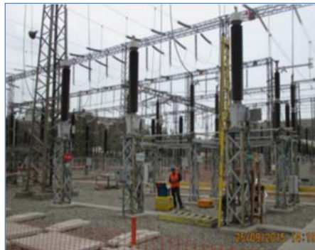
Pruebas SAT en Equipos Primarios (S.E. Ventanilla)
