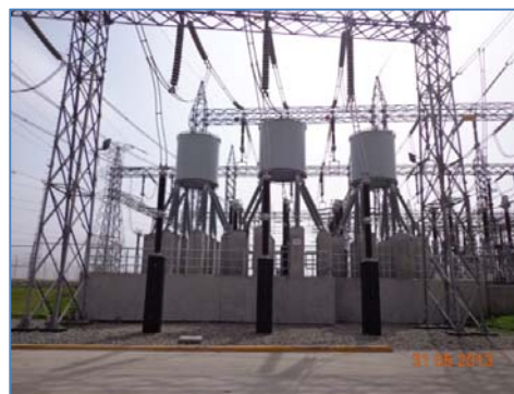
Reactor Serie entre las barras de 220 kv
