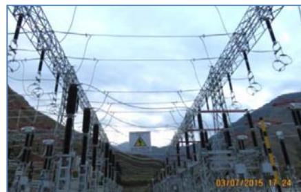
Vista de la S.E. Suriray
