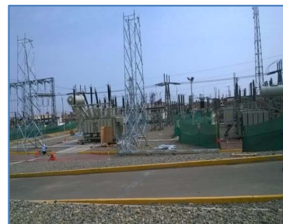
Autotransformador S.E. Trujillo
