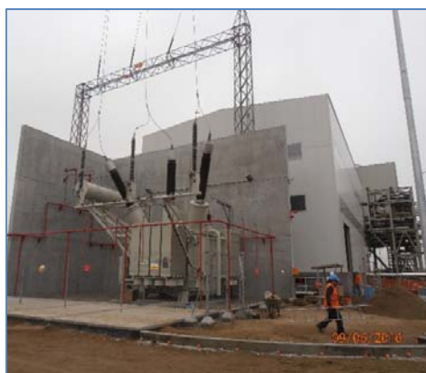
Transformador de potencia asociada a la TV
