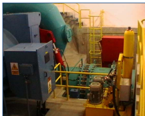
Turbina y Generador
