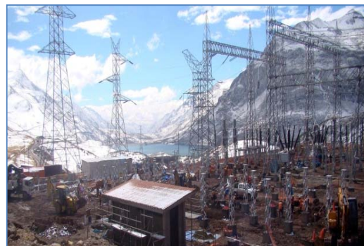
Vista de la S.E. Pomacocha
