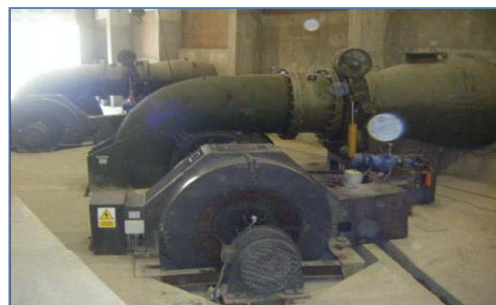
Turbina y Generador del Grupo 3
