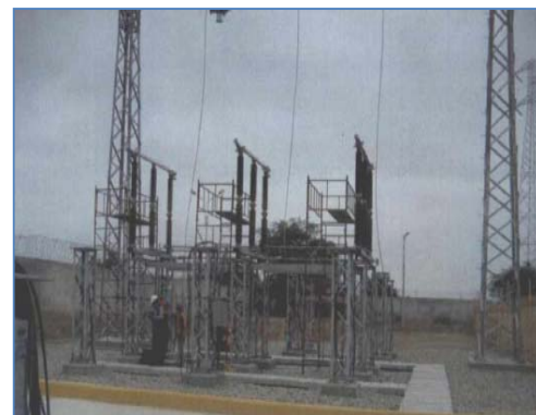
Pruebas Eléctricas al seccionador de Línea
