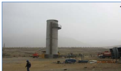
Quemador de Biogás
