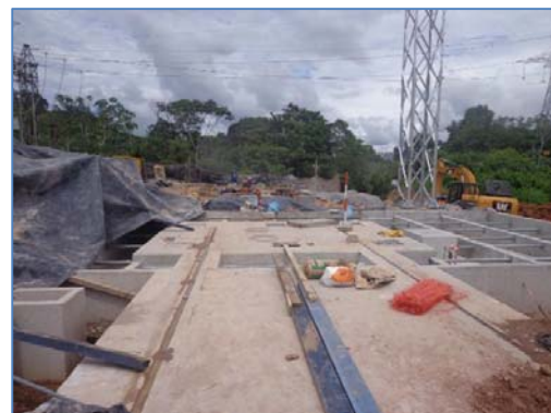
S.E. Aguaytía - Patio 220 kV
