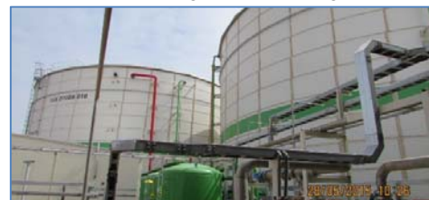
Tanques de almacenamiento de agua
