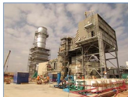
Turbogenerador y equipos auxiliares
