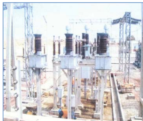
Celda 66 kV S.E. Paramonga Nueva
