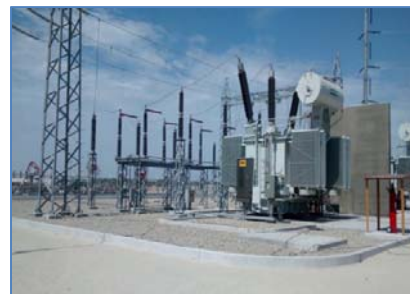
Transformador de Potencia 220/6,3 kV - 30/37,5 MVA
