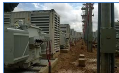
Grupos Electrógenos CAT Instalados (25 de 1,825 MW)
