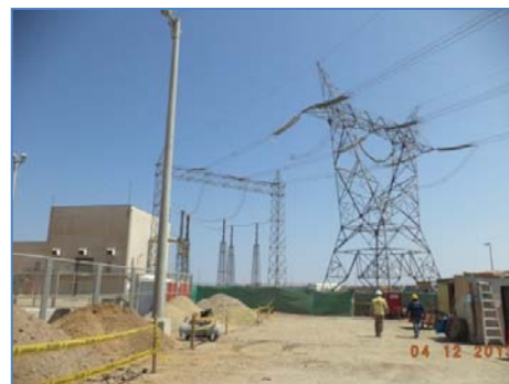
Pórtico de Salida y Subestación GIS 500 kV
