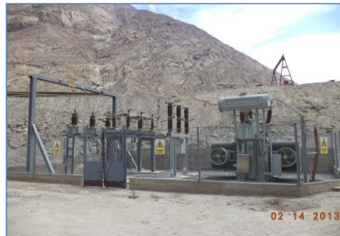
Subestación Eléctrica de la C.H. Yanapampa
