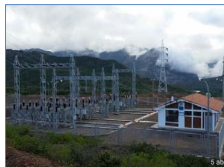
Subestación. Aguas Calientes
