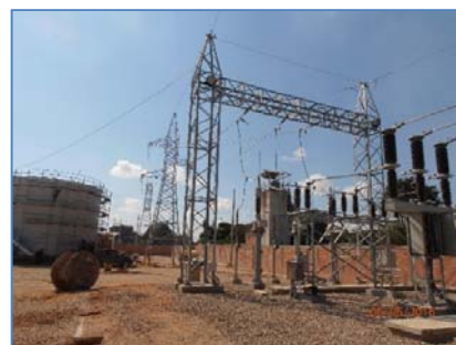
Subestación de Salida en 60 kV C.T. Pucallpa
