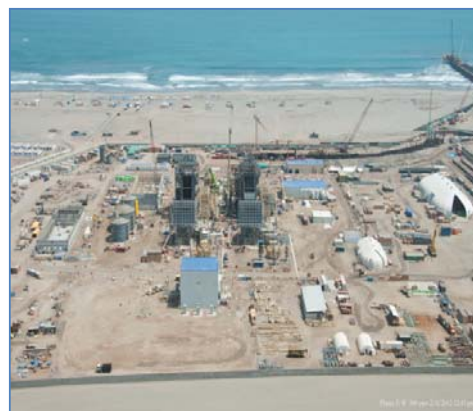
Vista de Frente de la Central
