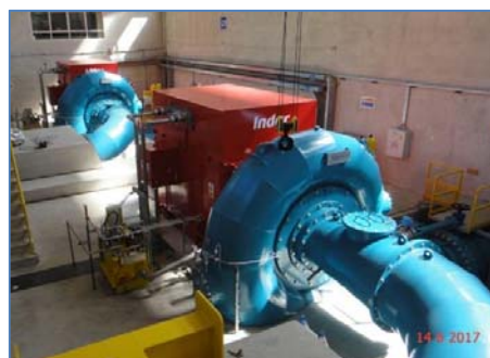
Casa de Máquinas con dos Turbinas Francis
