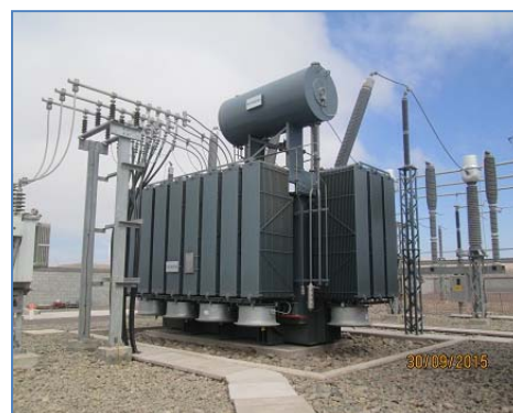
Transformador de Potencia 100 MVA
