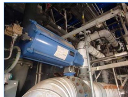
Instalaciones del Grupo N° 1
