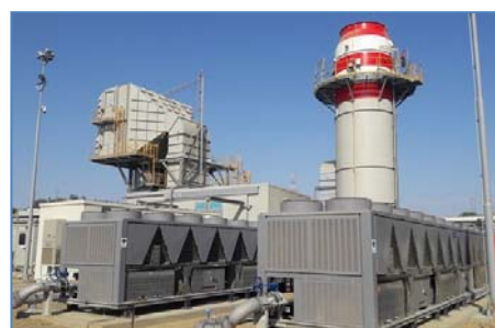
Chillers del Sistema de Enfriamiento
