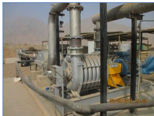
Planta de tratamiento de biogás
