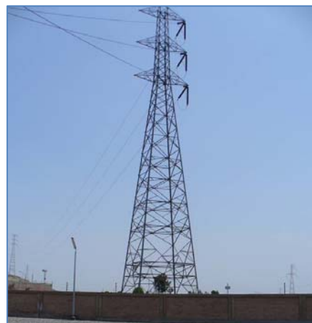
Torre N° 1 S.E. Paramonga Nueva
