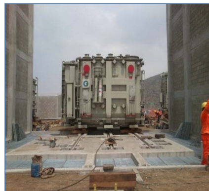
Transformador de 250 MVA (S.E. Trujillo)
