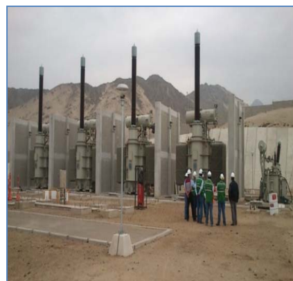
Reactores de 40 MVAR (S.E. Trujillo)
