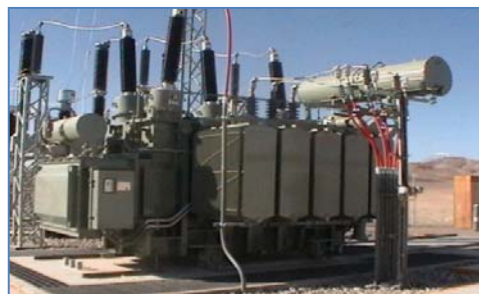
Transformador de Potencia 20 MVA, 23/138 kV
