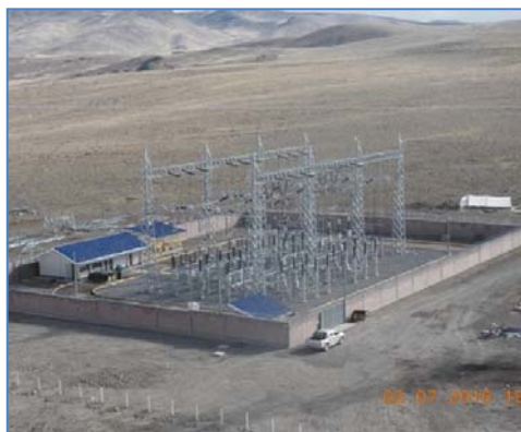
Vista de la SE Talta
