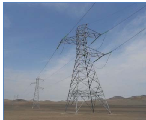
L.T. 220 kV S.E. Cheves-S.E. Huacho
