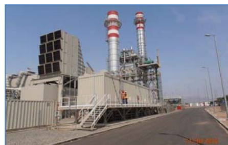
Chimeneas de los Ciclos Simple y Combinado
