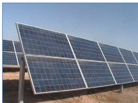
Módulos Solares Instalados
