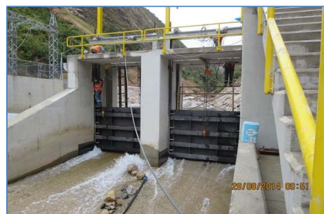
Compuertas del barraje móvil
