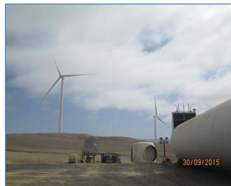
Vista de Aerogeneradores Instalados
