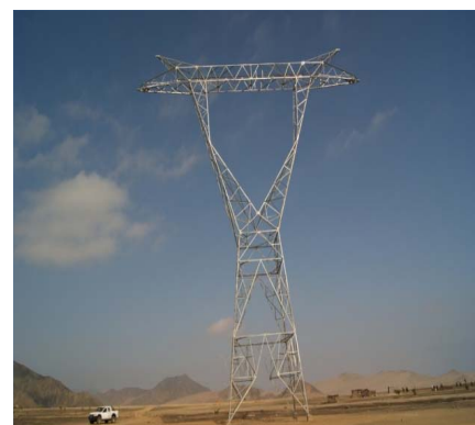
Torre Autosostenida 500 kV
