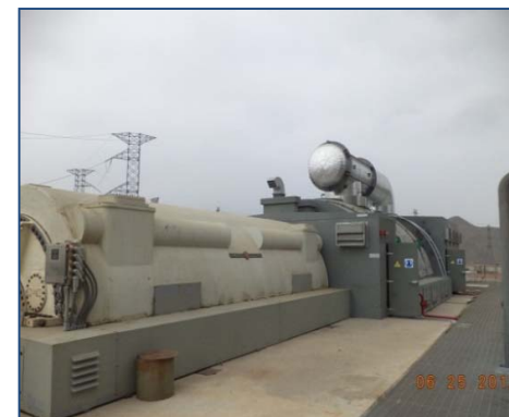
Turbina de Vapor
