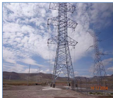
Torre N° 01 L.T. 220 kV Cotaruse-Las Bambas
