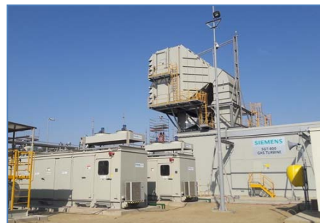
TG6 (Turbina – Generador Siemens)
