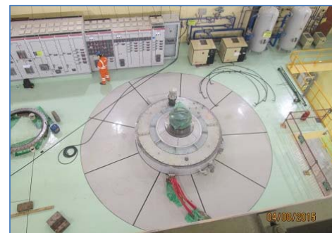
Tapa de Turbina
