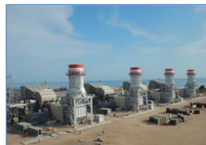
Turbinas y Generadores 1, 2, 3 y 4
