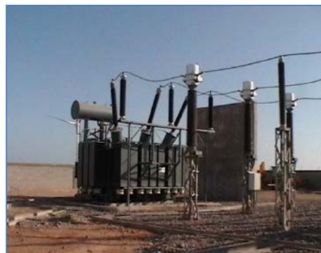
Transformador de Potencia de 35 MVA (20/220 kV)
