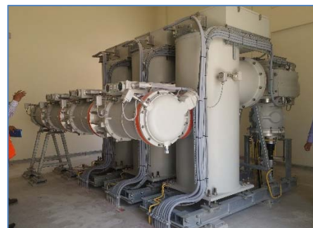
Subestación GIS en 60 kV
