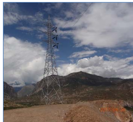
Torre de la Línea de Transmisión
