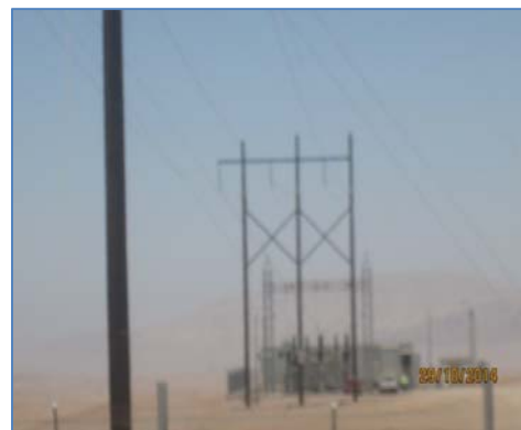
L.T. 22,9 Moquegua FV - S.E. Panamericana Solar
