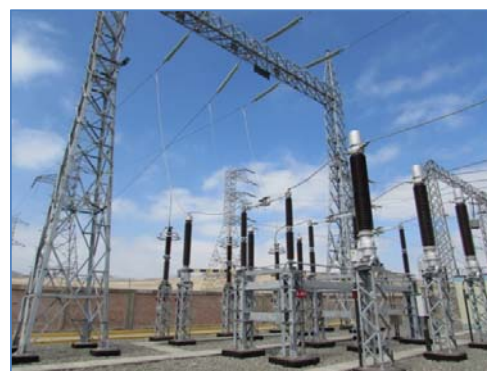
Celda de Llegada en S.E. Huacho
