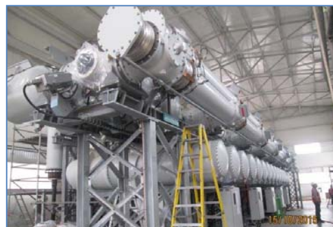
Subestación GIS - C.T. Puerto Bravo
