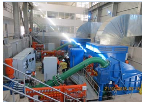
Casa de Máquinas
