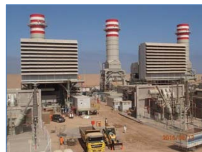
Vista de los turbogeneradores
