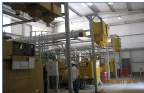
Grupos de Generación 3 x 1,6 MW
