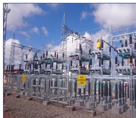
Subestación Puno (Bancos de Compensación Capacitiva)
