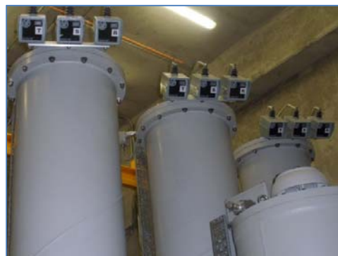
Circuitos de Salida en 138 kV
