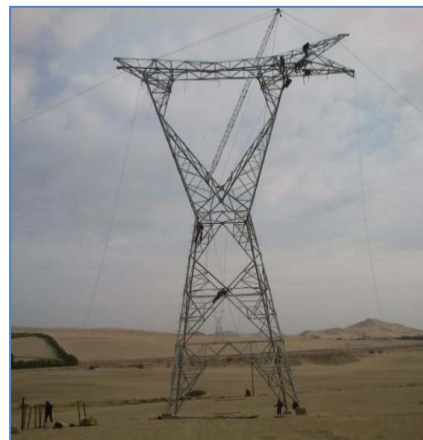
Torre Autosoportada 500 kV
