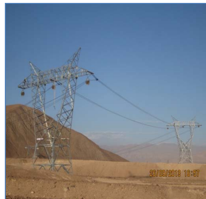
L.T. 220 kV Montalvo - Moquegua
