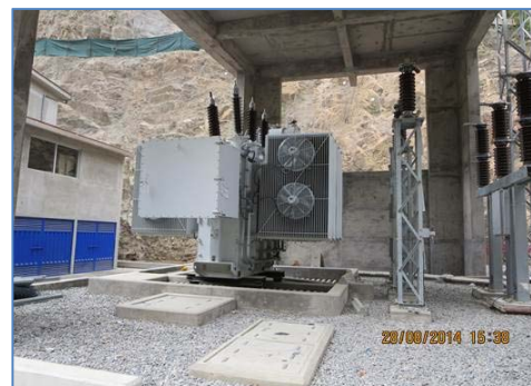
Vista del Transformador
