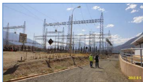
S.E. Kiman Ayllu (220 kV)
