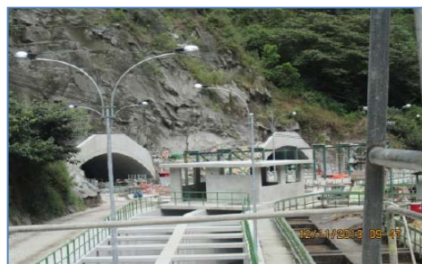
Vista de los Desarenadores
