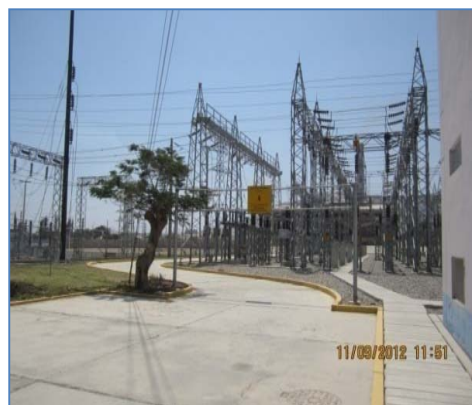
Patio de Llaves 60 kv- S.E.Independencia
