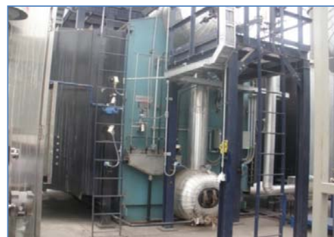
Caldera de Recuperación de calor
