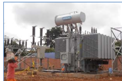
Transformador de Potencia de 50 MVA (22,9/60 kV)
