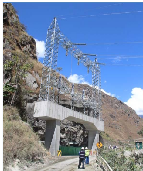
Pórtico 220 kV L-20149 Santa Teresa-Suriray
