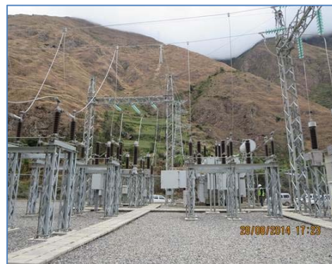
Vista Pórticos S.E. Runatullo III
