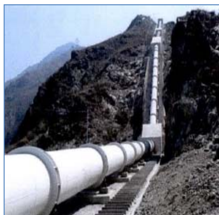
Tubería Forzada – C.H. Huasahuasi I
