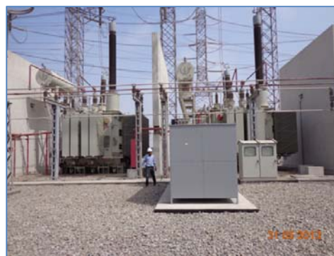
Resistencia neutro Autotransformador. 500/220 kV S.E. Chilca
