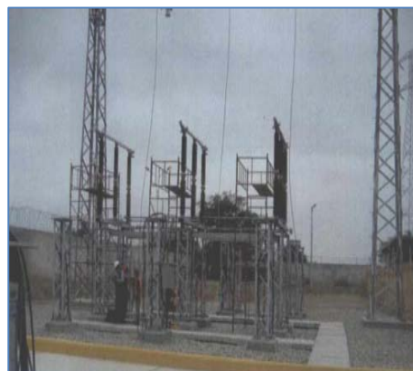
Pruebas eléctricas al seccionador de línea
