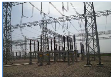
Patio de Llaves S.E. Chilca
