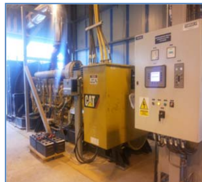
Generador Diesel N° 1
