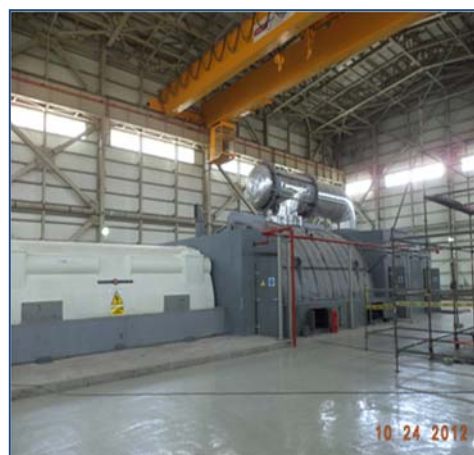
Unidad de Generación (Turbina a vapor)
