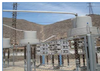
Banco de Condensadores S.E. Chavarría
