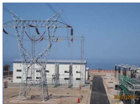
Patio de Llaves y Subestación Puerto Bravo
