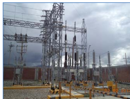
S.E. Andahuaylas - Patio de Llaves
