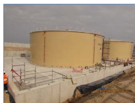
Tanques de almacenamiento de combustible Diésel B5
