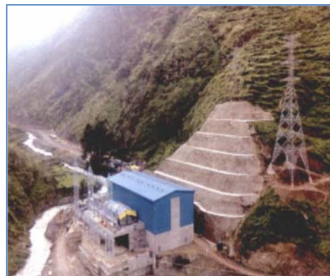
S.E. Huanza y Torre 409A (interconexión)
