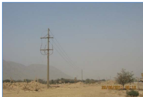
Línea de subtransmisión 22,9 kV
