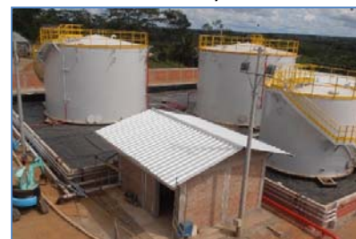
Tanques de almacenamiento de combustible
