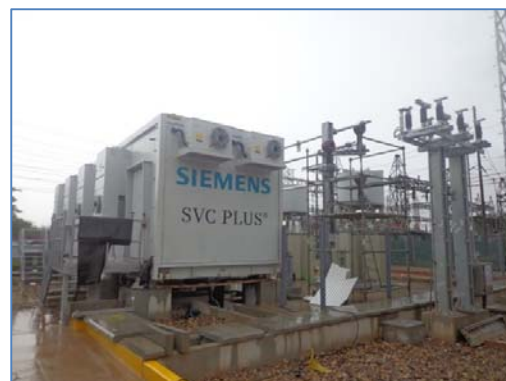
S.E. Pucallpa (SVC) - Patio SVC
