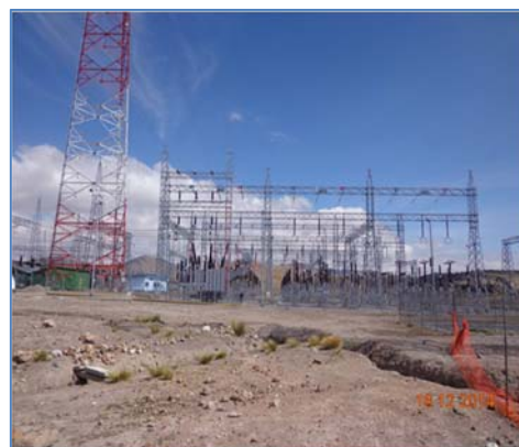
Patio de Llaves 220 kV S.E. Cotaruse
