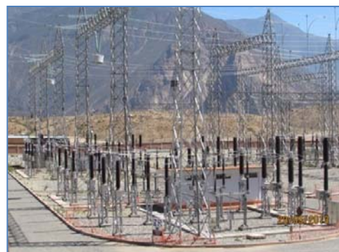
Celda de llegada en S.E. Kiman Ayllu
