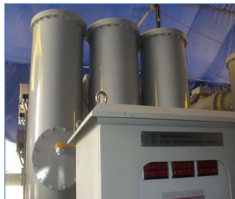
Equipamiento de la S.E. GIS Huanza
