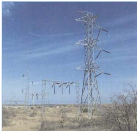
Vista de Línea de Transmisión L-2161
