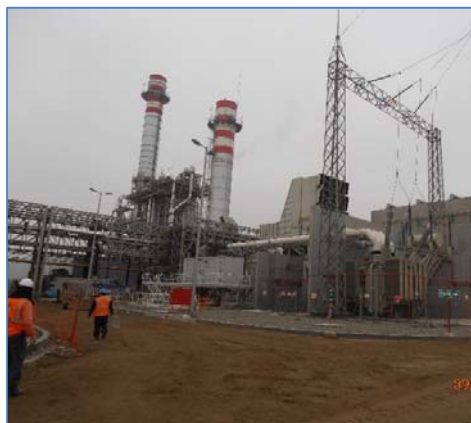
Transformador de potencia asociada a la TG
