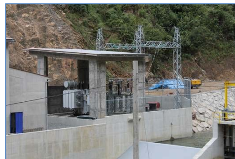
Vista de la S.E. Runatullo II
