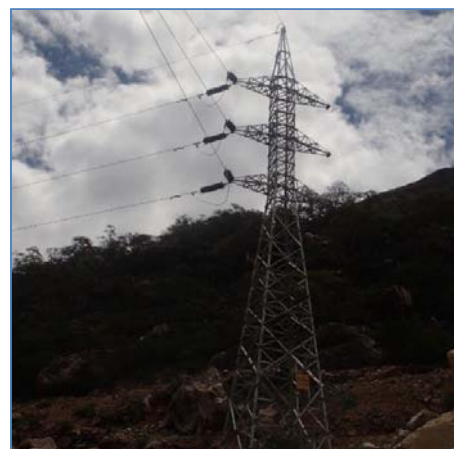
Torre de la Línea de Transmisión
