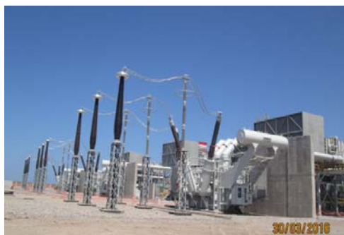
Transformadores de Potencia
