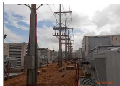
Sistema de Barras en 22,9 kV
