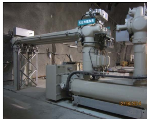
Subestación sistema GIS, en caverna
