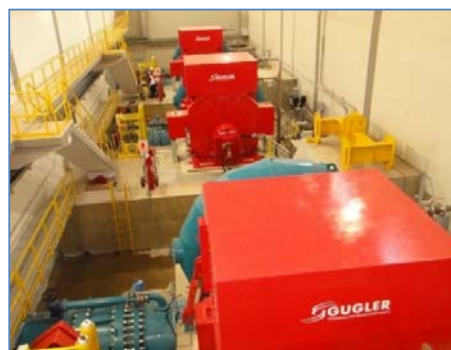
Sala de Máquinas (3 turbinas de 6,56 MW)
