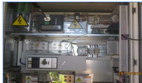
Vista del conexionado del inversor
