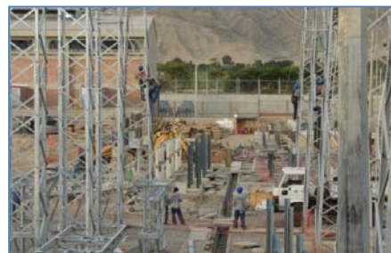
Ampliación S.E. Independencia 60 kV
