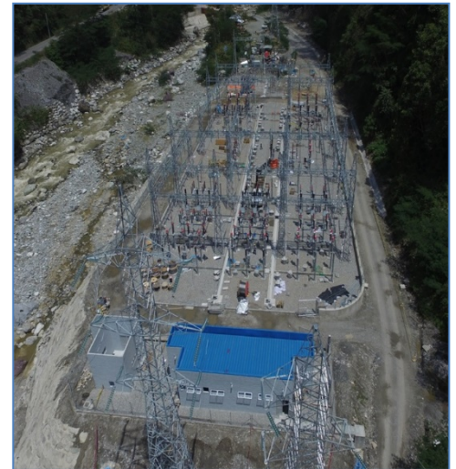
Subestación La Virgen 138 kV de doble barra
