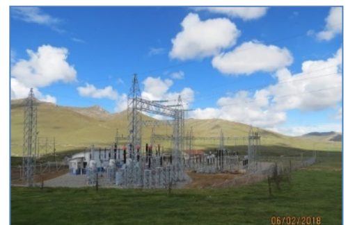
Subestación Caripa 138 kV
