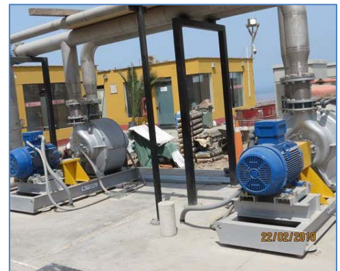
Electrobombas de succión – Estación de compresión
