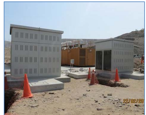
Vista de transformadores 0,48/10/20 kV – 1,5 MVA
