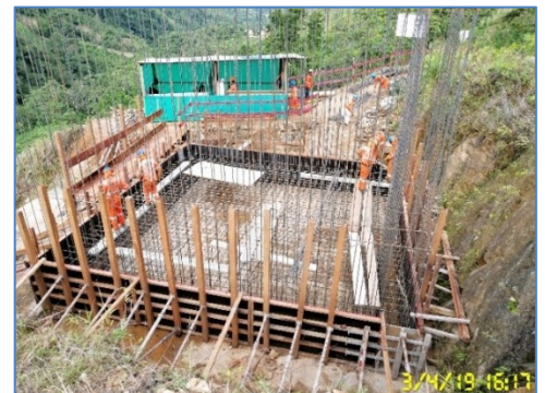
Cámara de Válvulas
