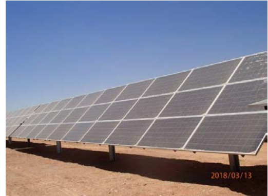
Ilustración 5: Módulos Fotovoltaicos (C.S. Intipampa)
