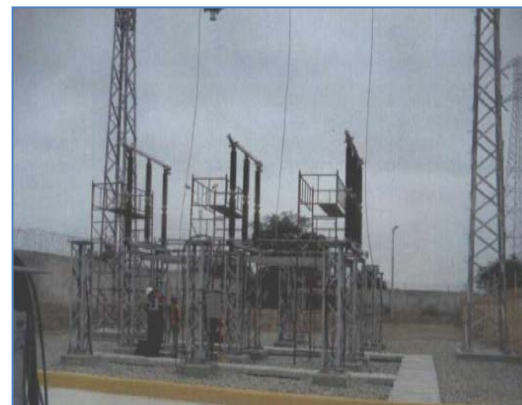
Pruebas Eléctricas al seccionador de Línea
