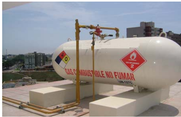
Tanque estacionario de GLP ubicado en el techo de un edificio.
