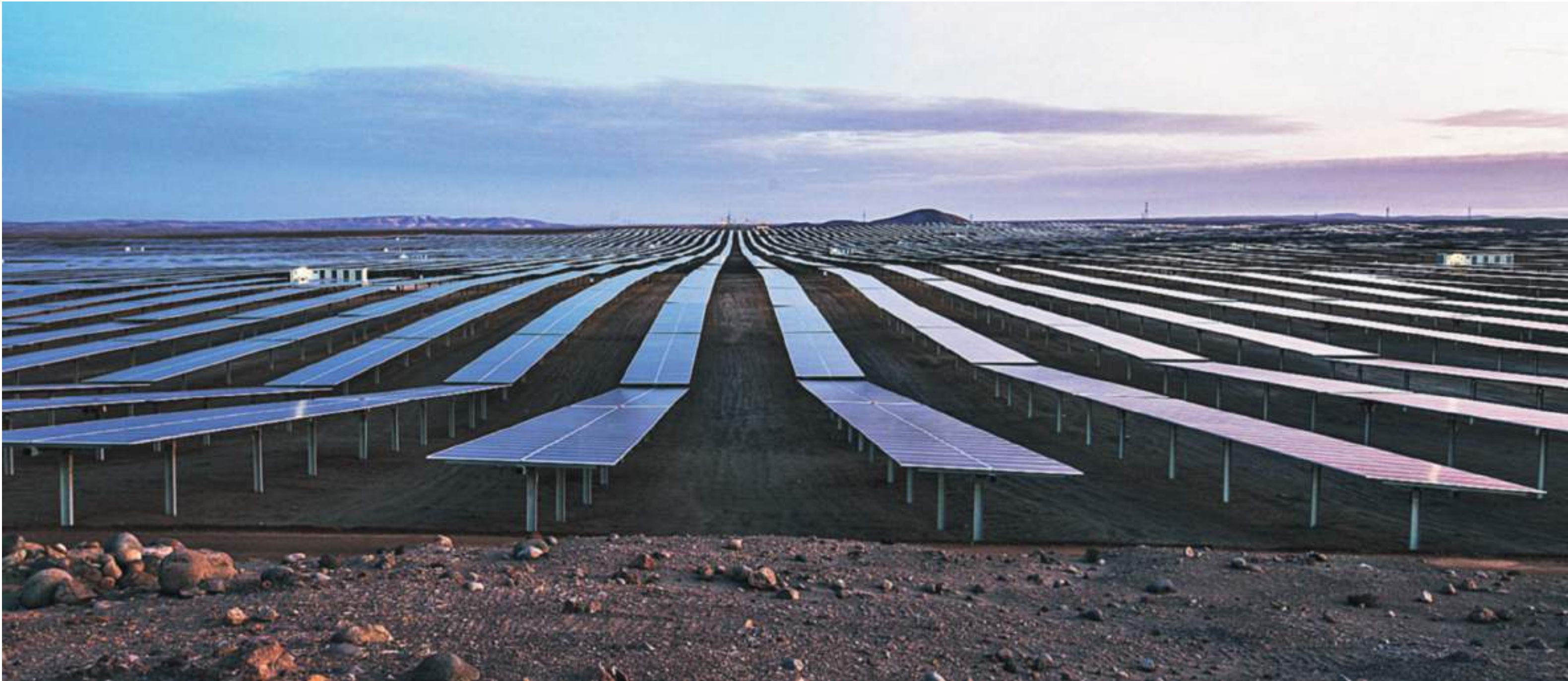
Vista panorámica de la Central Solar Rubí (Moquegua). Foto: Enel Perú.
