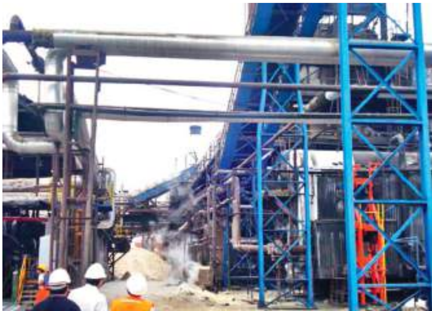
Central de Biomasa Cogeneración Paramonga I (Lima). Foto: Osinergmin.
