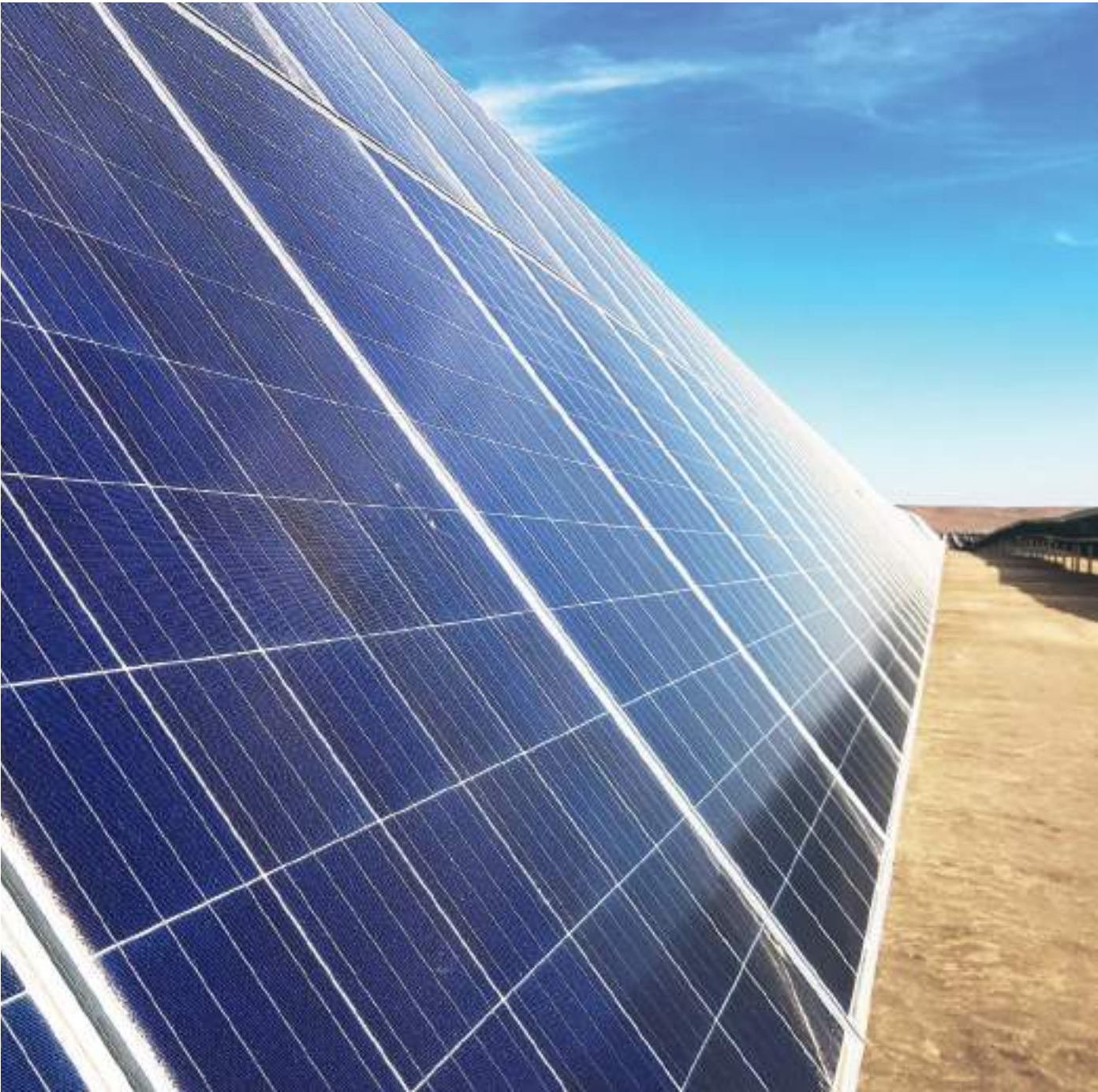
Panel solar de Central Solar Rubí (Moquegua). Foto: Osinergmin.
