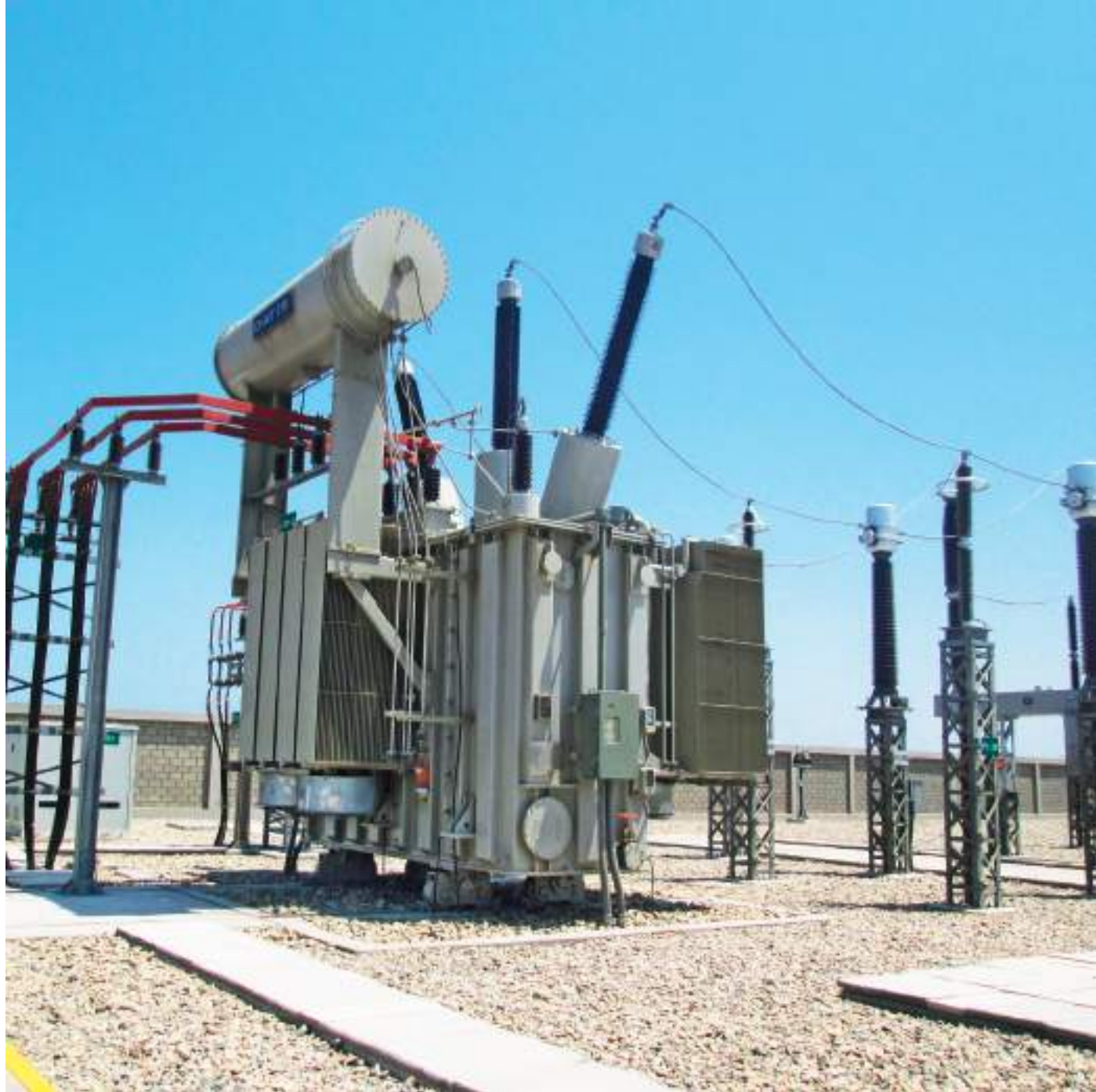
Transformador de potencia de la Central Eólica Cupisnique (La Libertad). Foto: Osinergmin.
