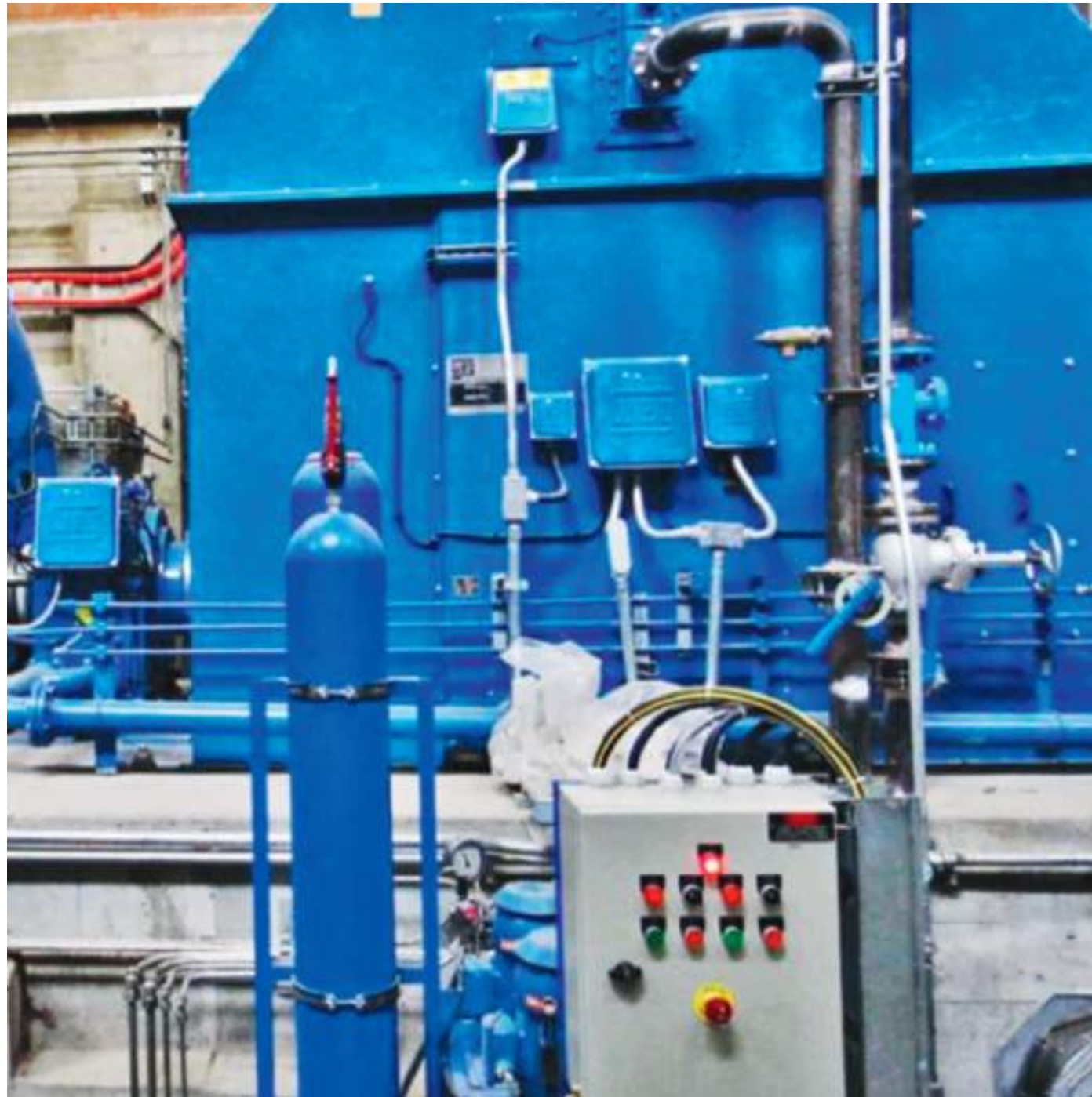
Generador y turbina de la Central Hidroeléctrica Potrero (Cajamarca). Foto: Osinergmin.
