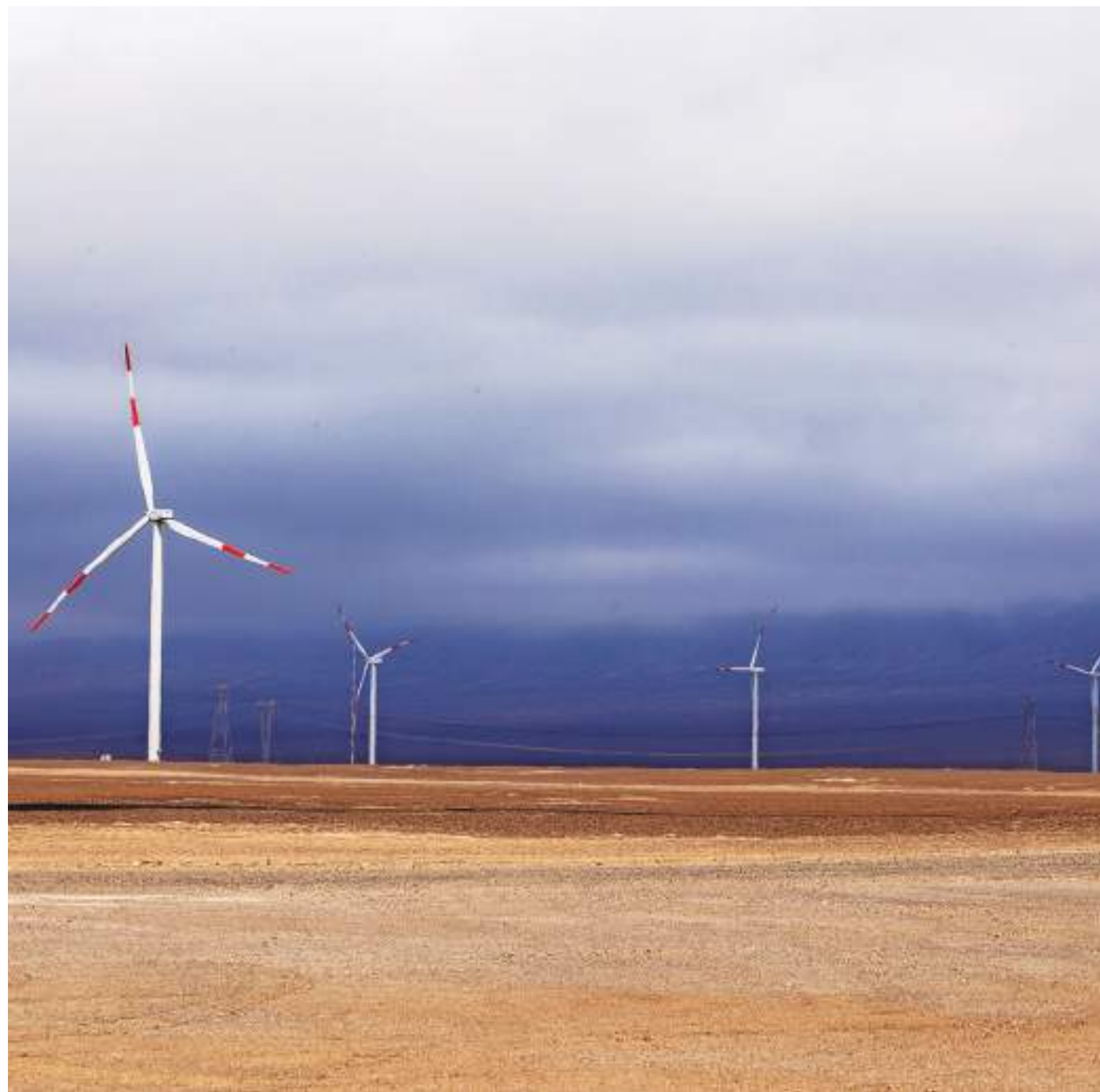
Turbinas eólicas en Nazca (Ica). Foto: Enel Perú.
