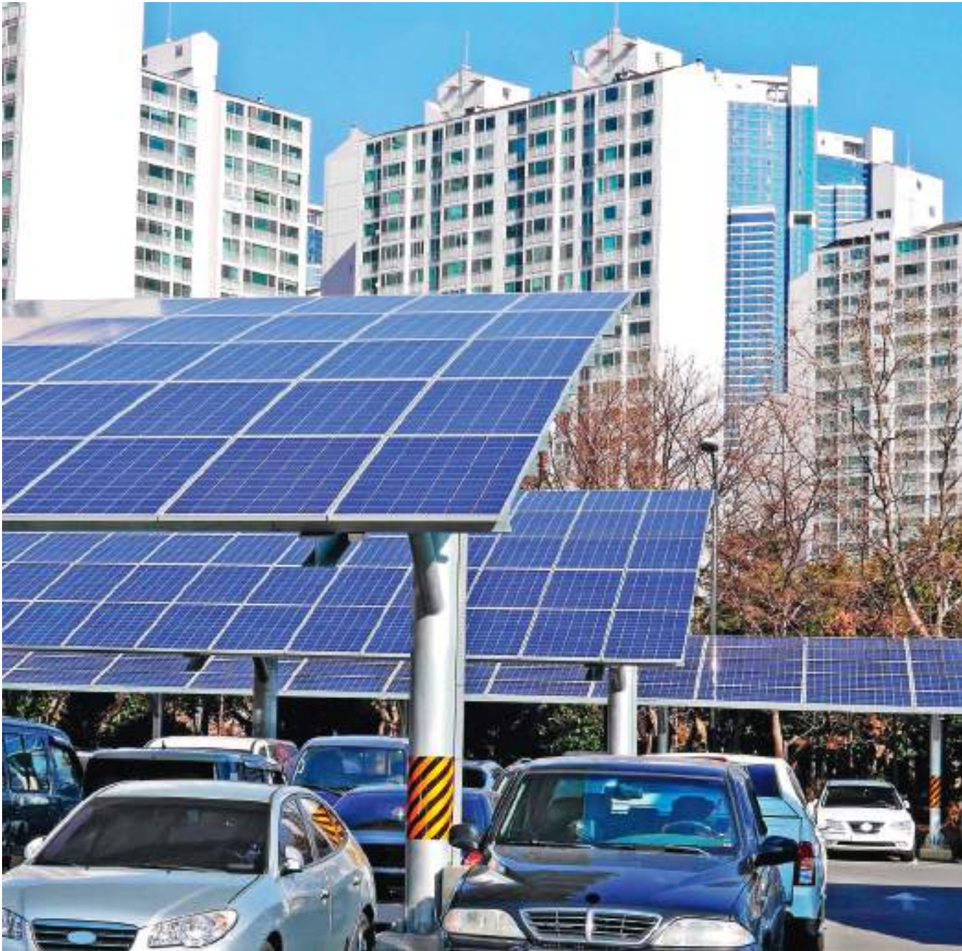
Estacionamiento techado con paneles solares. Foto: Shutterstock.
