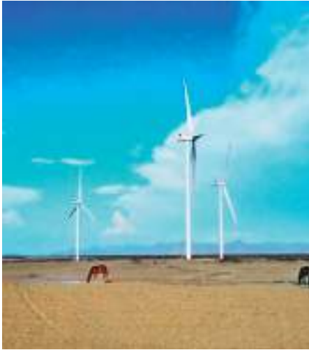
Aerogenerador instalado en la Central Eólica Talara (Piura). Foto: Osinergmin.
