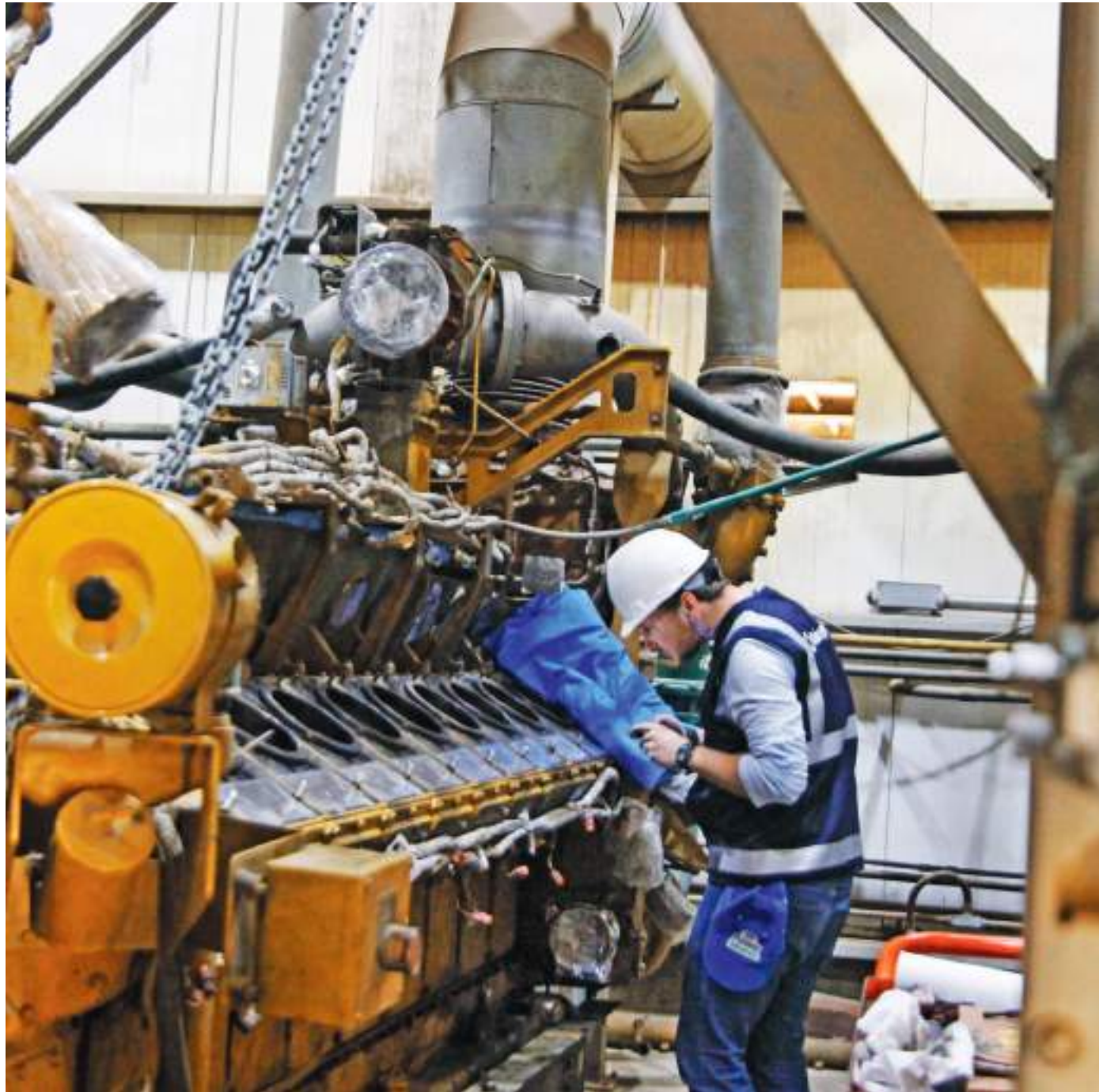
Visita técnica a la Central de Biomasa Huaycoloro (Lima). Foto: Osinergmin.
