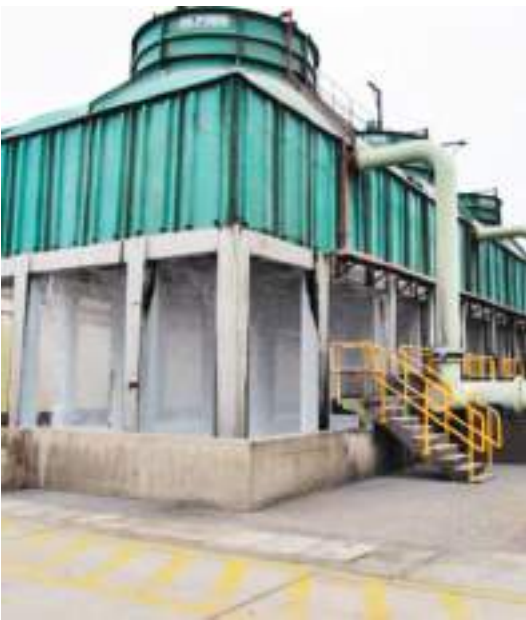
Radiadores del sistema de refrigeración de Central de Cogeneración Paramonga I (Lima). Foto: Osinergmin.
