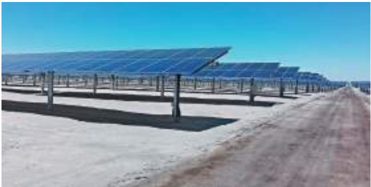
La Central Solar Rubí (Moquegua) forma parte de los proyectos de la Tercera Subasta RER. Foto: Osinergmin.
