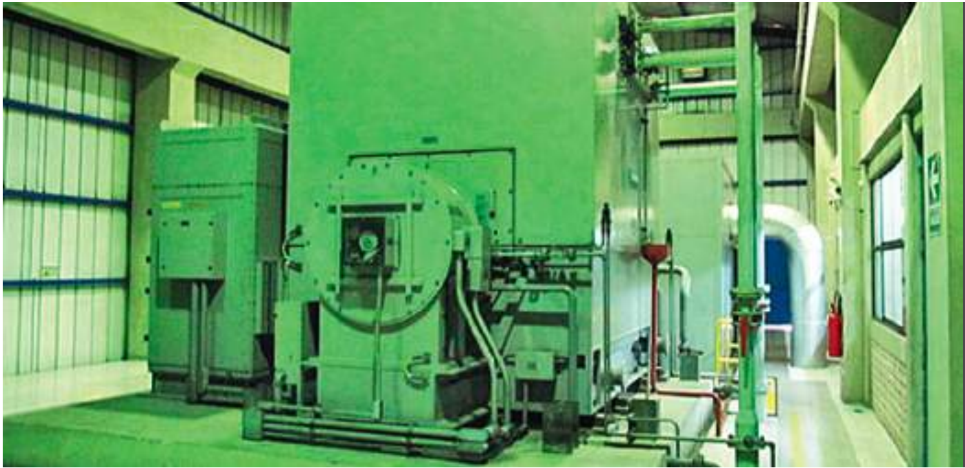
Grupo generador de la Central de Cogeneración Paramonga I (Lima). Foto: Osinergmin.
