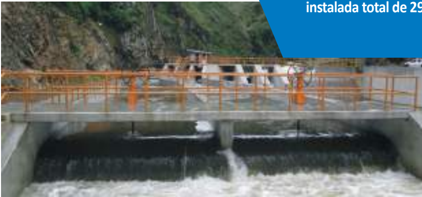
Bocatoma de la Central Hidroeléctrica Huasahuasi I (Junín). Foto: Osinergmin.
