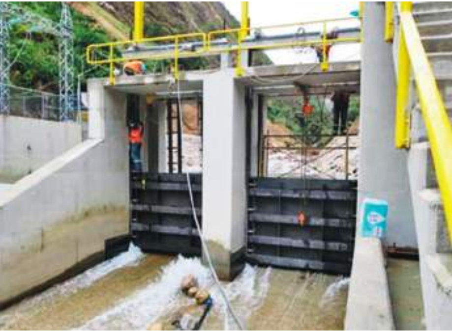
Compuertas del barraje móvil de la Central Hidroeléctrica Runatullo III (Junín). Foto: Osinergmin.
