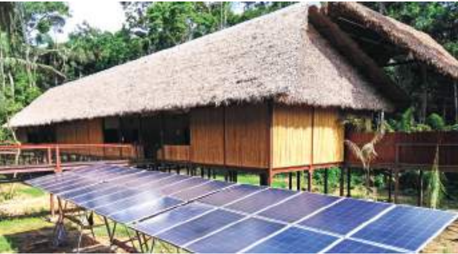
Suministro SFA en la Selva (Perú). Foto: Sociedad Peruana de Renovables (Waira).
