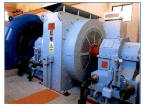
Grupo de Generación (Turbina Hidráulica-Generador Eléctrico)
