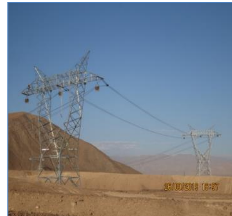
L.T. 220 kv Montalvo - Moquegua
