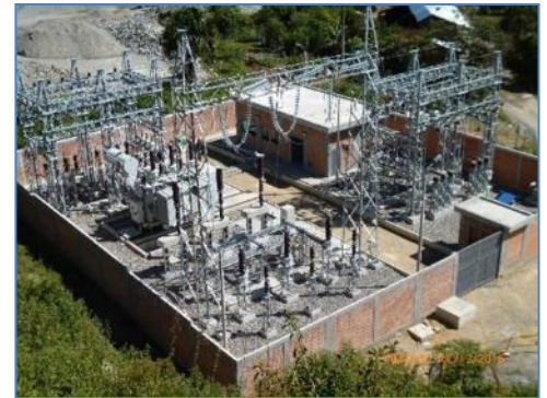
Vista panorámica de la S.E. 8 de Agosto
