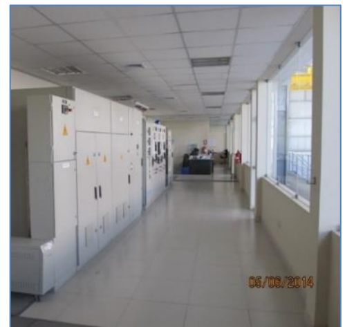
Sala de Control
