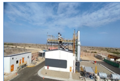
Sala de Máquinas (Gas Cube)
