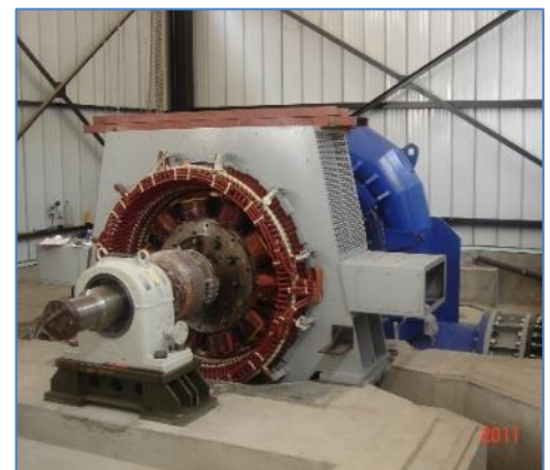
Turbina y Generador Eléctrico
