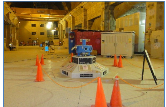
Sala de máquinas
