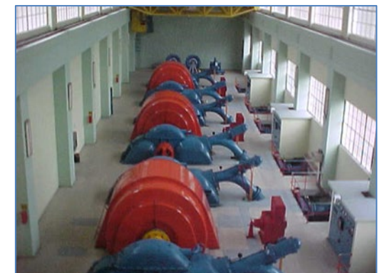
Sala de Máquinas
