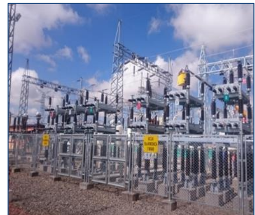
Subestación Puno (Bancos de Compensación Capacitiva)
