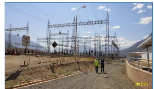
S.E. Kiman Ayllu (220 kV)
