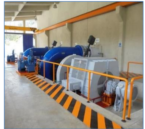
Interior de Casa de Máquinas
