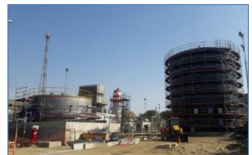
Tanque de transferencia de Diesel B5
