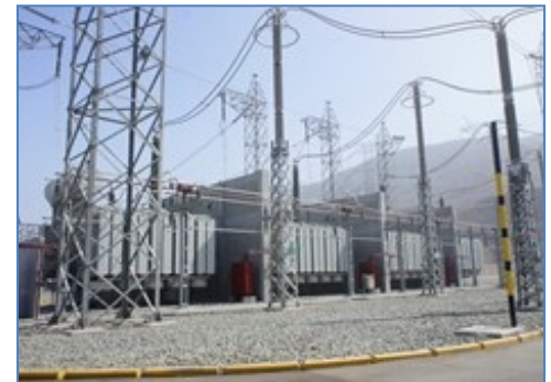
Banco de autotransformadores
