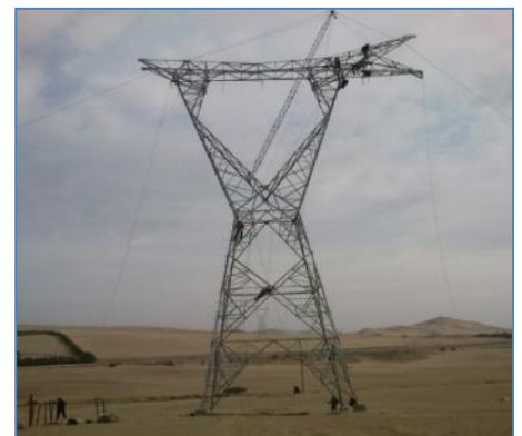
Torre Autoportada 500 kV
