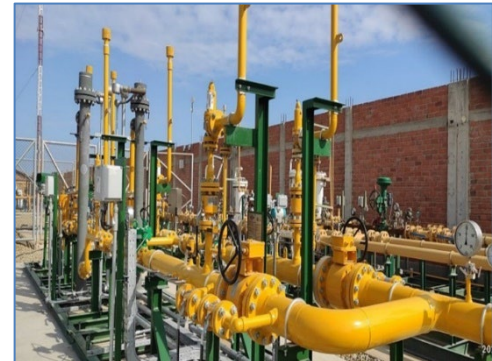
Sistema de combustible Gas Natural
