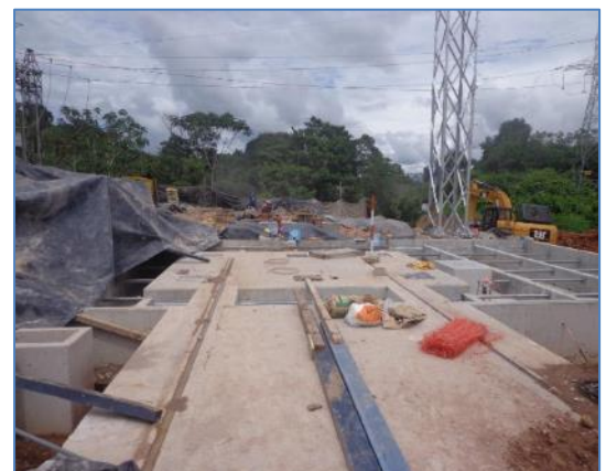
S.E. Aguaytía - Patio 220 kV
