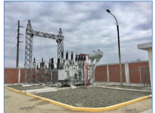
S.E. Santa Regina 60/22,9 kV
