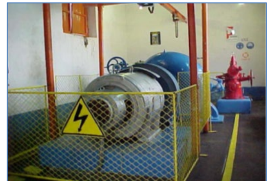
Unidad de generación
