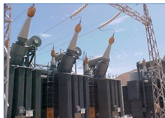
Subestación Aricota II
