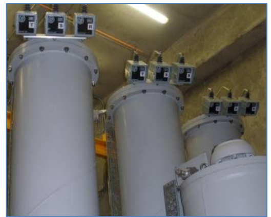
Circuitos de Salida en 138 kV
