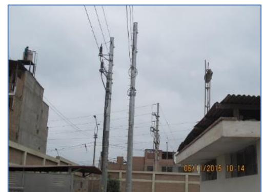
Poste de Llegada a la S.E. Huaral
