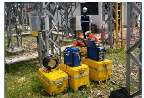
Pruebas de equipos A.T. en la S.E. Pucallpa
