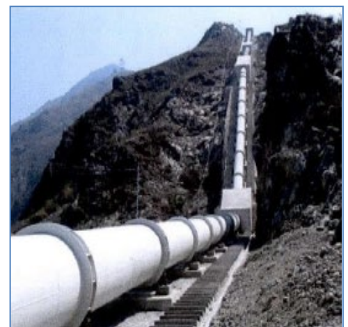
Tubería Forzada – C.H. Huasahuasi I
