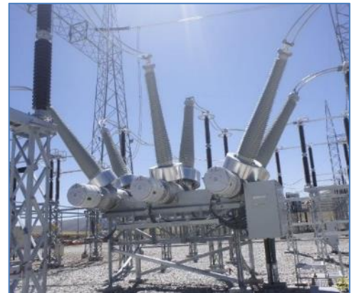
Interruptor de tanque muerto
