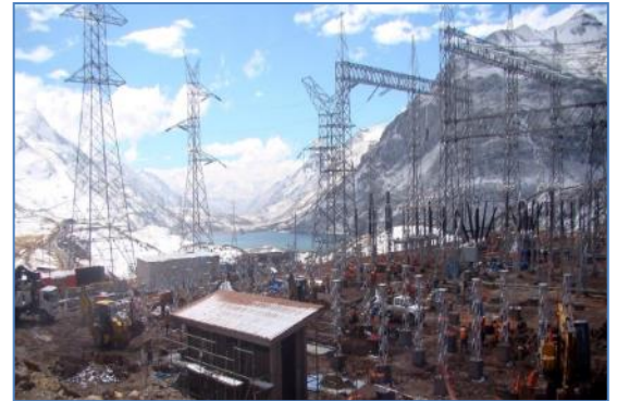
Vista de la S.E. Pomacocha
