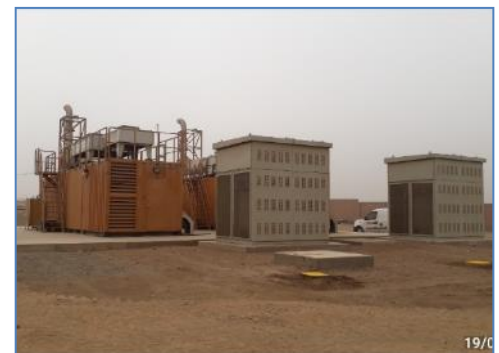
Unidades de Generación y Transformadores
