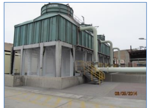
Radiadores del sistema de refrigeración de TV1
