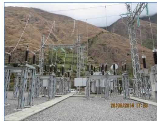
Vista Pórticos S.E. Runatullo III
