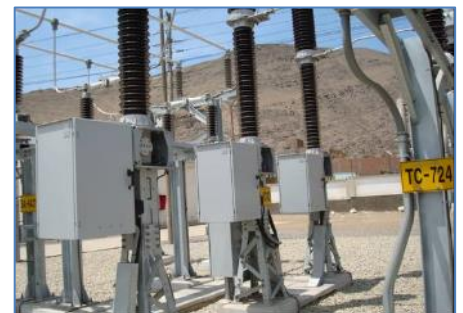
Interruptores instalados S.E. Chavarría
