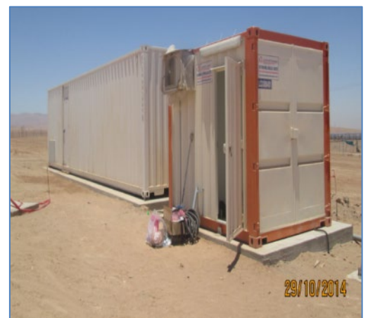
Casa de Control - P.S.F. Moquegua
