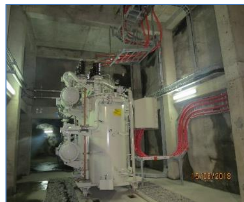
Transformador 6,6/33 kV – 25 MVA
