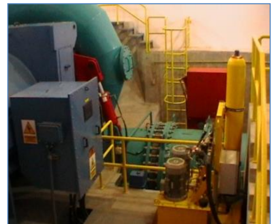
Turbina y Generador
