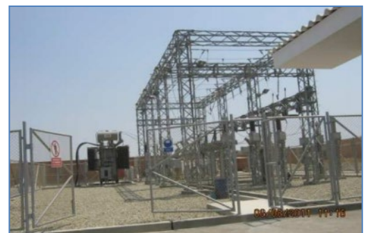
S.E. de Tablazo (Equipos del Patio de Llaves)
