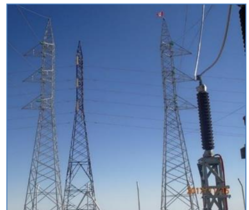
Torres de interconexión a línea existente
