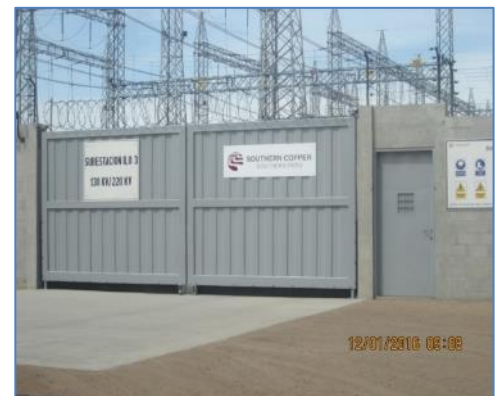
Subestación Ilo 3 220/138 KV
