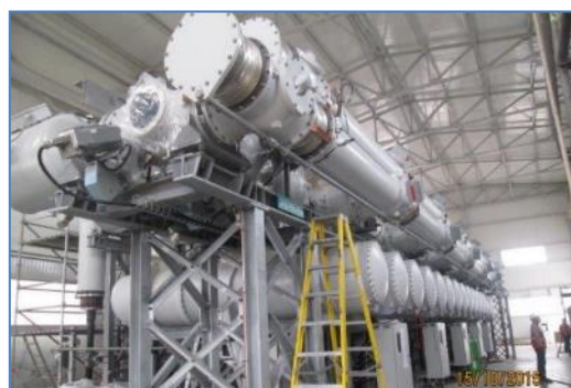
Subestación GIS - C.T. Puerto Bravo
