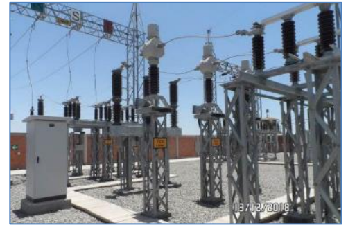
S.E. Los Héroes: Celda de la línea
