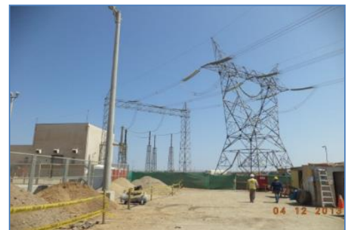
Pórtico de Salida y Subestación GIS 500 kV
