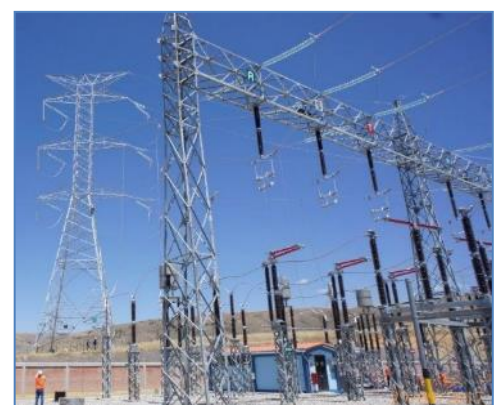
Primera torre del tramo de enlace de la S.E. Orcotuna
