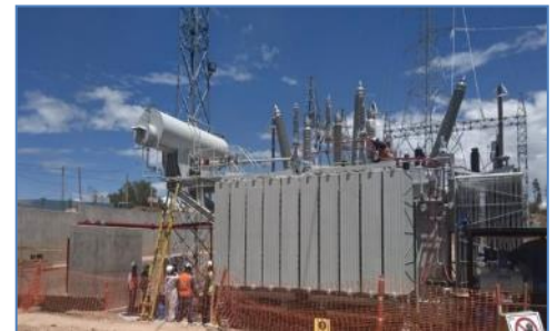
S.E. Mollepata: pruebas transformador de potencia
