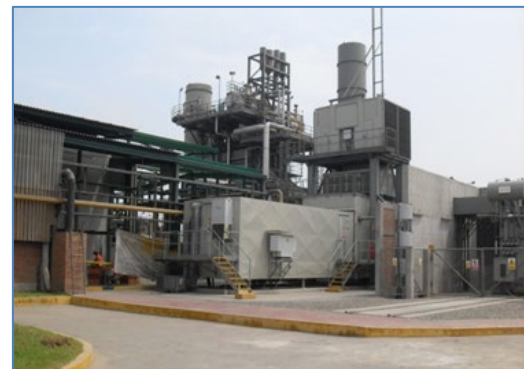
Unidad de generación
