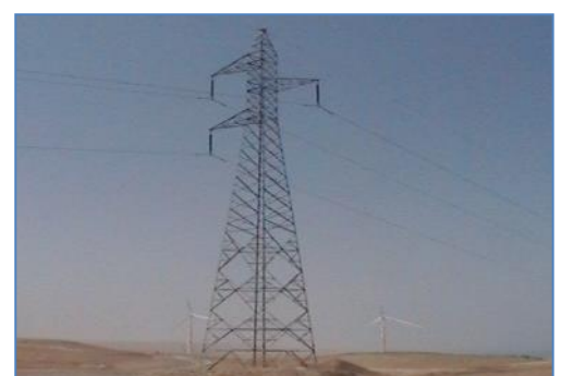
L.T. 220 kV S.E. P.E. Marcona – S.E. Marcona
