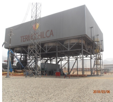
Vista general del Aerocondensador
