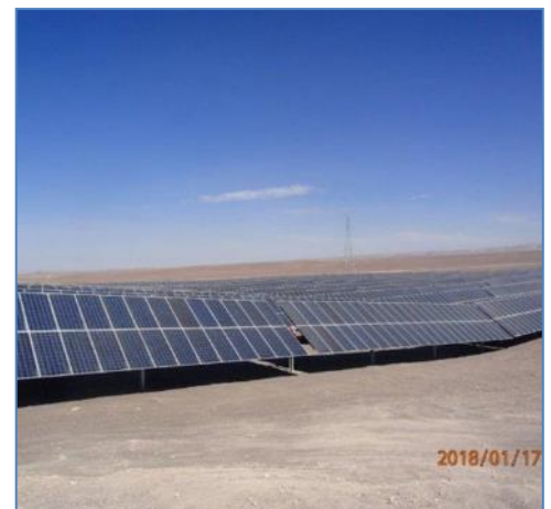
Vista de los paneles solares
