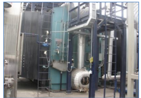
Caldera de Recuperación de calor
