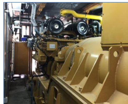
Vista del grupo de generación
