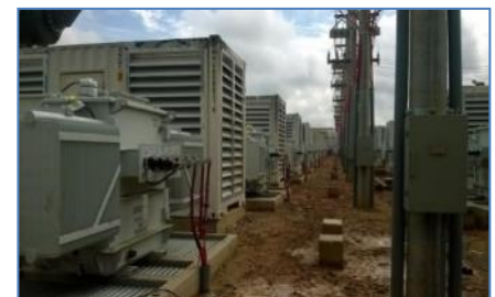
Grupos Electrógenos CAT Instalados (25 de 1,825 MW)
