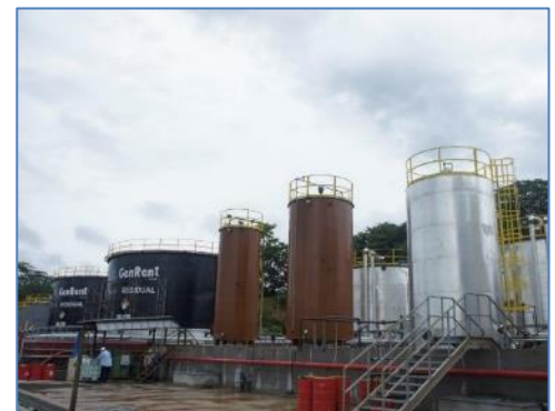
Tanques de combustible, aceite y agua
