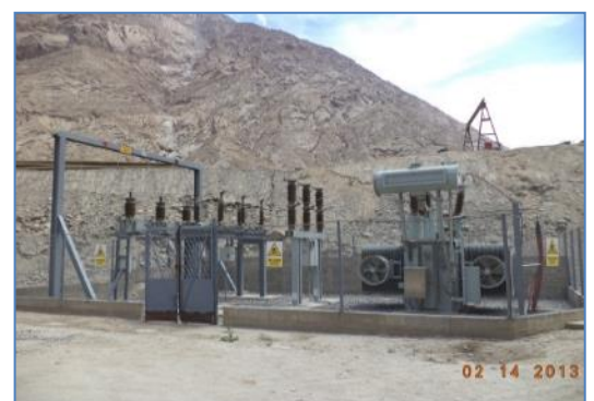
Subestación Eléctrica de la C.H. Yanapampa
