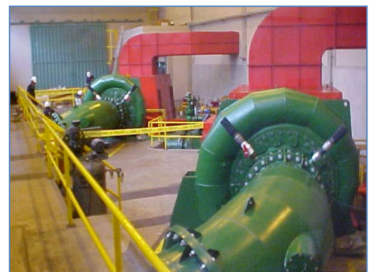
Sala de Máquinas
