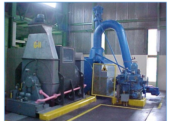
Sala de Máquinas
