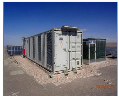
Caseta de inversores y transformadores
