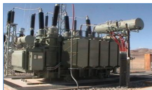
Transformador de Potencia 20 MVA, 23/138 kV
