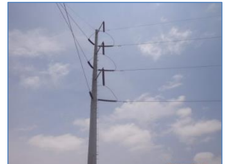
L.T. 220 kV Piura Oeste – Cementos Piura (Poste N° 10)
