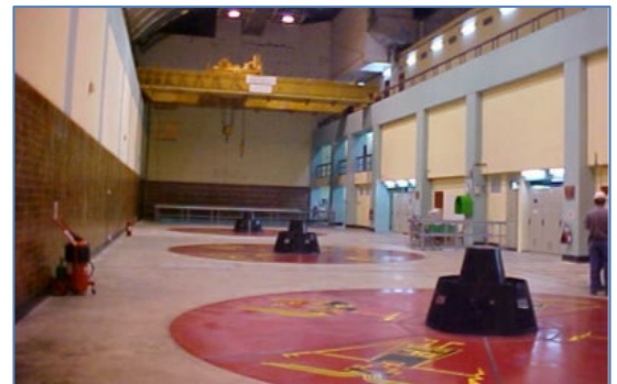
Sala de Máquinas
