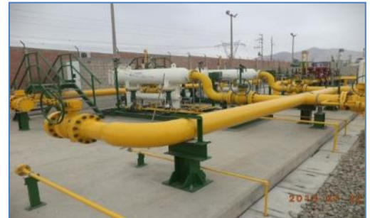
Acondicionamiento del Gas Natural para el ingreso a la Central
