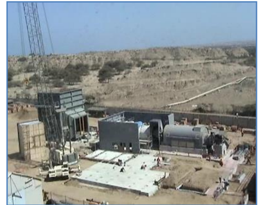
Vista panorámica de la Central Concluida
