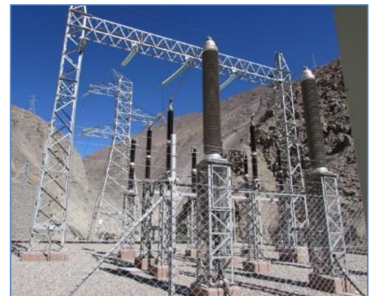
Patio de llaves S.E. Cheves
