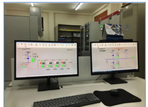
Centro de Control – S.E. Santa Regina
