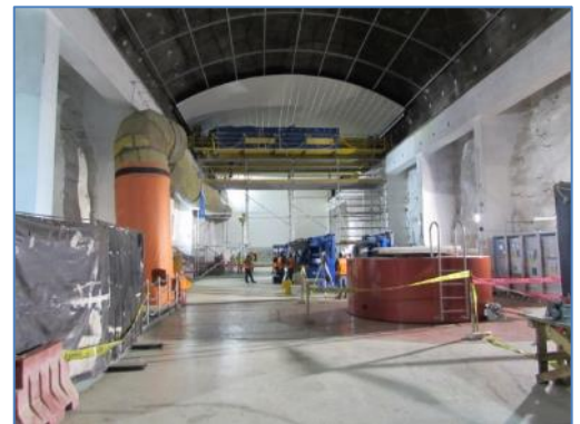
Casa de Máquinas (en caverna)
