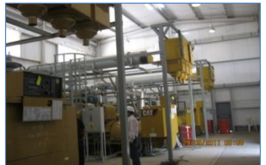
Grupos de Generación 3 x 1,6 MW
