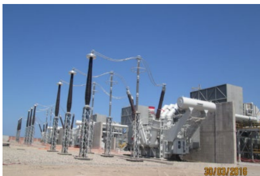
Transformadores de Potencia
