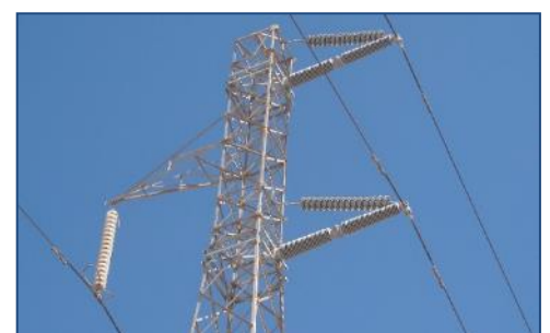
Conjunto de Aisladores Line Post en L-2209
