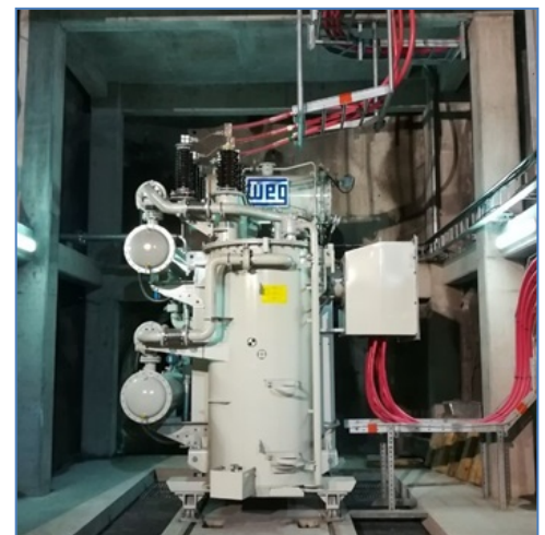
Transformador de 25 MVA
