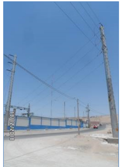
Estructura N° 77, llegada a la S.E. Parque Industrial
