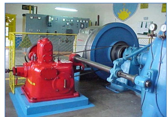
Sala de Máquinas
