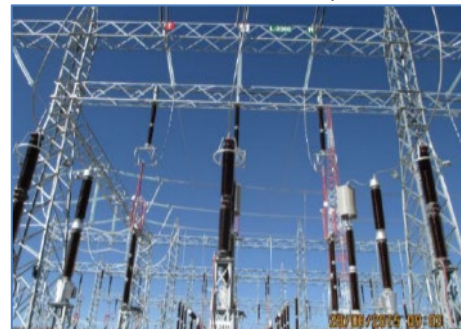
Vista de la S.E. Cotaruse
