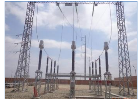
Patio de Llaves 220 kV de la S.E. Piura Oeste
