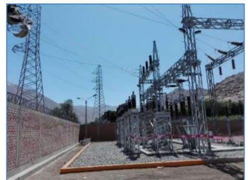
Torre de Llegada a S.E. Andahuasi
