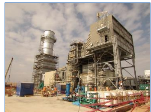
Turbogenerador y equipos auxiliares
