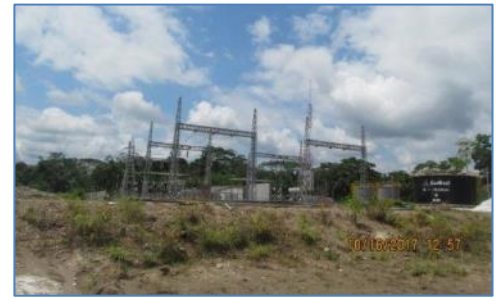
Subestación de salida
