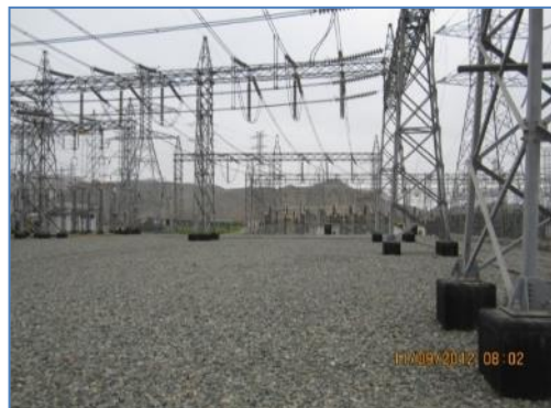
S.E. Chilca- Area para Reactor Serie y Celda de Conexión
