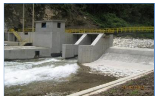
Barraje fijo y móvil de la Bocatoma
