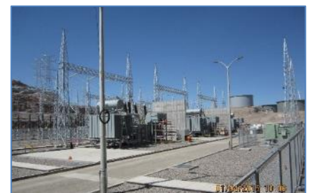
Transformadores 220/34,5 kV-150 MVA (S.E. San Luis)
