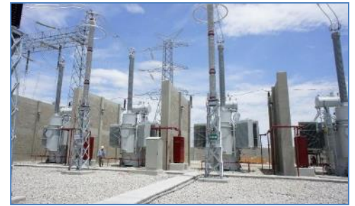
Banco de reactores R-37
