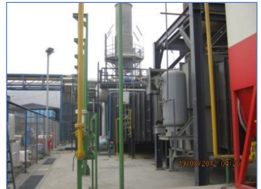
Instalaciones de C.T. Huachipa
