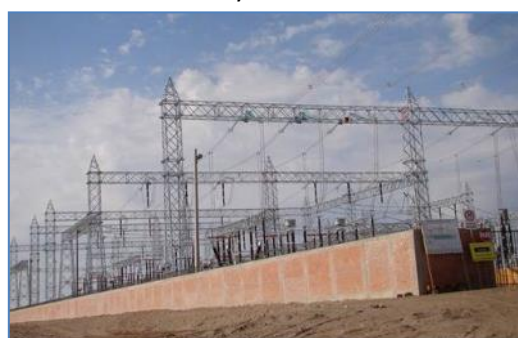
Subestación San José
