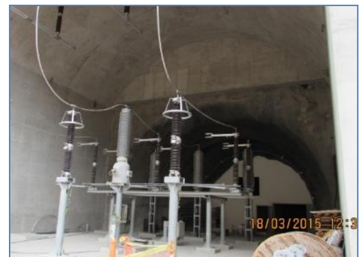
Transformador de potencia en caverna (S.E. Quitaracsa)
