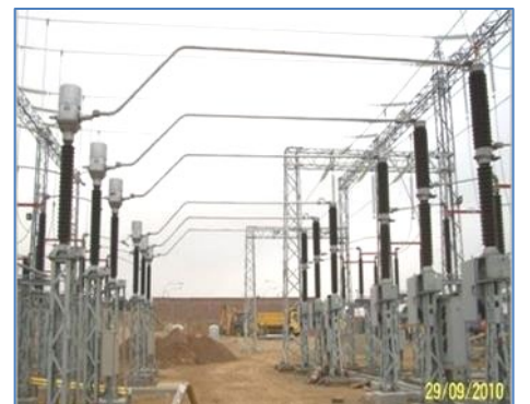
S.E. Trujillo Norte
