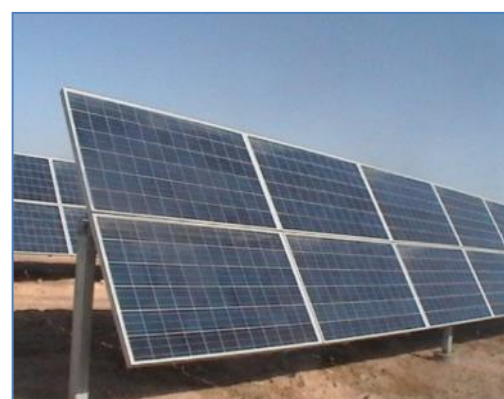
Módulos Solares Instalados
