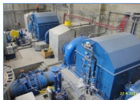
Casa de Máquinas para dos grupos de generación
