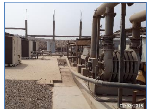
Ampliación de la Estación de Compresión
