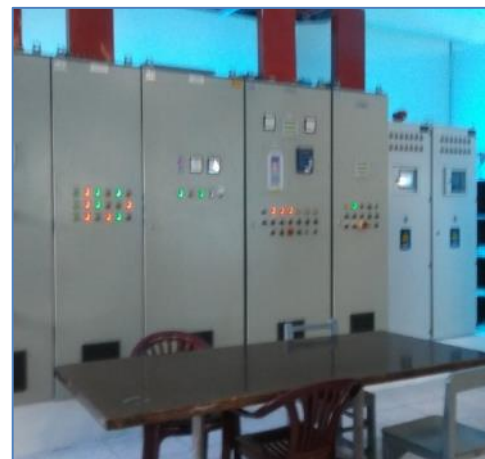
Sala de Tableros de Control y Mando
