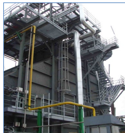
Caldero de cogeneración
