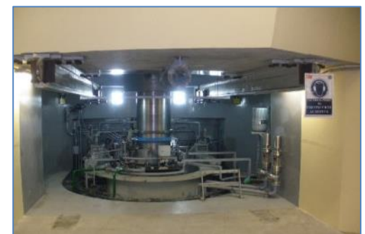
Eje de Acoplamiento Turbina-Generador Eléctrico
