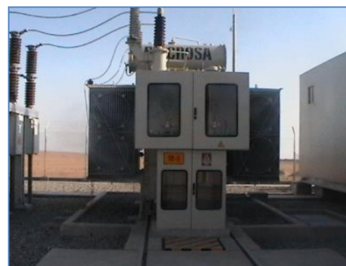
Transformador de Potencia de 20 MW – 23 7 66 kV (S.E. C.S Tacna)
