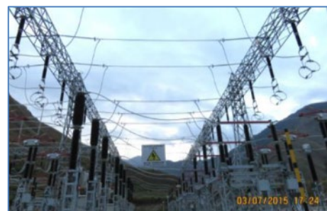
Vista de la S.E. Suriray
