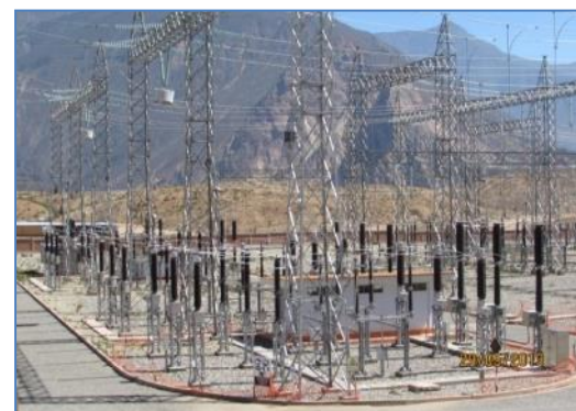
Celda de llegada en S.E. Kiman Ayllu
