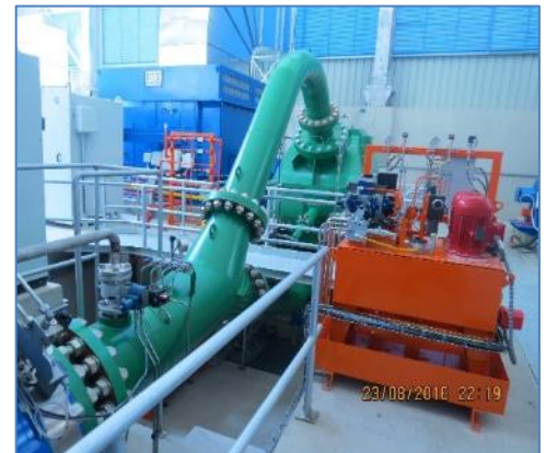
Turbina y unidad de presión hidráulica
