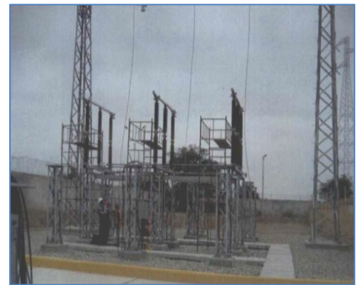
Pruebas eléctricas al seccionador de línea
