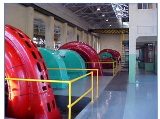
Sala de Máquinas
