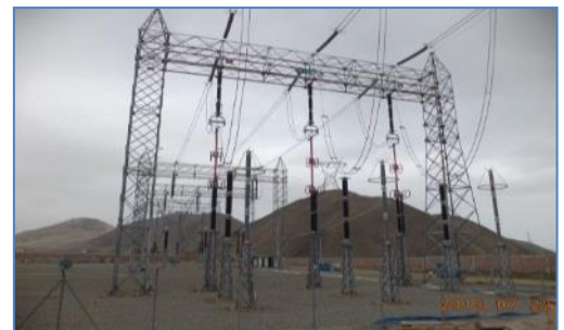
Patio de llaves - Central Santo Domingo de Olleros
