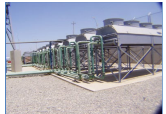
Torres de enfriamiento
