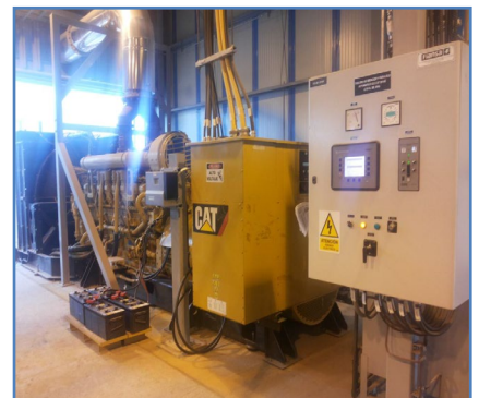
Generador Diésel N° 1
