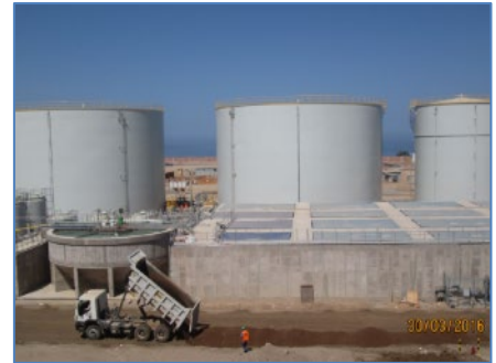
Tanque de Almacenamiento Combustible Diésel B5
