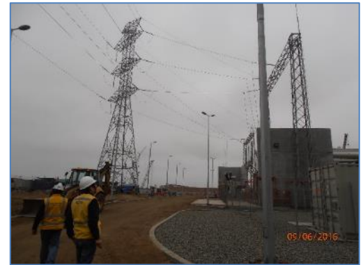
Pórtico y 1ra estructura de la L.T.
