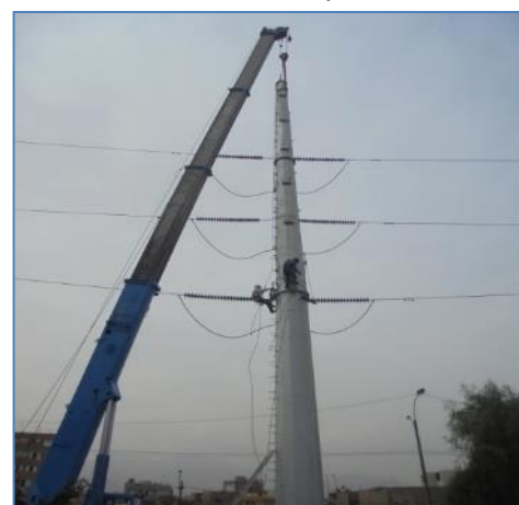
Montaje de Poste Metálico del 2do y 3er Cuerpo de la L-2246
