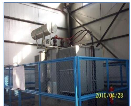
Transformador de Potencia
