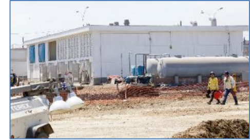
Edificio de Grupos Generadores y Tanques de Combustible
