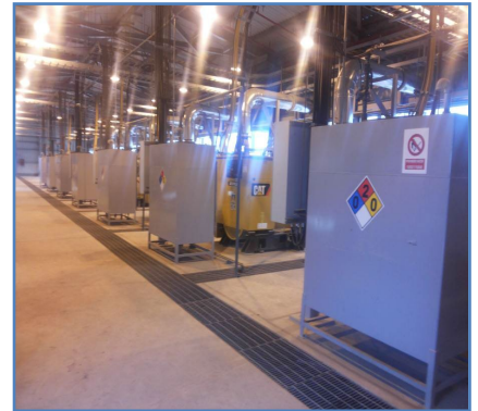
Vista de los 7 grupos electrógenos Diésel
