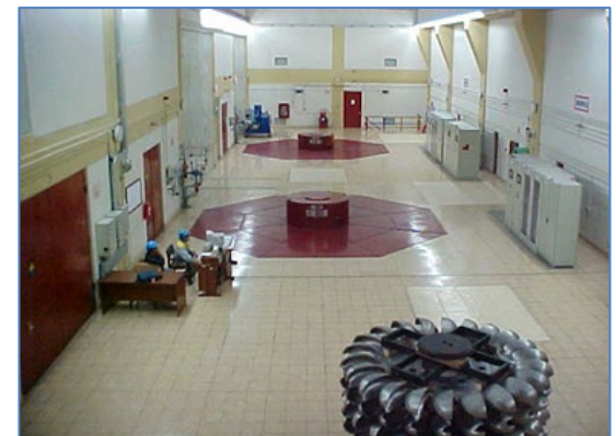
Sala de máquinas
