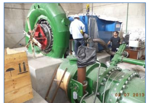
Turbina Rodete N° 2
