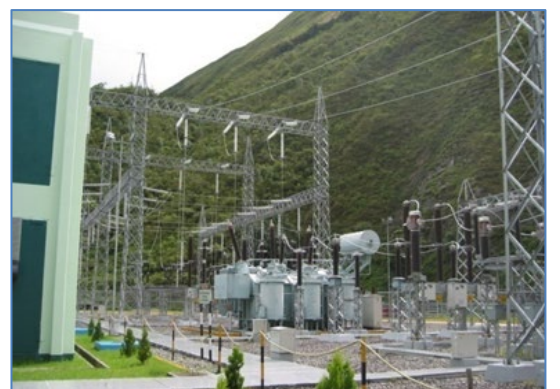
Subestación Santa Isabel
