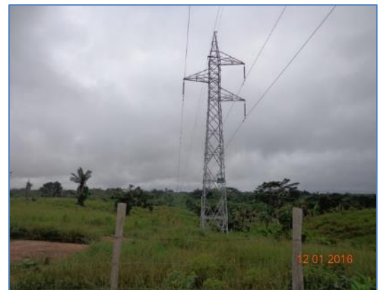
Nueva Torre 153A (entre T153 y T154) de la L.T. Aguaytía-Pucallpa
