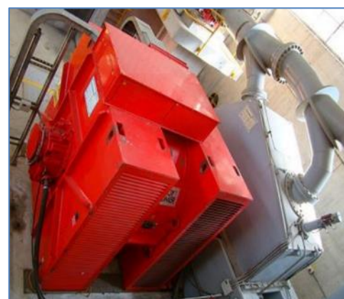
Generador de la Central
