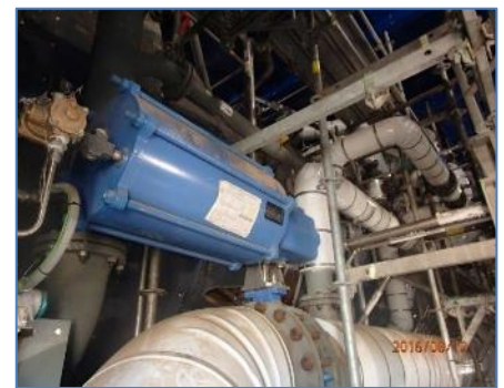
Instalaciones del Grupo N° 1
