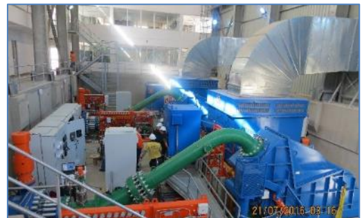
Casa de Máquinas
