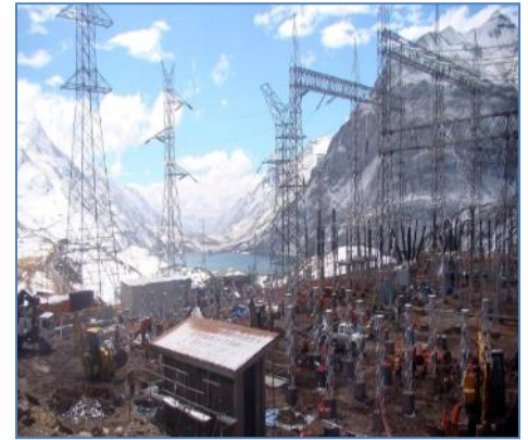
S.E. Pomacocha, bahía 220 kV
