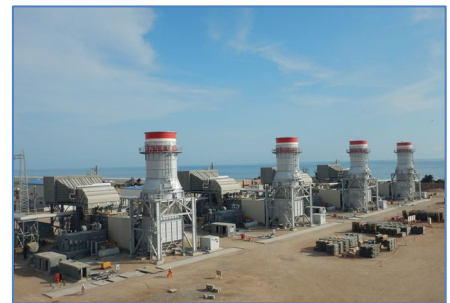
Turbinas y Generadores 1, 2, 3 y 4
