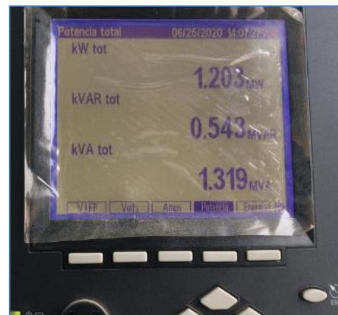
Panel de control del Grupo N° 1
