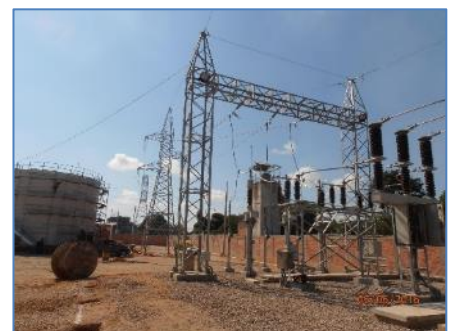
Subestación de Salida en 60 kV C.T. Pucallpa
