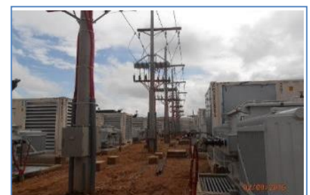
Sistema de Barras en 22,9 kV
