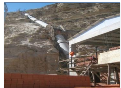
Vista de la Tubería Forzada-Casa de Máquinas
