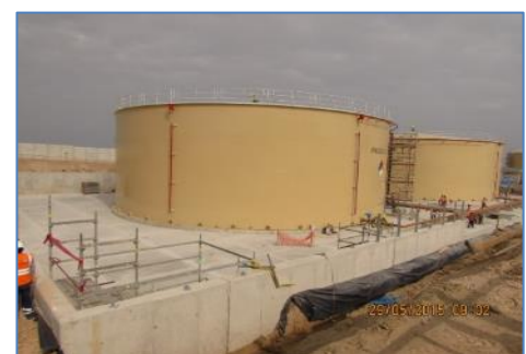
Tanques de almacenamiento de combustible Diésel B5
