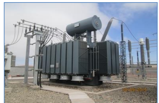
Transformador de Potencia 100 MVA
