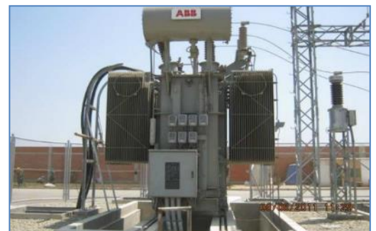
Transformador ABB de 42 MVA 60/13,8 kV
