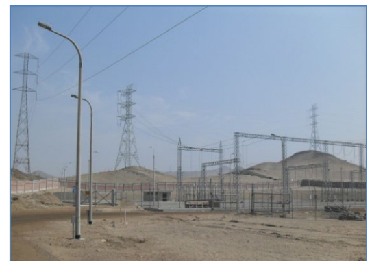
Subestación Las Flores
