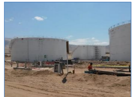
Tanques de almacenamiento de Combustible
