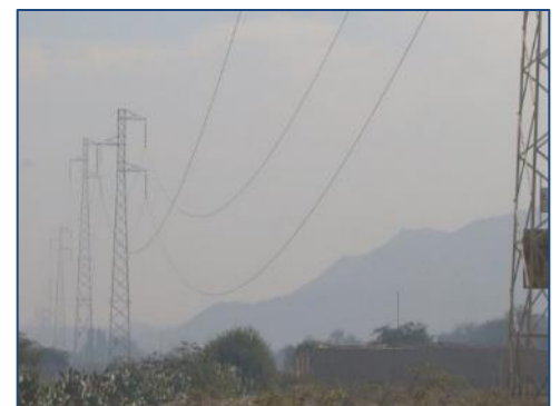
Torres de alineamiento con aisladores de suspensión
