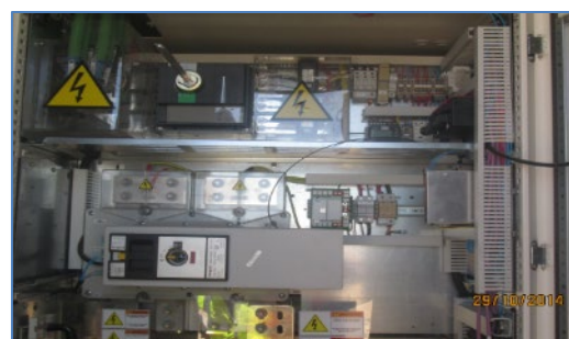
Vista del conexionado del inversor
