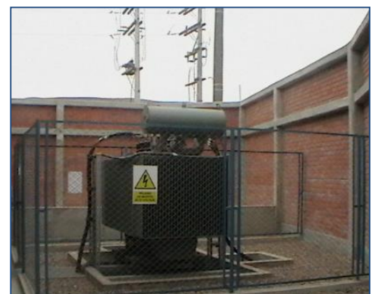
Transformador de Potencia
