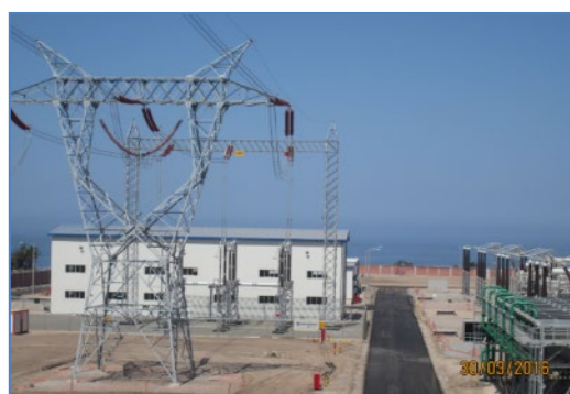
Patio de Llaves y Subestación Puerto Bravo
