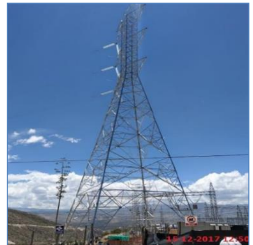
Torre 191 L.T. 220 kV Friaspata - Mollepata
