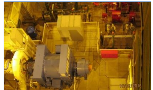
Casa de Máquinas de la Pequeña Central Hidroeléctrica
