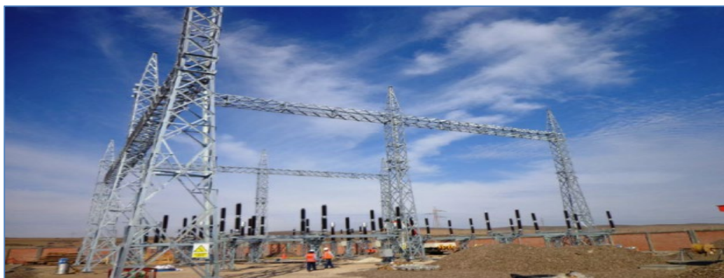
Vista Subestación Marcona
