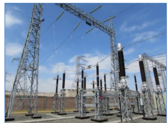
Celda de llegada en S.E. Huacho
