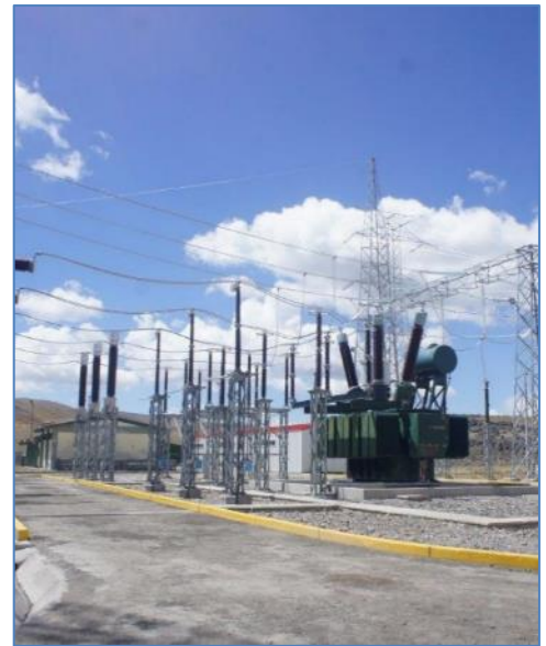
Reactor XL12 reubicado
