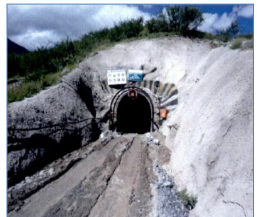
Túnel Principal Portal Salida, Tubería Baja Presión
