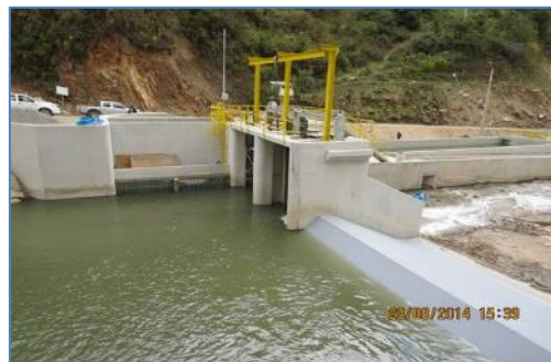
Bocatoma y Desarenador
