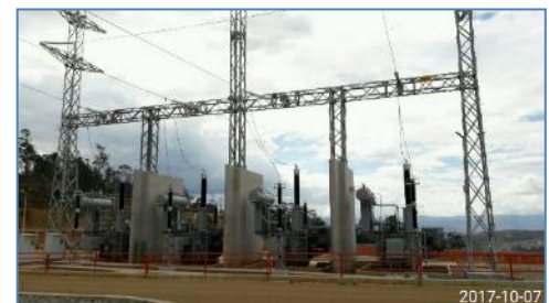
S.E. Cáclic: autotransformadores HYOSUNG
