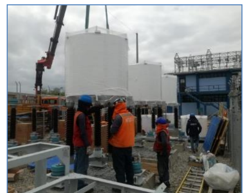
Banco de Condensadores en la S.E. Zorritos
