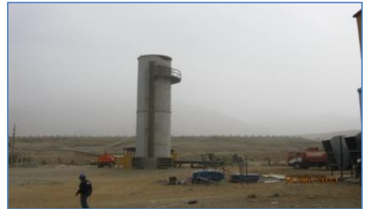
Quemador de Biogás
