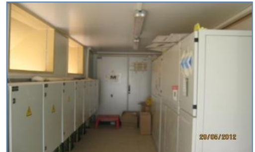
Centro de Transformación de Corriente Continua a Corriente Alterna
