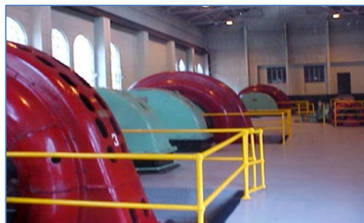
Sala de Máquinas
