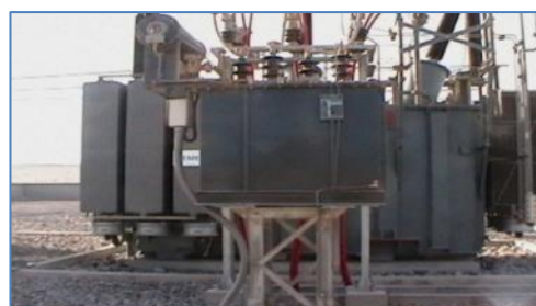
Transformador de 35 MVA – 220 kV
