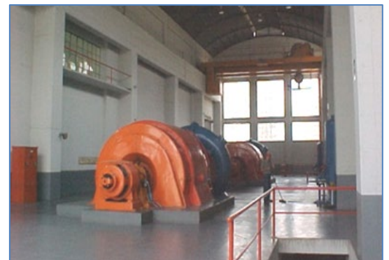
Sala de Máquinas
