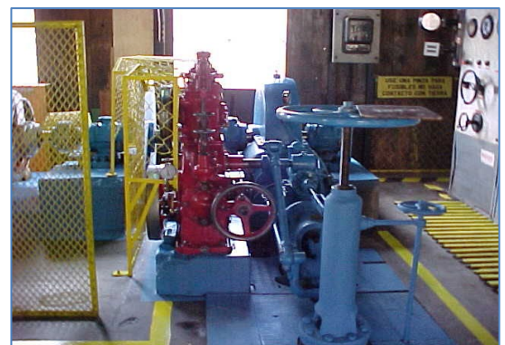
Sala de Máquinas
