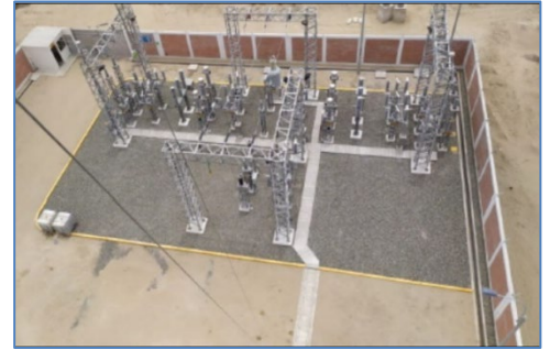
S.E. Catacaos 60 kV
