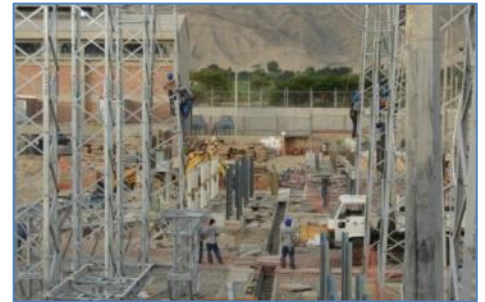
Ampliación S.E. Independencia 60 kV
