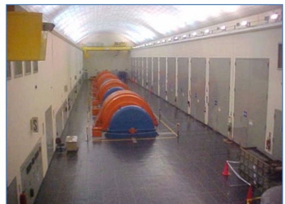
Sala de Máquinas
