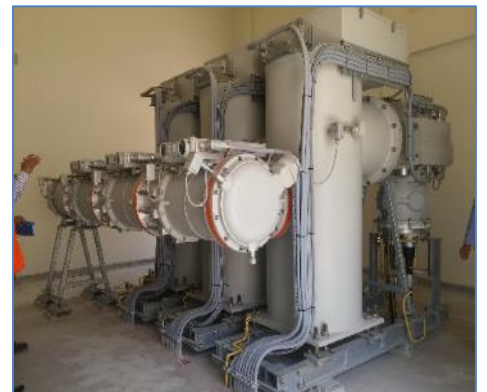
Subestación GIS en 60 Kv
