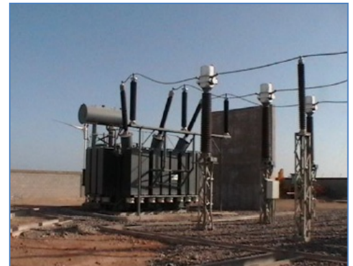
Transformador de Potencia de 35 MVA (20/220 kV)
