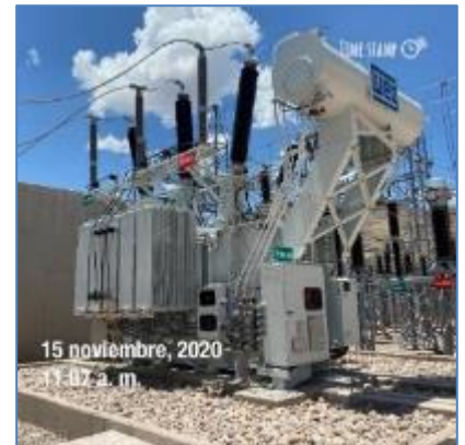
Transformador de potencia WEG T126-162 de la S.E. Combapata
