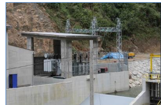
Vista de la S.E. Runatullo II
