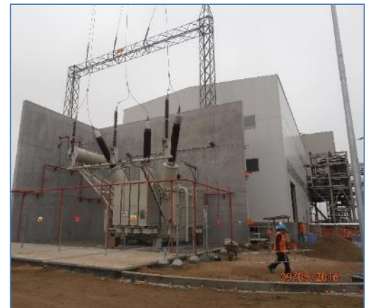
Transformador de potencia asociada a la TV
