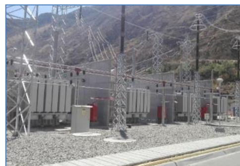
Autotransformadores 500/220/33 kV S.E. Colcabamba
