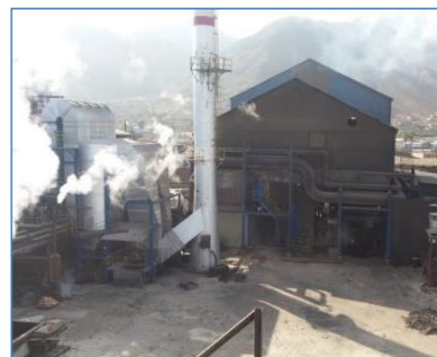
Vista panorámica de la planta industrial
