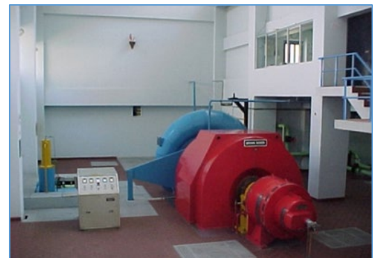
Sala de Máquinas
