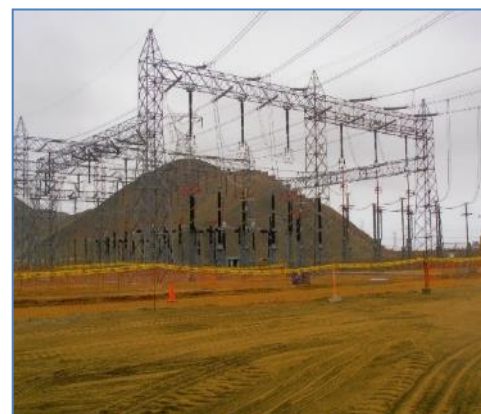
Patio de llaves en 500 kV
