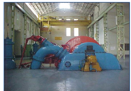
Sala de Máquinas
