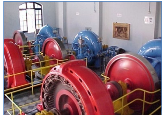
Sala de Máquinas
