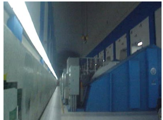
Sala de Máquinas
