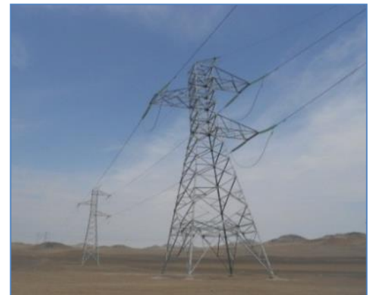
L.T. 220 KV S.E. Cheves-S.E. Huacho
