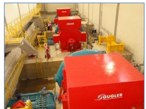
Sala de Máquinas (3 turbinas de 6,56 MW)
