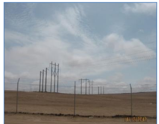
L.T. 138 kV C.S. Panamericana Solar 20 TS – S.E. Ilo 3
