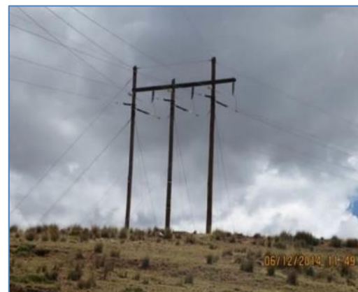
L.T. 69 kv S.E. CANCHAYLLO – L.T. OROYA-CHUMPE
