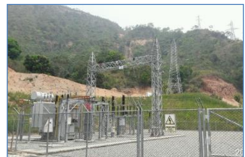
Vista de Subestación Renovandes H1
