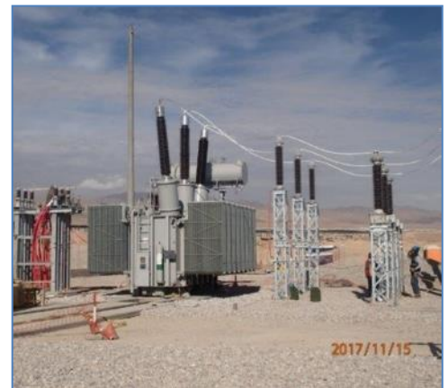
Transformador de Potencia
