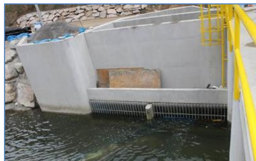
Ventana de captación
