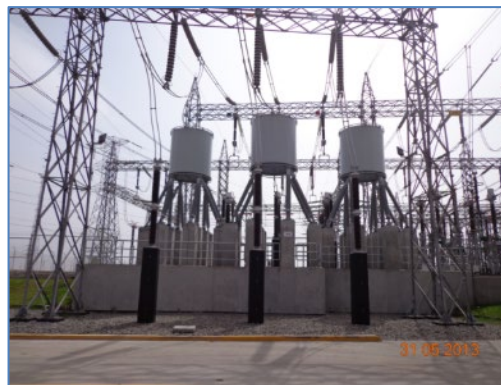
Reactor Serie entre las barras de 220 kV
