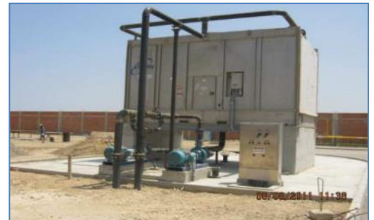
Torre de Enfriamiento de la Planta
