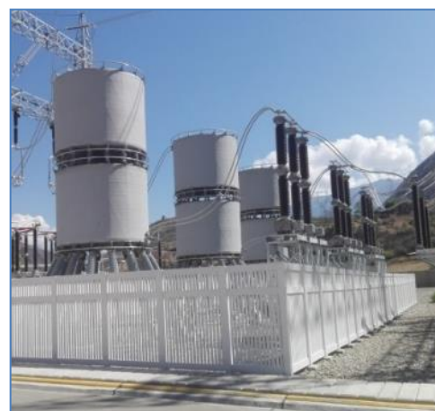
S.E. Colcabamba: reactor serie 220 kV
