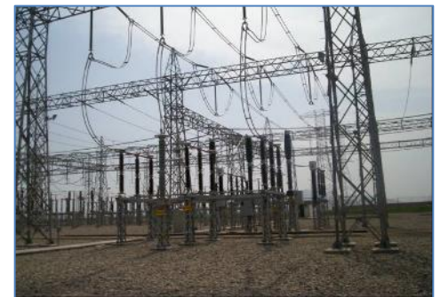
Patio de Llaves S.E. Chilca
