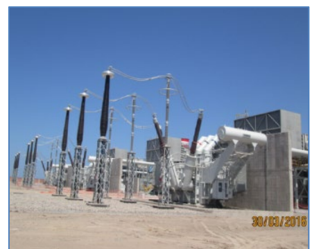
Transformadores de la C.T. Puerto Bravo
