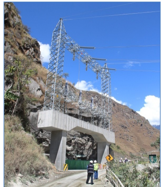
Pórtico 220 kV L-20149 Santa Teresa-Suriray
