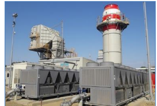
Chillers del Sistema de Enfriamiento
