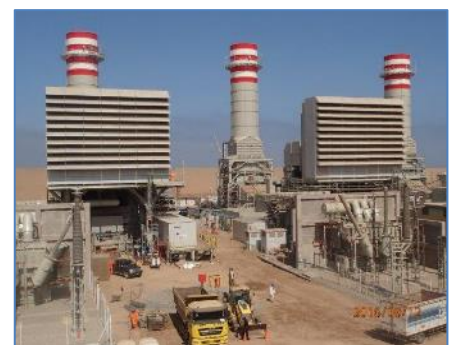
Vista de los turbogeneradores
