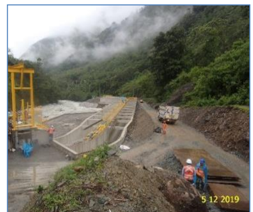
Desarenador de 2 naves
