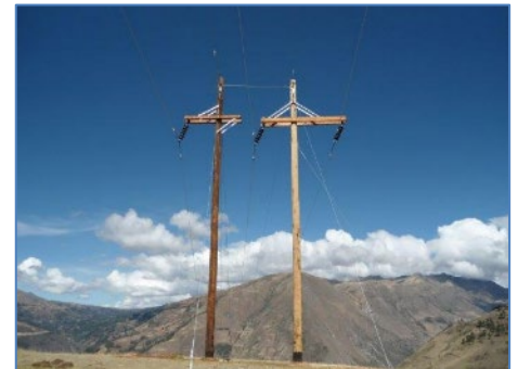
Estructura de la L.T. 60 KV S.E Andahuaylas – S.E. Chilcayoc
