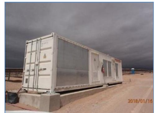
Caseta de inversores
