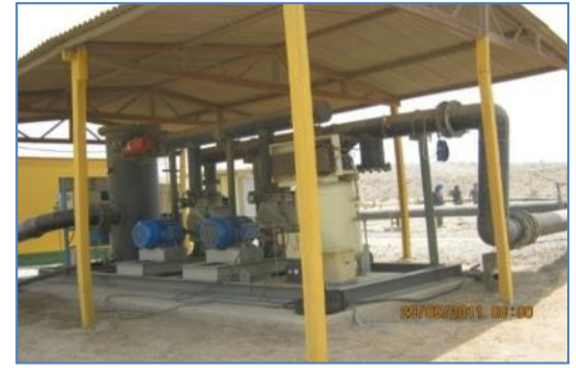
Planta de tratamiento de Biogás
