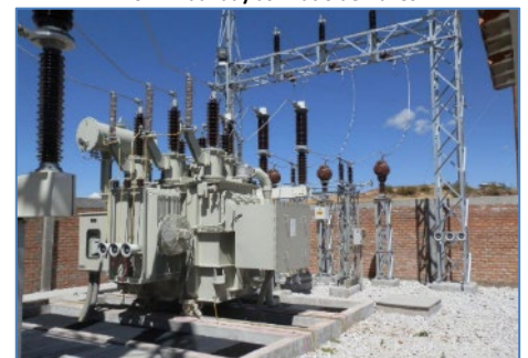
Subestación Chilcayoc-Patio de Llaves
