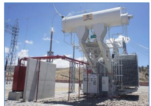
Transformador Hyosung 220/60 kV
