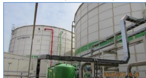
Tanques de almacenamiento de agua
