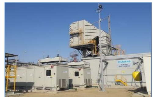
TG6 (Turbina - Generador Siemens)
