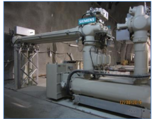
Subestación sistema GIS, en caverna
