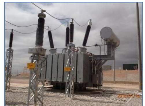
Transformador de potencia de 50 MVA
