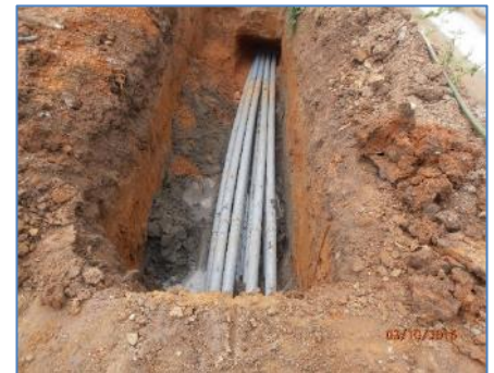
Tubería PVC para instalación de cables de energía en 10 kV
