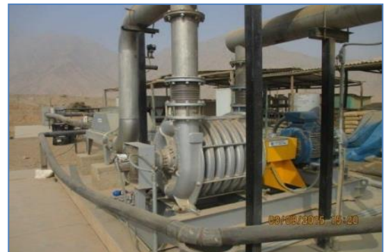
Planta de tratamiento de biogás
