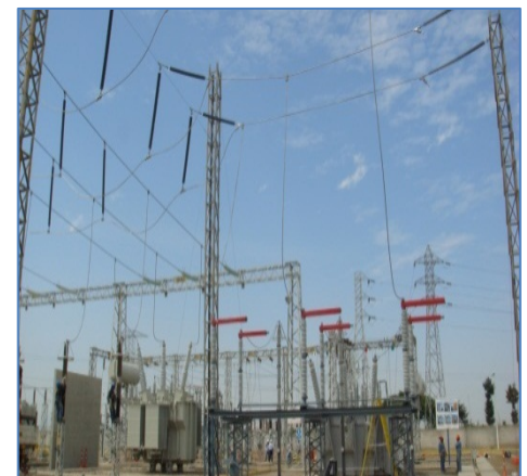
Transformador Provisional en la S.E. Guadalupe
