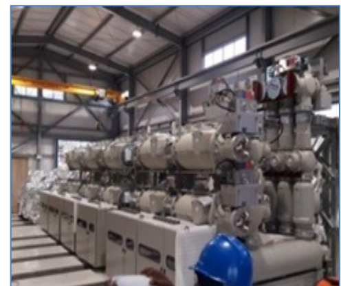
S.E. Friaspata: Instalación GIS
