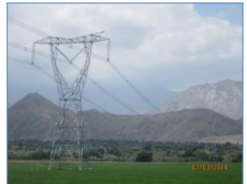
Torre N° 185 Tramo sector Limoncarro – Guadalupe
