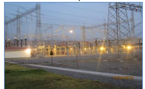
Puesta en servicio SE Socabaya y Circuito I L.T. 220 kV Tintaya - Socabaya día 15.04.14
