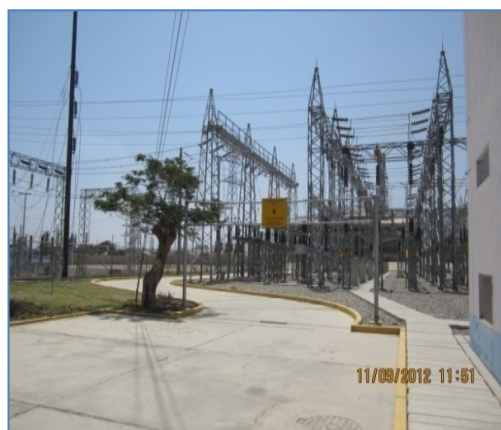
Patio de Llaves 60 kV- S.E.Independencia
