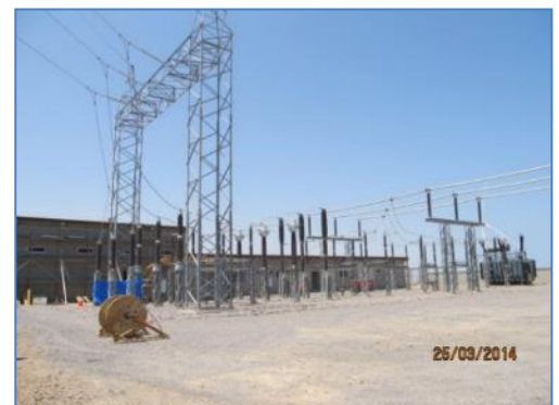
S.E. Parque Eólico Marcona
