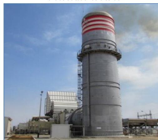
Unidad de generación turbina a gas
