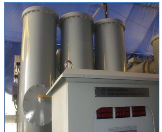
Equipamiento de la S.E. GIS Huanza
