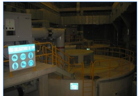
Sala de máquinas
