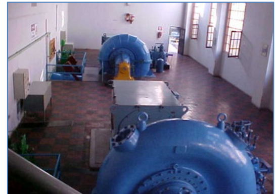
Sala de Máquinas
