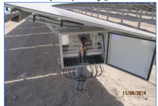
Caja de nivel 1
