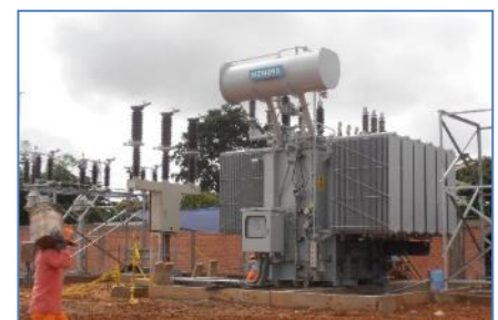
Transformador de Potencia de 50 MVA (22,9/60 kV)
