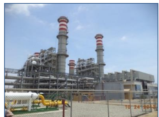
Calderos Recuperadores de Calor y Chimeneas Principales (Unidades 1 y 2)
