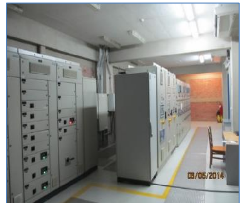
Sala de Tableros de Control de la unidad TV1
