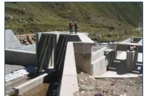
Vista panorámica Bocatoma
