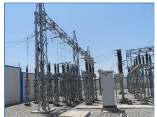
S.E. Parque Industrial: celda de la línea
