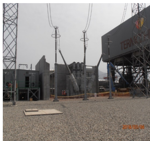
Transformador de potencia
