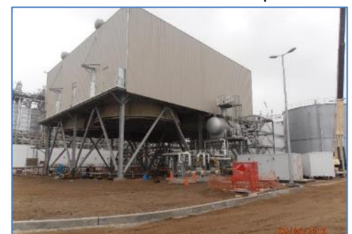
Vista del Aerocondensador
