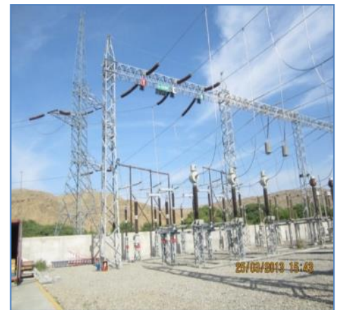
Torre N° 1 para ingreso a nueva bahía SE Talara
