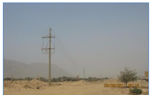
Línea de subtransmisión 22,9 kV
