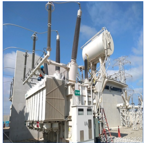
Transformador de potencia T121-261 S.E. La Brea
