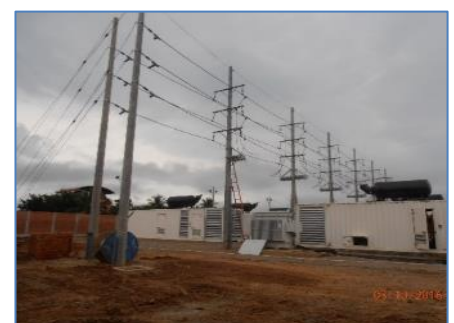
Conexión del sistema de barras en 10 kV con la SE Puerto Maldonado de Electro Sur Este
