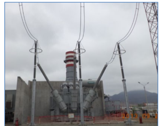
Transformador - S.E. Santo Domingo de los Olleros
