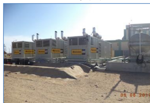
Sistema de Arranque Black Start (3x2,5 MW)
