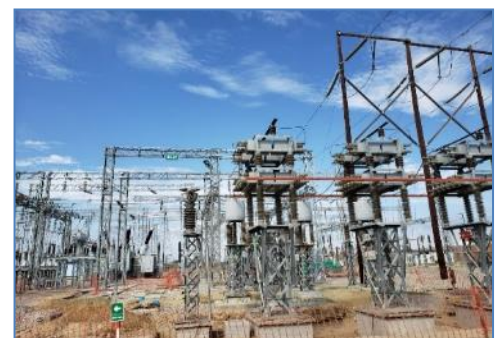
Banco de Condensadores BC-21 reubicado
