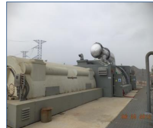
Turbina de Vapor
