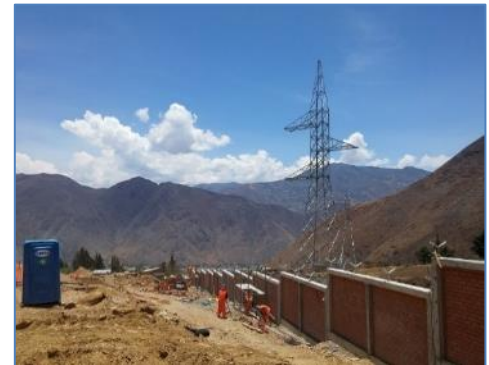
Muro Perimetral de la S.E. Amarilis 138 kV y Torre N° 1 a S.E. Piedra Blanca (L-1121)
