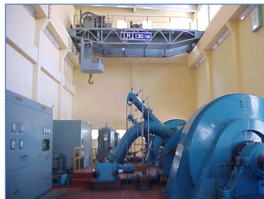
Sala de Máquinas
