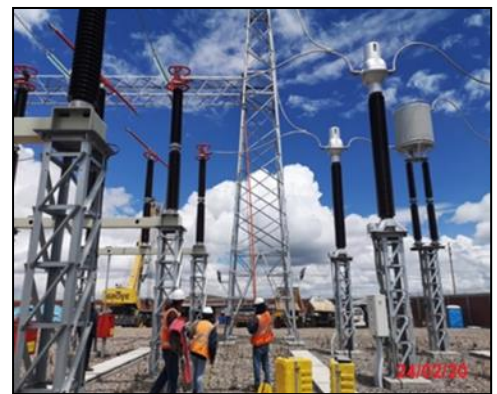
Pruebas en Patio de Llaves de S.E. Puno
