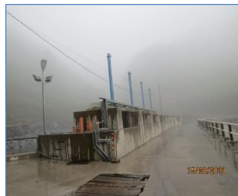
Cilindros hidráulicos de toma secundaria
