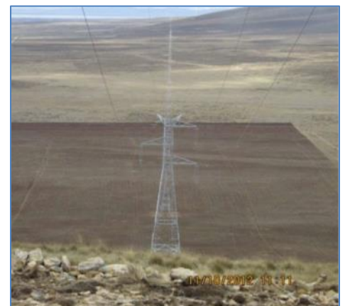
Torre con Aislamiento en suspensión
