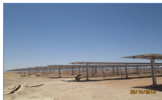
Módulos fotovoltaicos instalados
