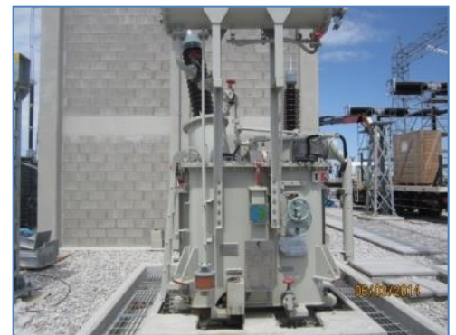
Reactor de PAT del neutro – Banco de Reactores – 4 x 50 MVAR c/u
