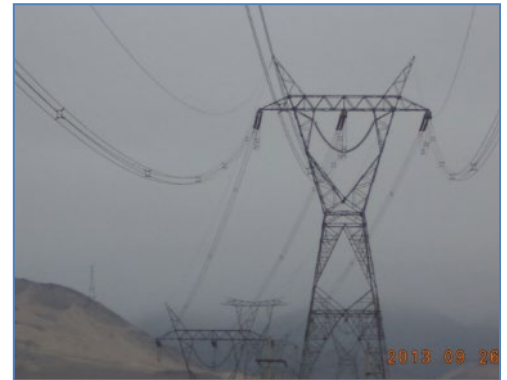
L.T. 500 kV S.E. Fénix – S.E. Chilca
