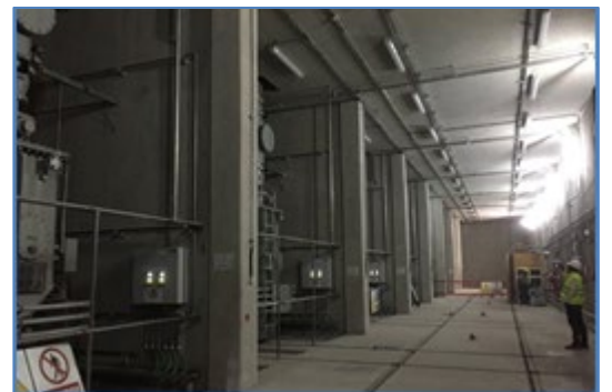
Caverna de Transformadores (9 Transformadores)
