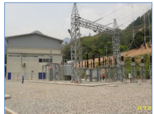
Vista de la Casa de Máquinas y Subestación
