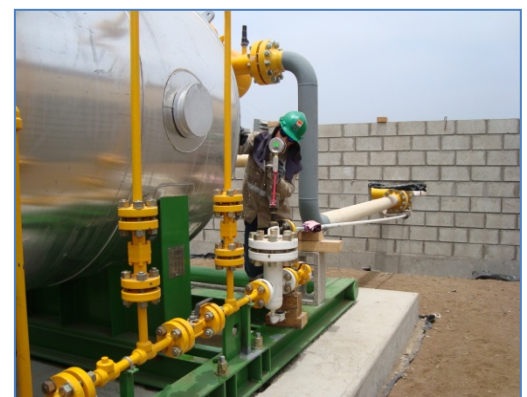
Estación de gas
