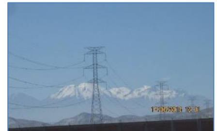
L.T. 220 kV San José – Cerro Verde
