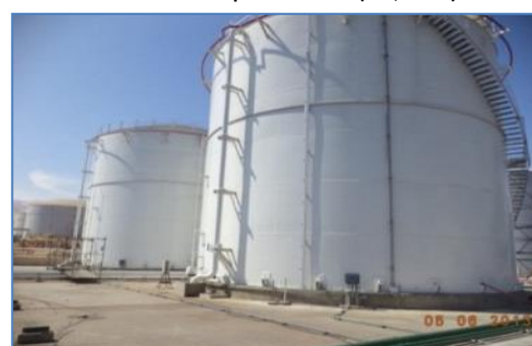
Tanques de almacenamiento de Combustible tratado B5 (2x3 000 m 3 )
