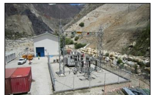
Subestación Eléctrica Manta
