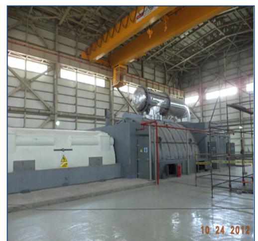
Unidad de Generación (Turbina a vapor)
