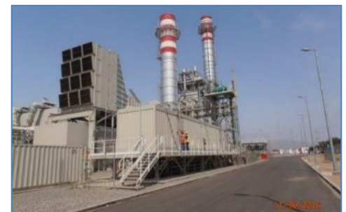
Chimeneas de los Ciclos Simple y Combinado
