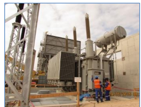
Montaje del Transformador de Potencia (S.E. Recka)
