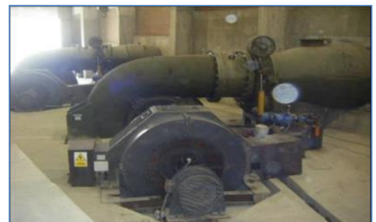
Turbina y Generador del Grupo 3
