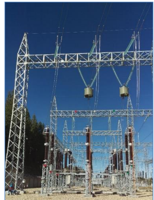
Pósito S.E. Cajamarca Norte, salida a S.E. Cáclic
