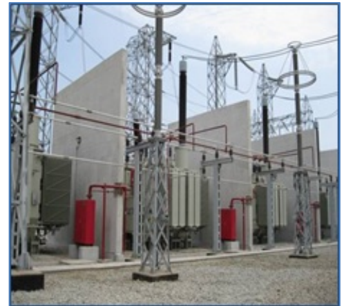
Transformadores S.E. Chilca 500 kV
