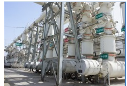
Equipo GIS del patio de 500 kV
