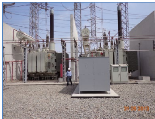
Resistencia neutro Autotransformador. 500/220 kV S.E. Chilca
