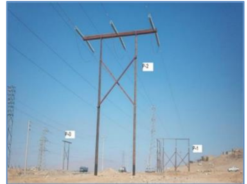
Ingreso a la S.E. Chiclayo Oeste
