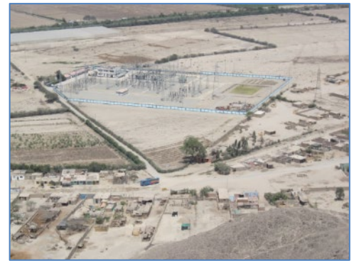
Subestación Eléctrica Ica
