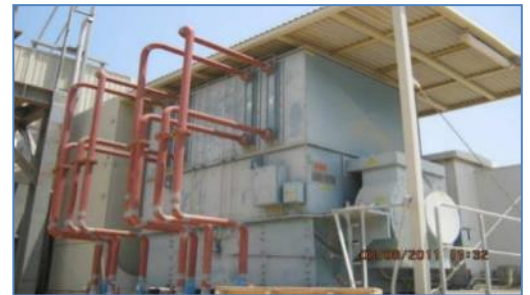
Generador Eléctrico ABB de 30 MW
