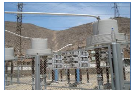
Banco de Condensadores S.E. Chavarría
