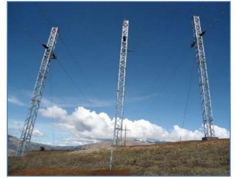
Estructura de la L.T. 60 KV S.E Andahuaylas – S.E. Chilcayoc
