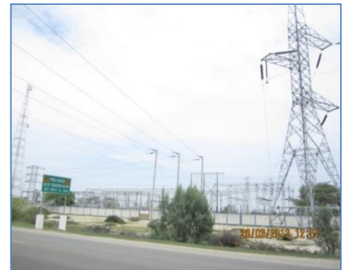
Torre N° 237 para ingreso a nueva bahía S.E. Piura
