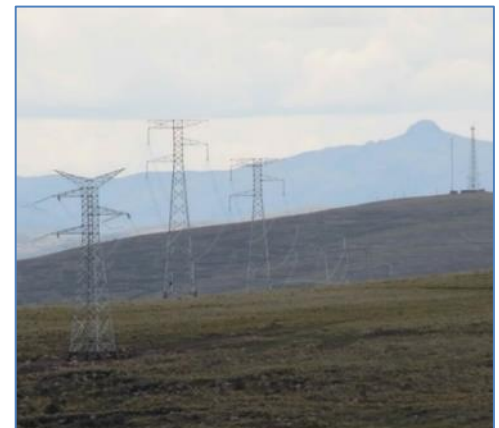
Línea de transmisión 220 kV San Román - Puno
