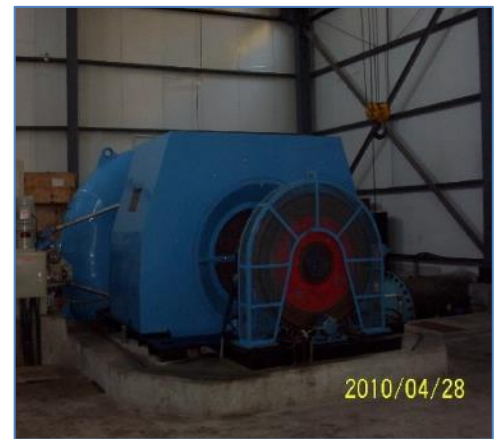
Unidad de Generación
