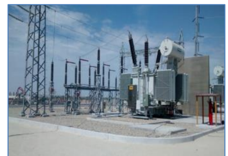
Transformador de Potencia 220/6,3 kV – 30/37,5 MVA
