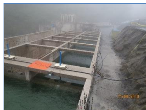
Desarenador – Compuertas de salida
