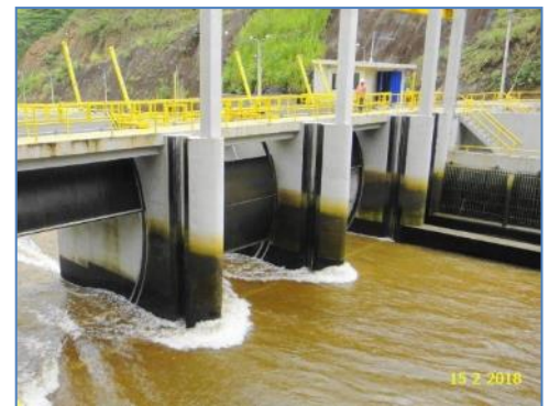
Bocatoma y sus compuertas radiales
