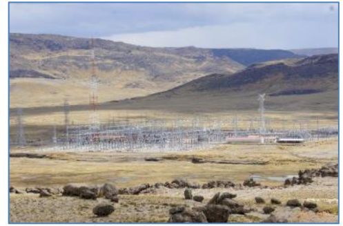
Vista de la subestación Cotaruse
