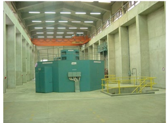
Sala de Máquinas
