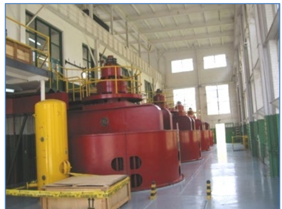
Sala de Máquinas
