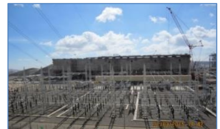
Patio 220 kV de la S.E. San Luis (Cerro Verde)
