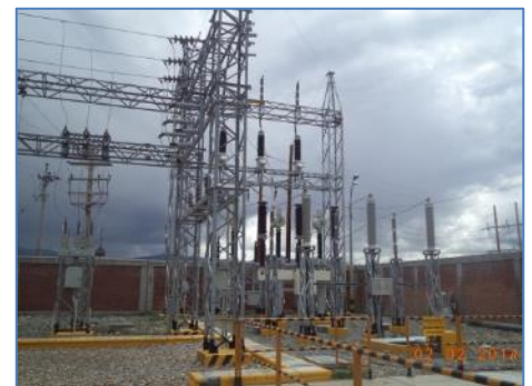
S.E Andahuaylas - Patio de Llaves
