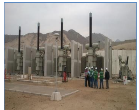
Reactores de 40 MVAR (S.E. Trujillo)
