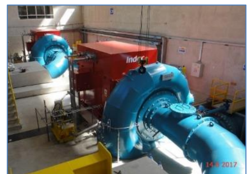
Casa de Máquinas con dos Turbinas Francis
