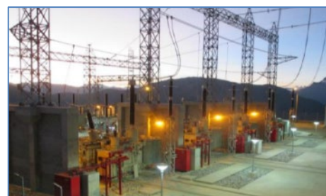
Vista Panorámica de S.E. Abancay
