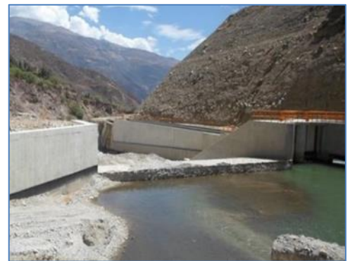
Bocatoma, Desarenador y Canal de Aducción
