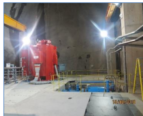
Generador 2 y válvula esférica
