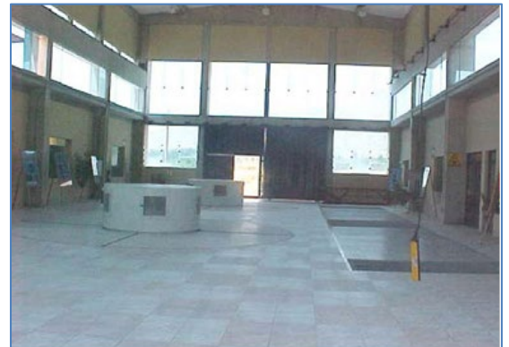
Sala de Máquinas
