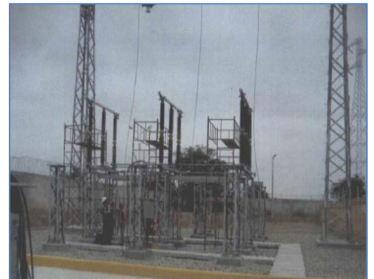
Pruebas Eléctricas al seccionador de Línea
