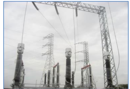
Ingreso a la S.E. Piura Oeste
