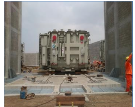
Transformador de 250 MVA (S.E. Trujillo)
