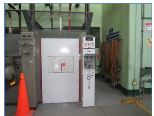
Celda de 10 kV – Punto de Conexión
