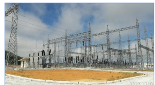
Patio de llaves de 220 kV en S.E. Belaunde Terry
