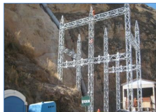
Pórtico de la S.E. Canchayllo
