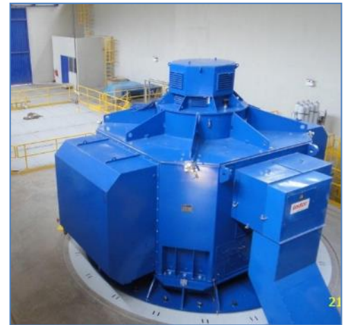
Casa de Máquinas – Generador eléctrico INDAR
