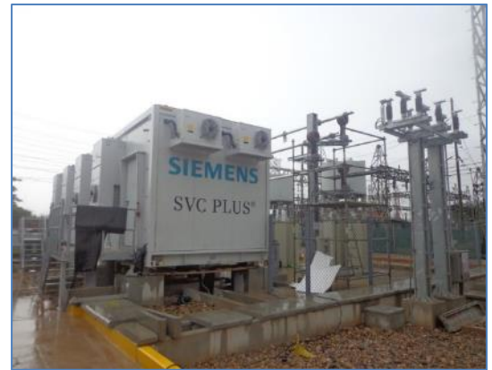
S.E. Pucallpa (SVC) - Patio SVC
