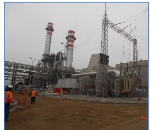
Transformador de potencia asociada a la TG
