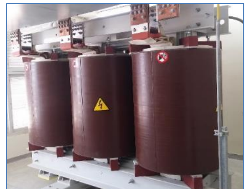
Transformador en Seco del Grupo de Generación N° 1
