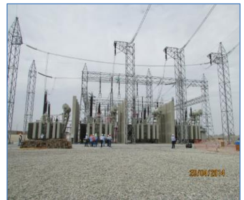
Auto transformadores monofásicos de 500/220 Kv (4 x 200 MVA c/u) – S.E. La Niña
