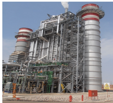
Caldera de Recuperación de Calor y Chimenea
