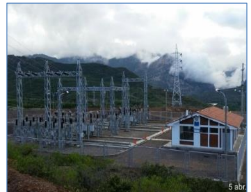
Subestación. Aguas Calientes
