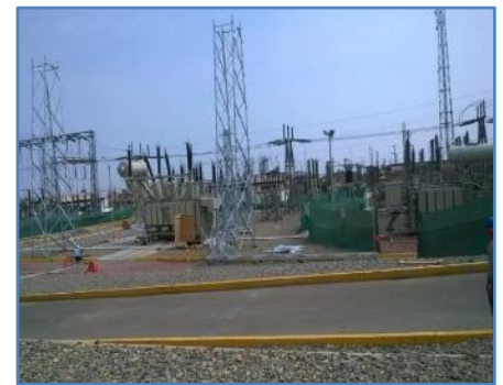
Autotransformador S.E. Trujillo
