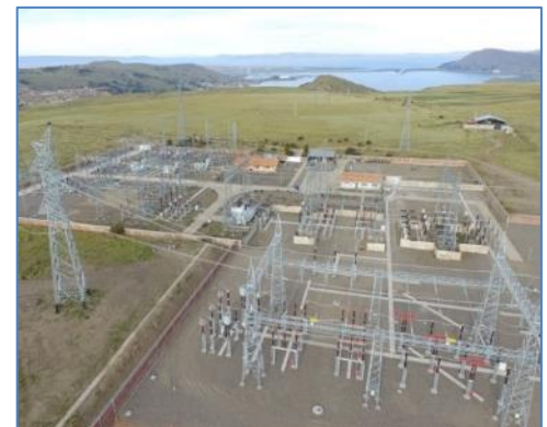
Ampliación S.E. Puno
