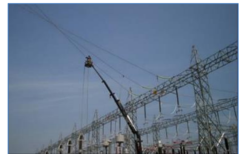
Conexión de la L.T. en la S.E. Chilca
