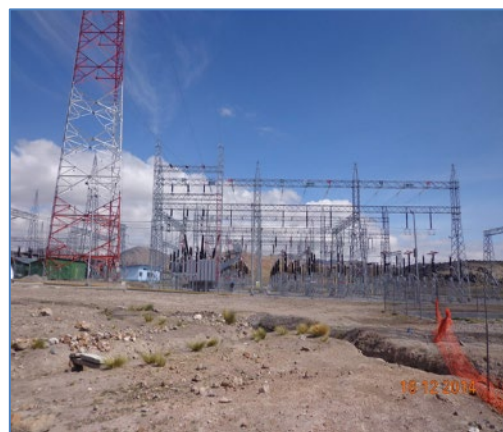
Patio de Llaves 220 kV S.E. Cotaruse
