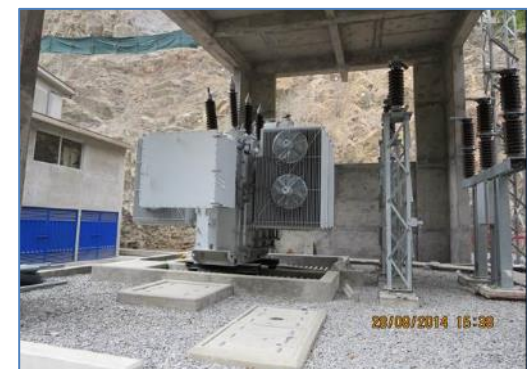
Vista del Transformador
