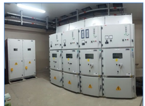
Sala de control – primer nivel
