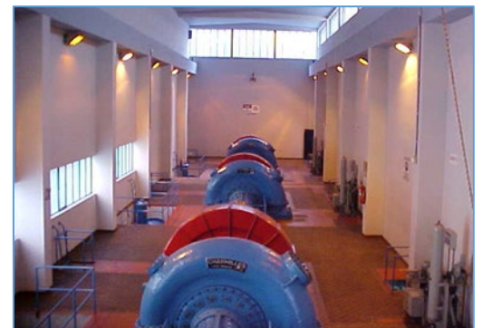
Sala de Máquinas
