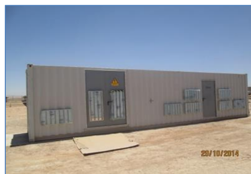
Caseta de transformador e inversores
