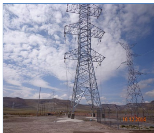
Torre N° 01 L.T., 220 kV Cotaruse-Las Bambas
