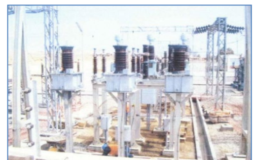
Celda 66 kV S.E. Paramonga Nueva
