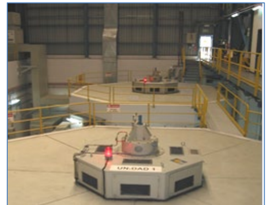
Sala de máquinas
