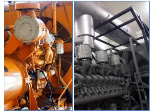
Grupo Generador Existente (izquierda) y Nuevo (derecha)
