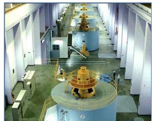
Sala de Máquinas
