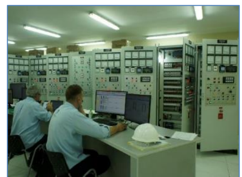
Sala de control de la C.T. Iquitos durante la energización de la L.T. 60 kV C.T. Iquitos – Iquitos existente
