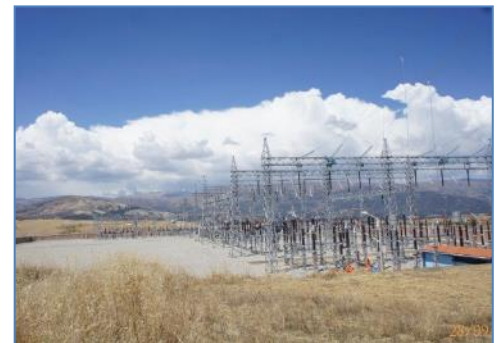
Vista de la Subestación Orcotuna
