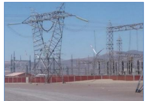
Pórtico de llegada S.E. Poroma
