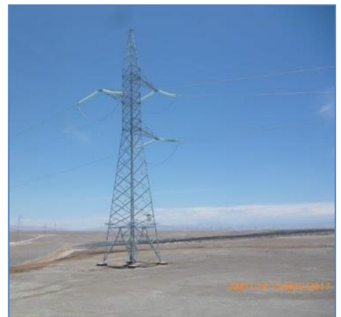
Torre de Línea de Transmisión
