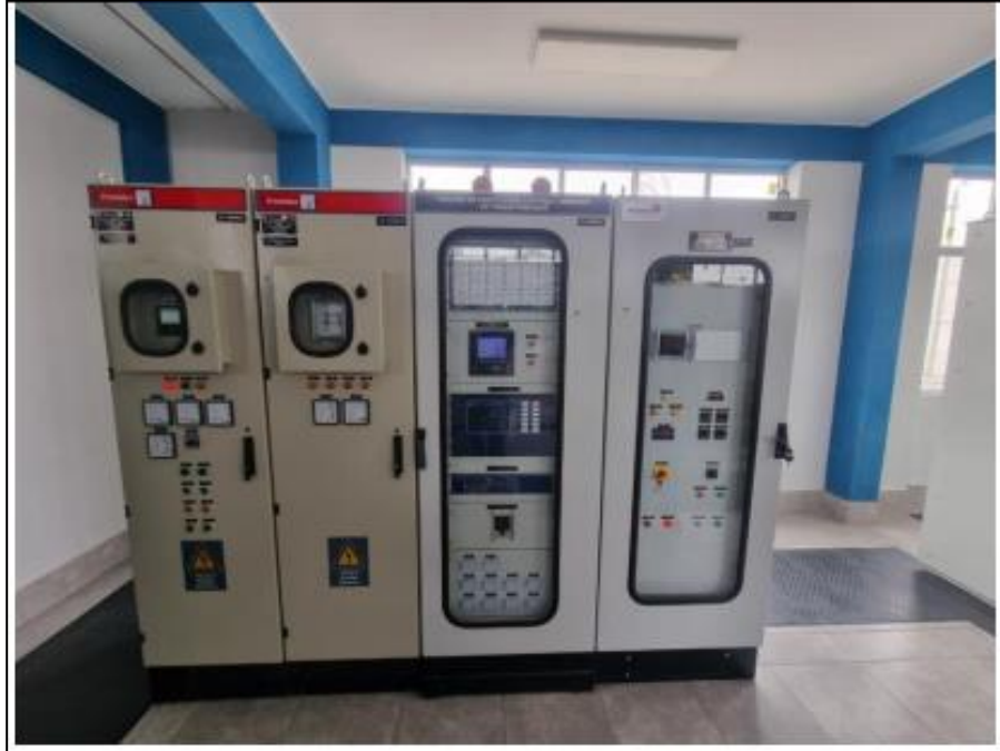
Fotografía N° 3. Tablero de Protección de control y medición de Transformador - SET Trapecio, Hidrandina
