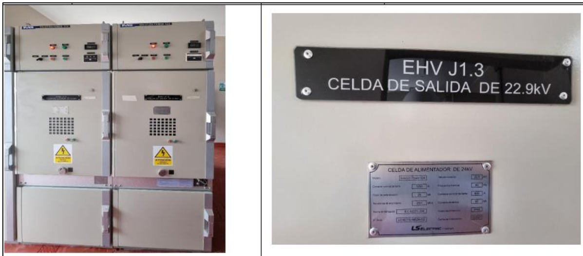
Fotografía N° 5. Celda de Alimentador 22.9 kV - SET El Carmen, Electro Dunas
