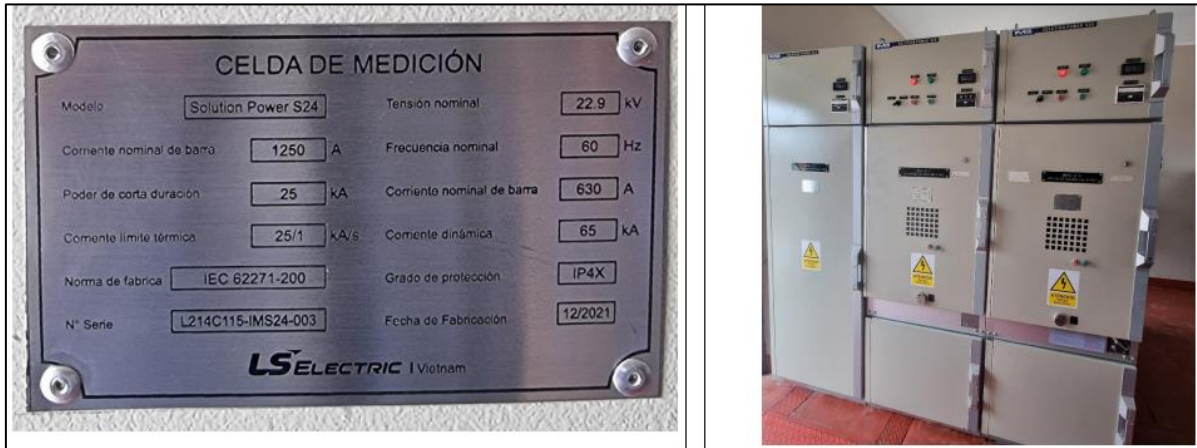
Fotografía N° 3. Celda de Medición 22.9 kV - SET El Carmen, Electro Dunas
