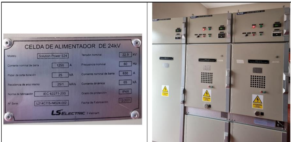
Fotografía N° 6. Celda de Alimentador 22.9 kV - SET El Carmen, Electro Dunas
