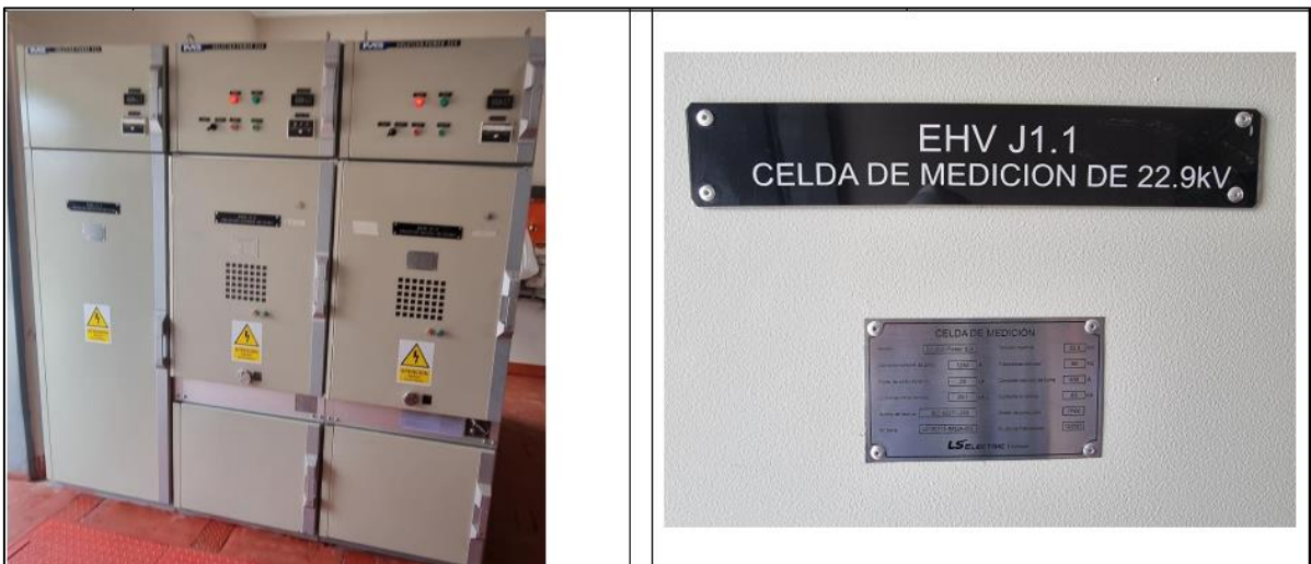
Fotografía N° 3. Celda de Medición 22.9 kV - SET El Carmen, Electro Dunas
