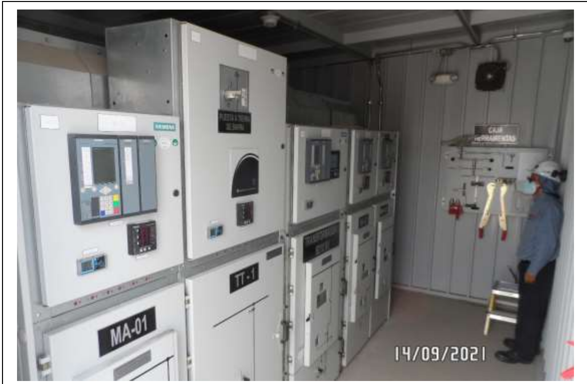
Foto 1. SET Manchay. Celdas metal clad de 10 kV.
