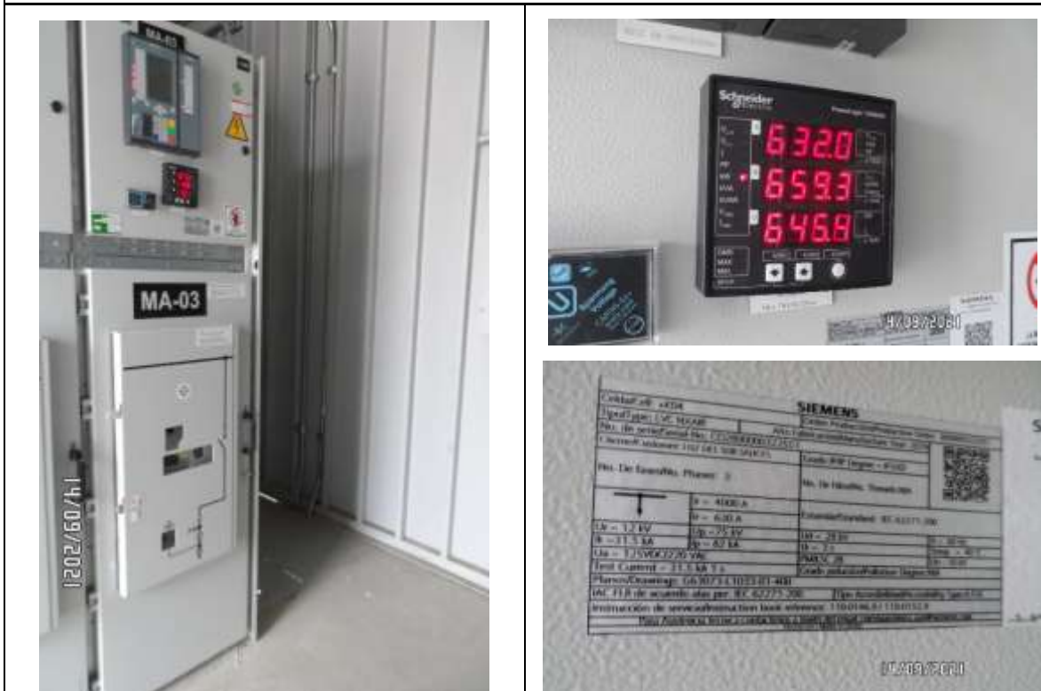
Foto 2. SET Manchay. Celda de alimentador MA-03.
