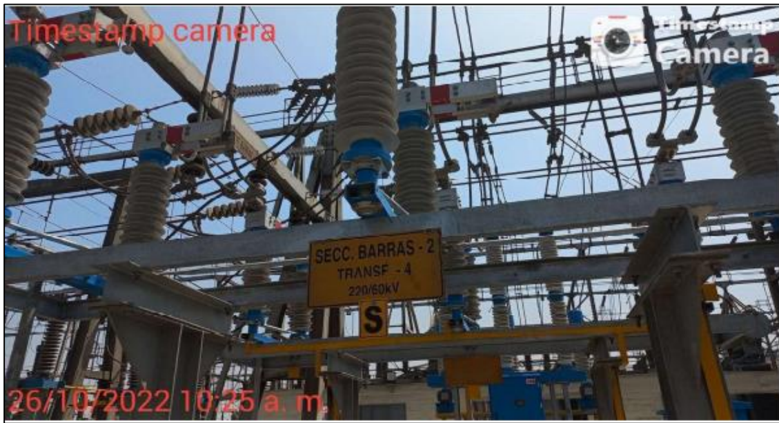
Fotografía N° 4. Seccionador de Barra Instalado TR4 - SET El Chavarría, Enel DP
