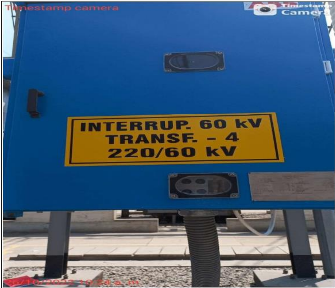
Fotografía N° 2. Placa del Transformador TR4 60 kV - SET El Chavarría, Enel DP
