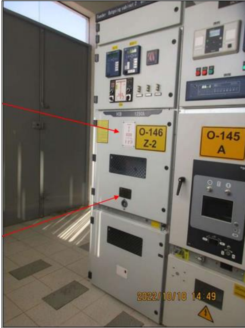
Fotografía N° 3. Celda de Alimentador en 10 kV - SET Tacna, ElectroSur
