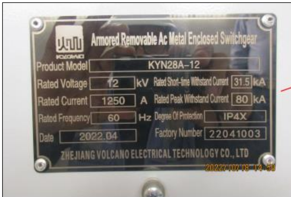
Fotografía N° 4. Placa de celda de Alimentador en 10 kV - SET Tacna, ElectroSur
