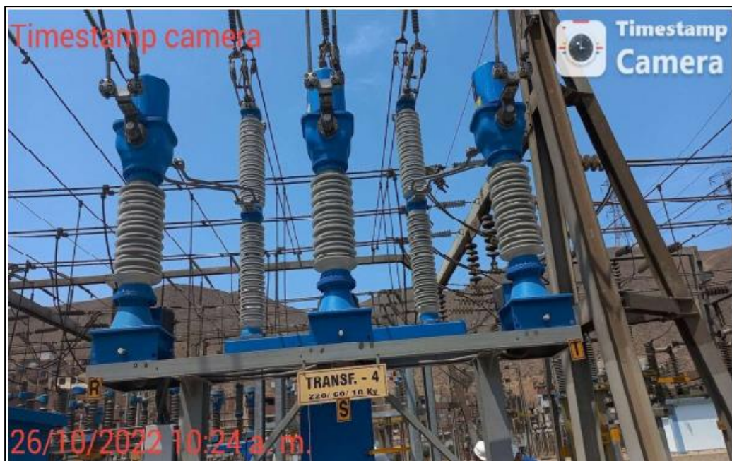
Fotografía N° 5. Transformador de Corriente combinados instalados 3 - SET El Chavarría, Enel DP
