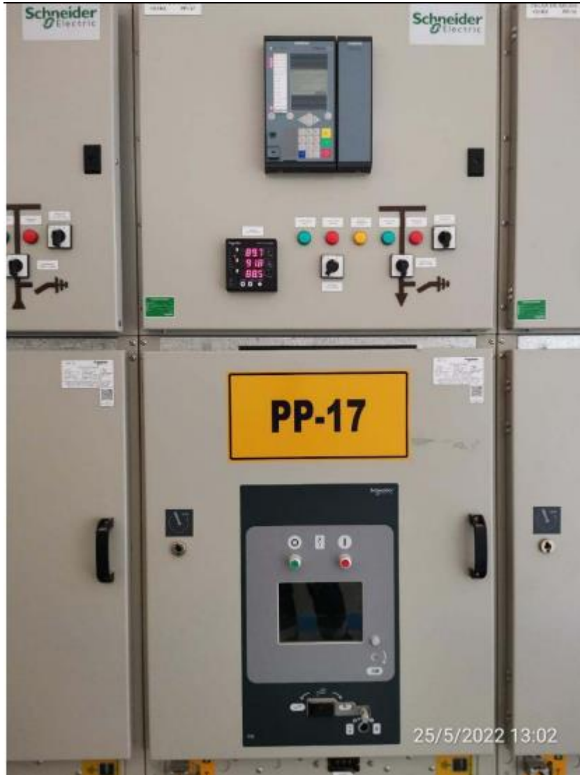
Fotografía N° 3. Vista frontal de la celda de alimentador PP-17 10KV (Alta) SET Puente Piedra, Enel DP
