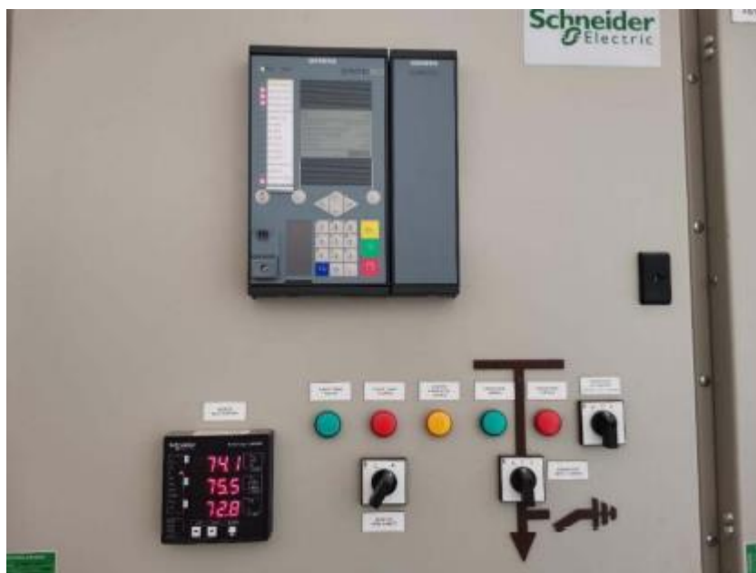
Fotografía N° 4. Vista de sistema de medición y relé de protección instalado en la celda de alimentador PP-17 10KV (Alta) SET Puente Piedra, Enel DP
