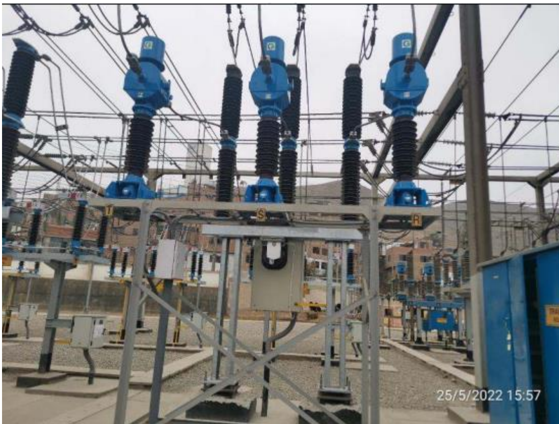
Fotografía N° 5. Vista de celda de transformador (Celda TR1 60/10 kV) SET Chavarría, Enel DP
