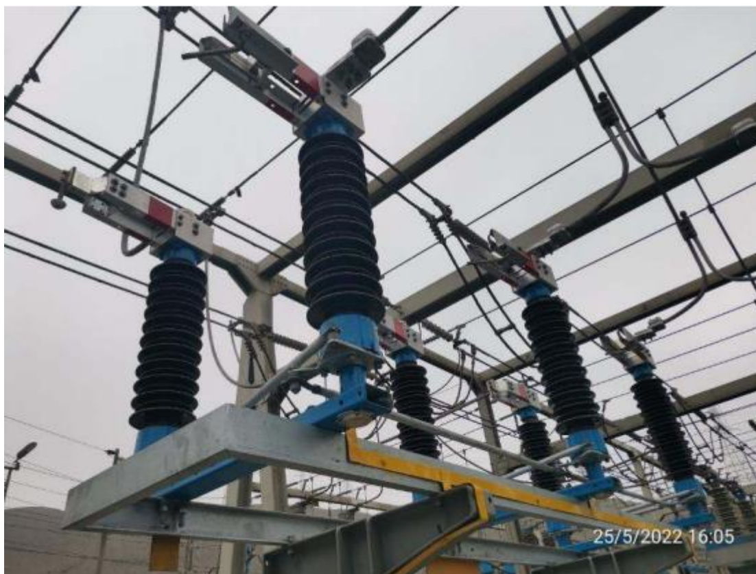
Fotografía N° 6. Vista de Seccionador de Barra II SET Chavarría, Enel DP
