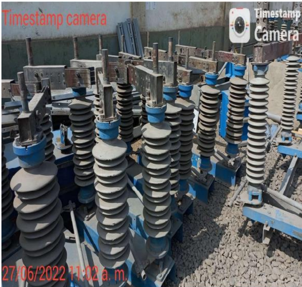
Fotografía N° 6. Seccionadores de celda transformador TR2 desinstalados SET Chavarria, Enel DP
