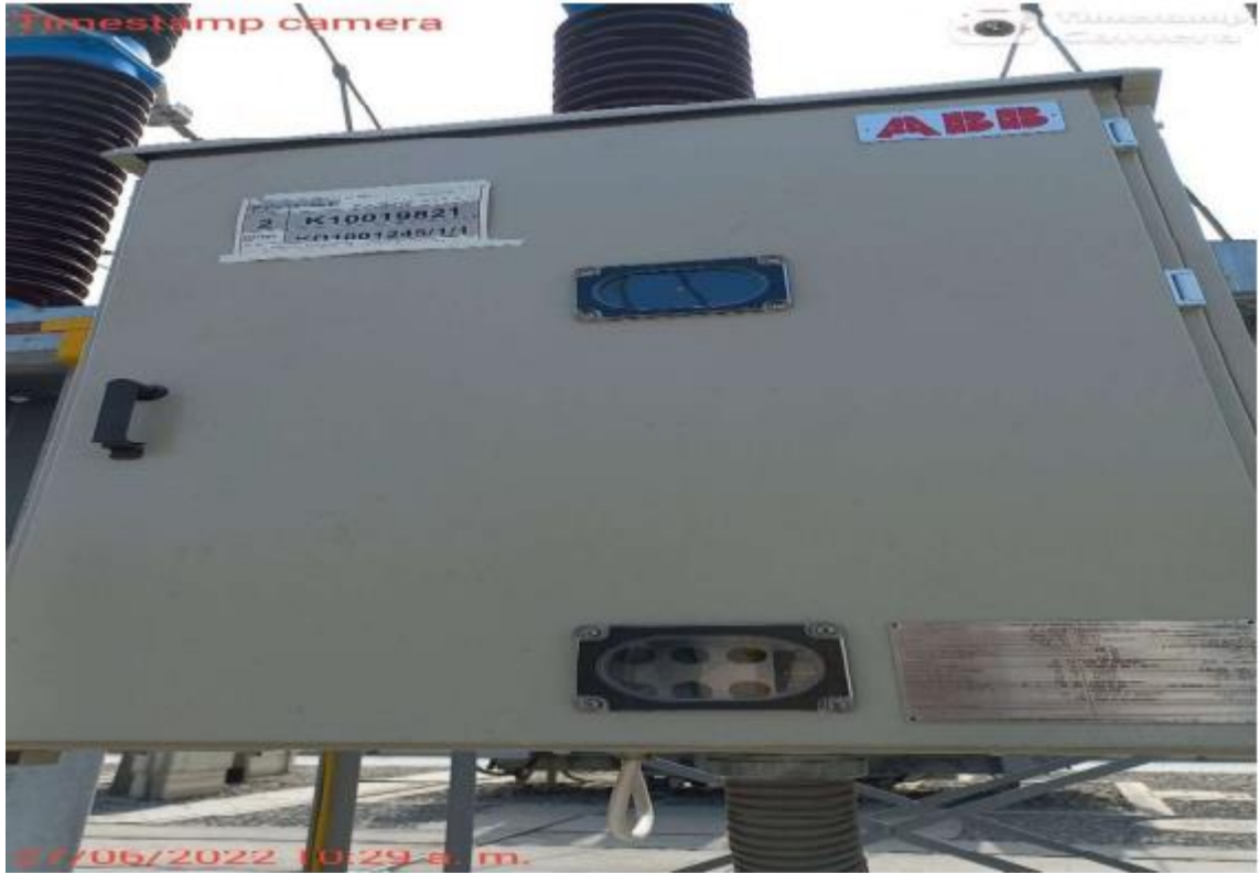
Fotografía N° 5. Interruptor de potencia Transformador 2 SET Chavarria, Enel DP
