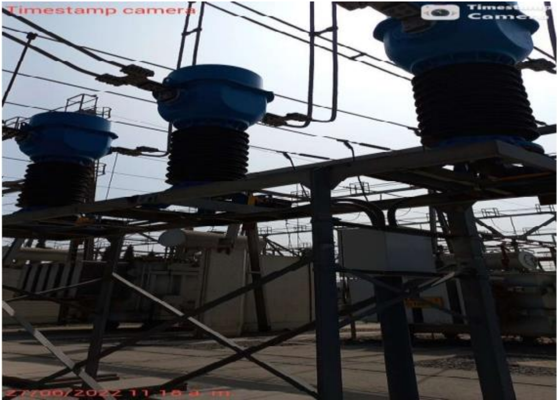
Fotografía N° 9. Transformador de Corriente Acoplamiento lado 60 kV SET Chavarria, Enel DP
