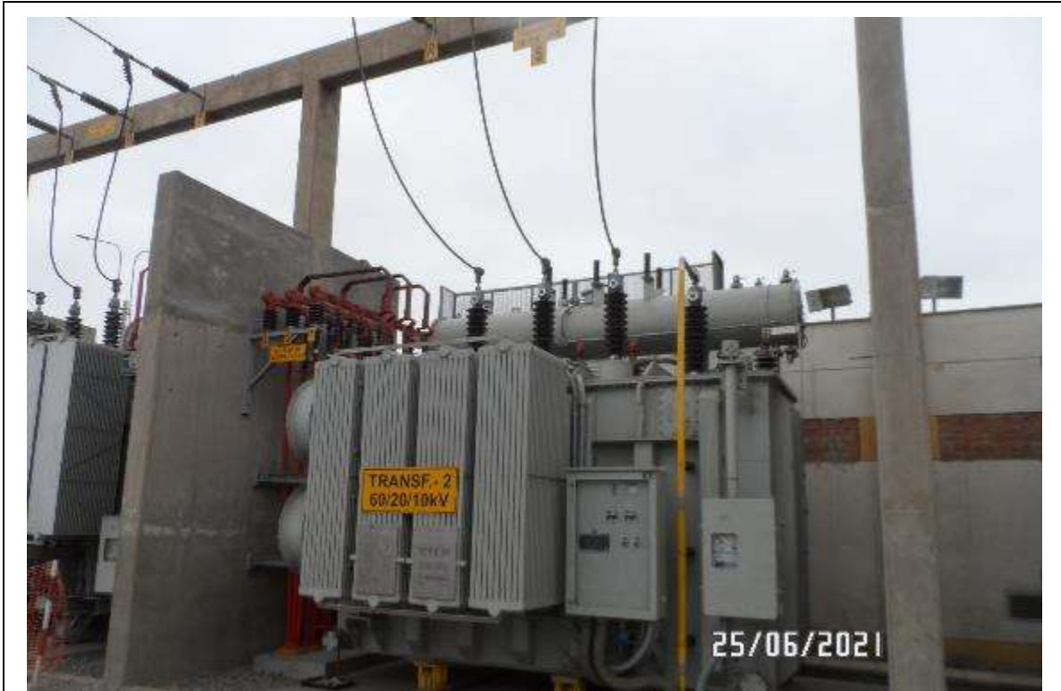
Foto 1. SET Industrial. Transformador de potencia de 40 MVA, con placa de características instalada.
