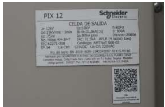
Fotos 3 y 4. SET Mariátegui. Placa del interruptor extraíble (arriba) y placa de la celda (abajo). Año fabricación 2019.
