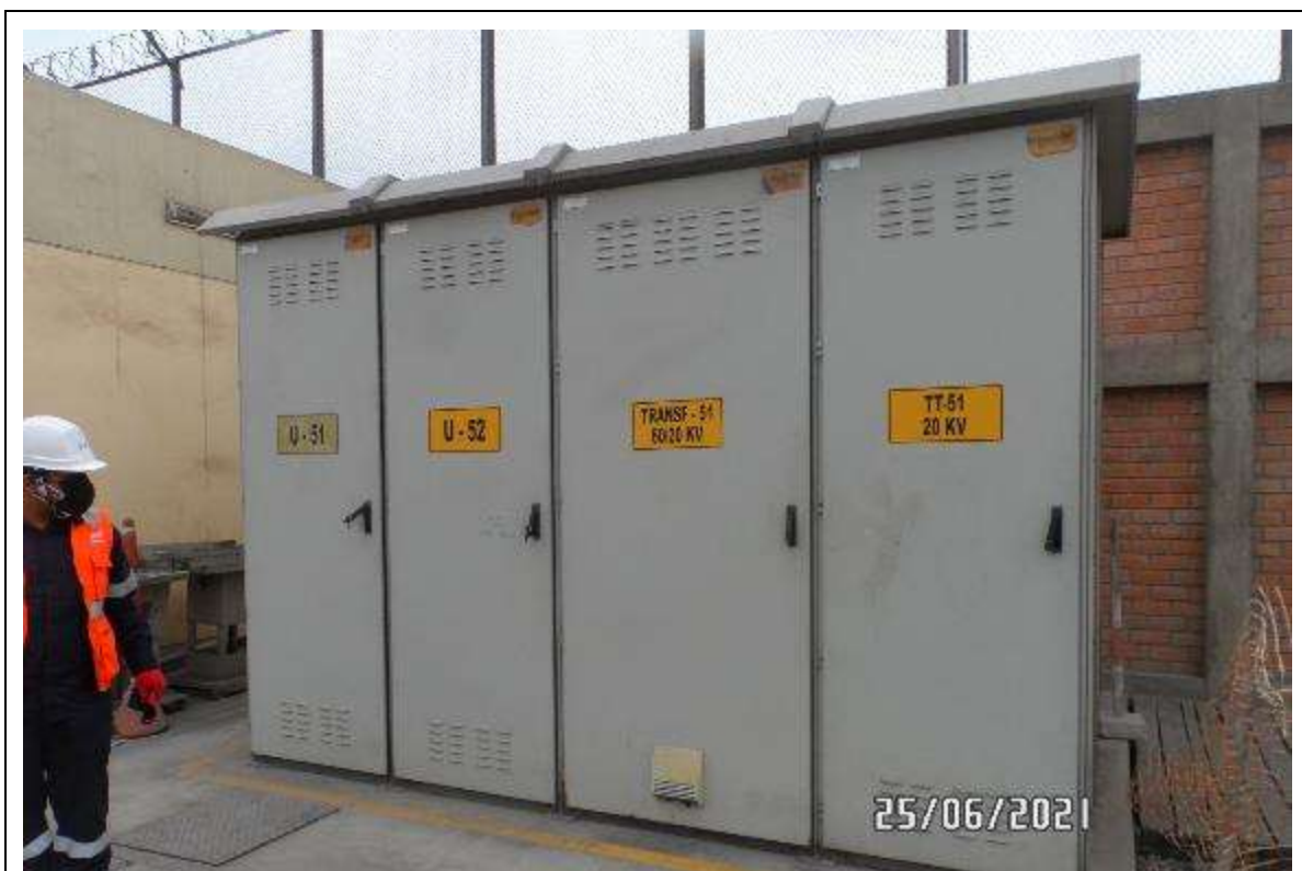
Foto 2. SET UNI. Celdas 20 kV. Elemento supervisado: U-52
