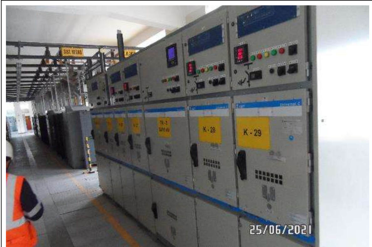
Foto 1. SET Barsi. Celdas 10 kV. Elementos supervisados: K-26, K-27, K-28 y K-29.
