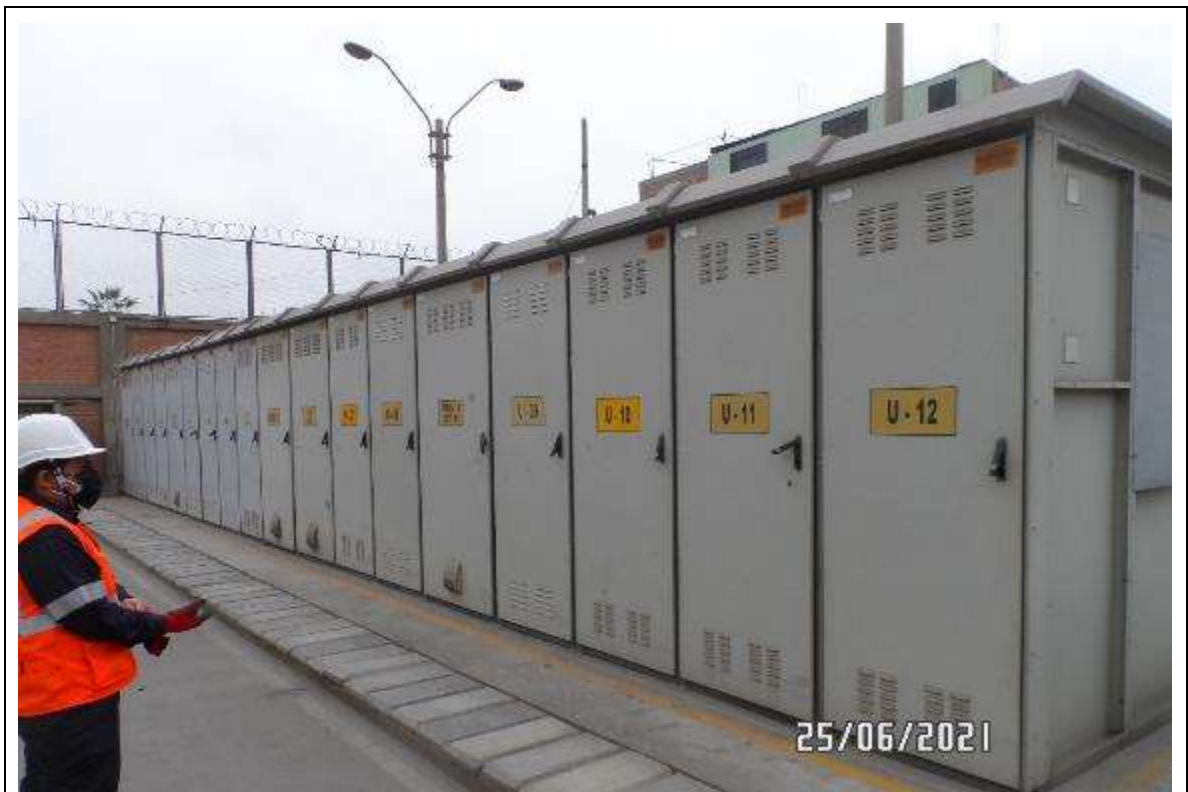
Foto 1. SET UNI. Celdas 10 kV. Elemento supervisado: Celda U-11
