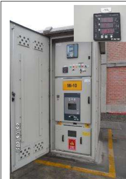
Foto 2. SET Mariátegui. Celda de alimentador MI-10, tipo metal clad, exterior, simple barra.
