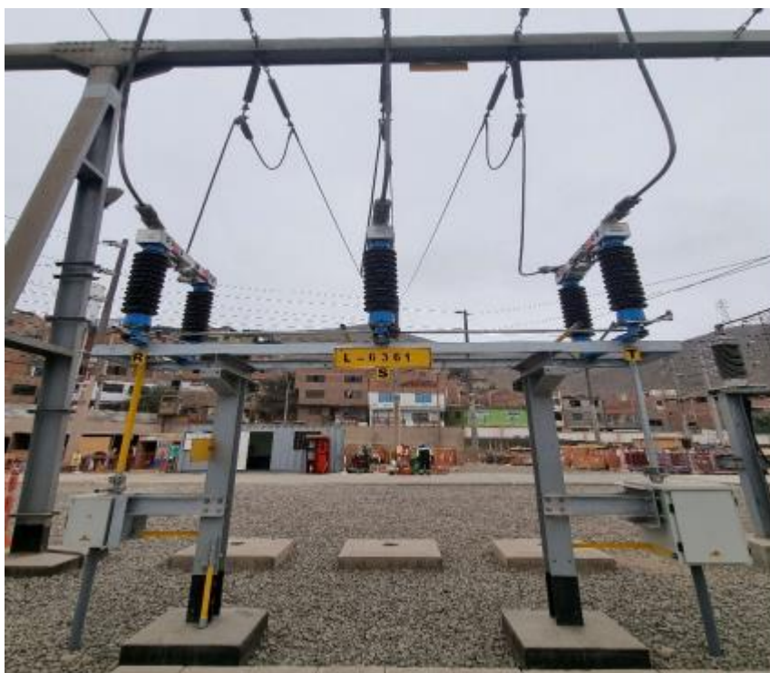
Fotografía N° 6. Seccionadora de línea de la celda de línea L-6361 SET Chavarria, Enel DP
