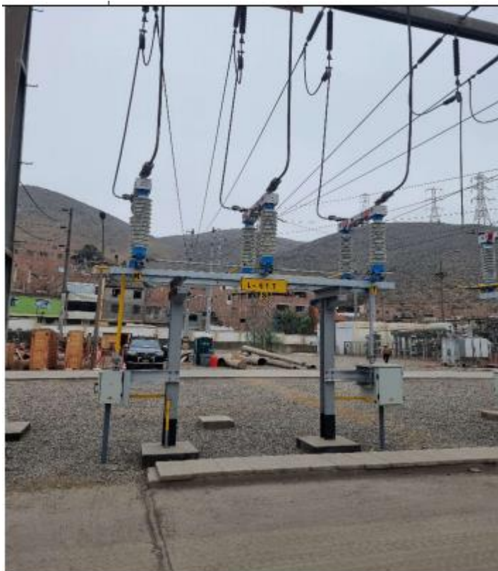
Fotografía N° 3. Seccionador de línea de la celda de línea L-617 SET Chavarria, Enel DP
