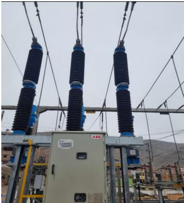
Fotografía N° 5. Interruptor de potencia de la celda de línea L-6361 SET Chavarria, Enel DP
