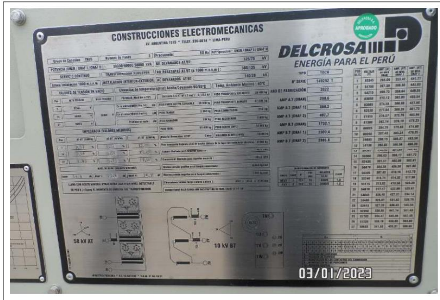
Fotografía N° 2. Placa del Transformador de Potencia 30/40/50 MVA 60/10 kV - SET Barranco, Luz del Sur
