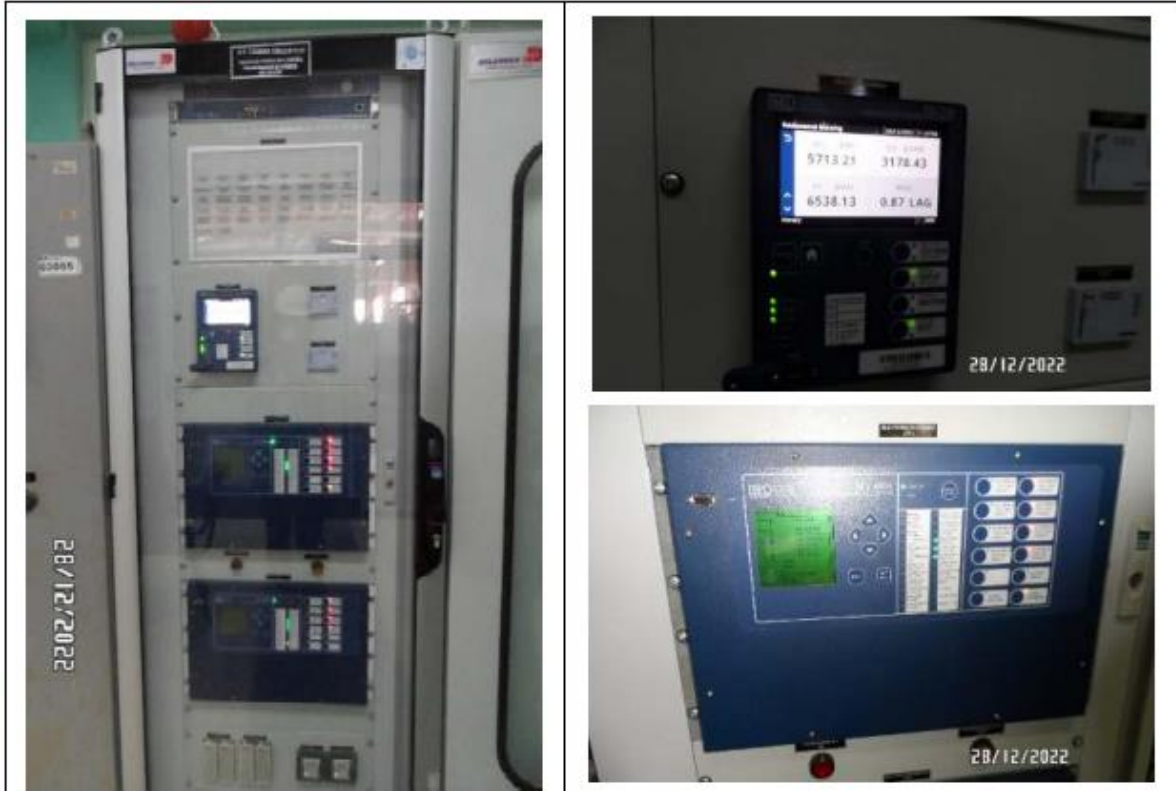
Foto 5. SET La Pampa (Camaná). Tablero de protección y control de transformador de 30 MVA.
