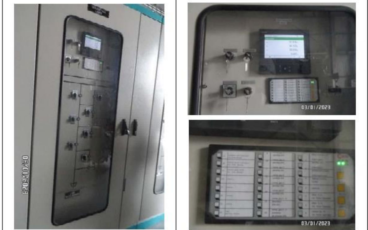
Foto 11. SET Pachacútec. Celda de línea (L-6465) 60 kV. Tablero de medición.
