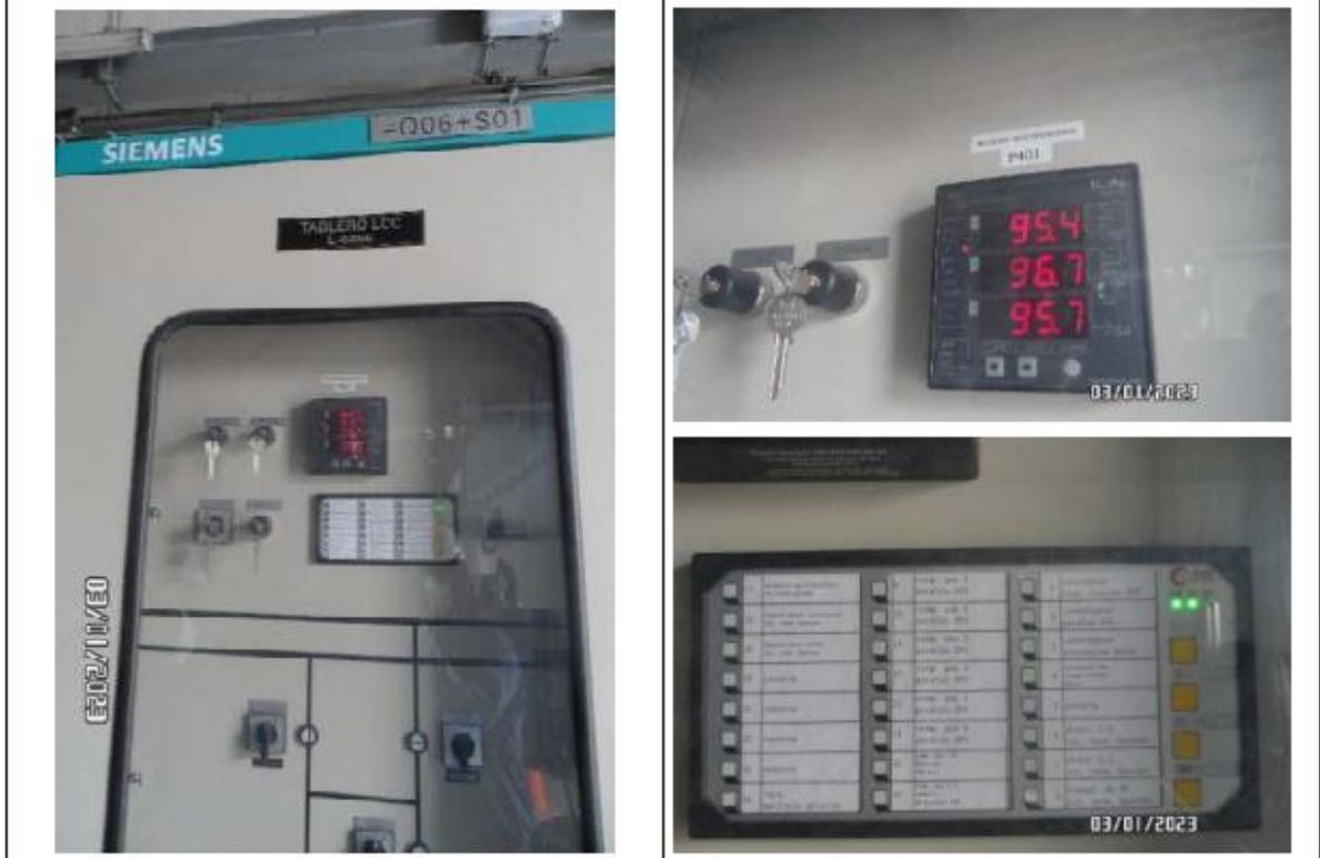
Foto 6. SET Pachacútec. Celda de línea (L-6466) 60 kV. Tablero de medición.
