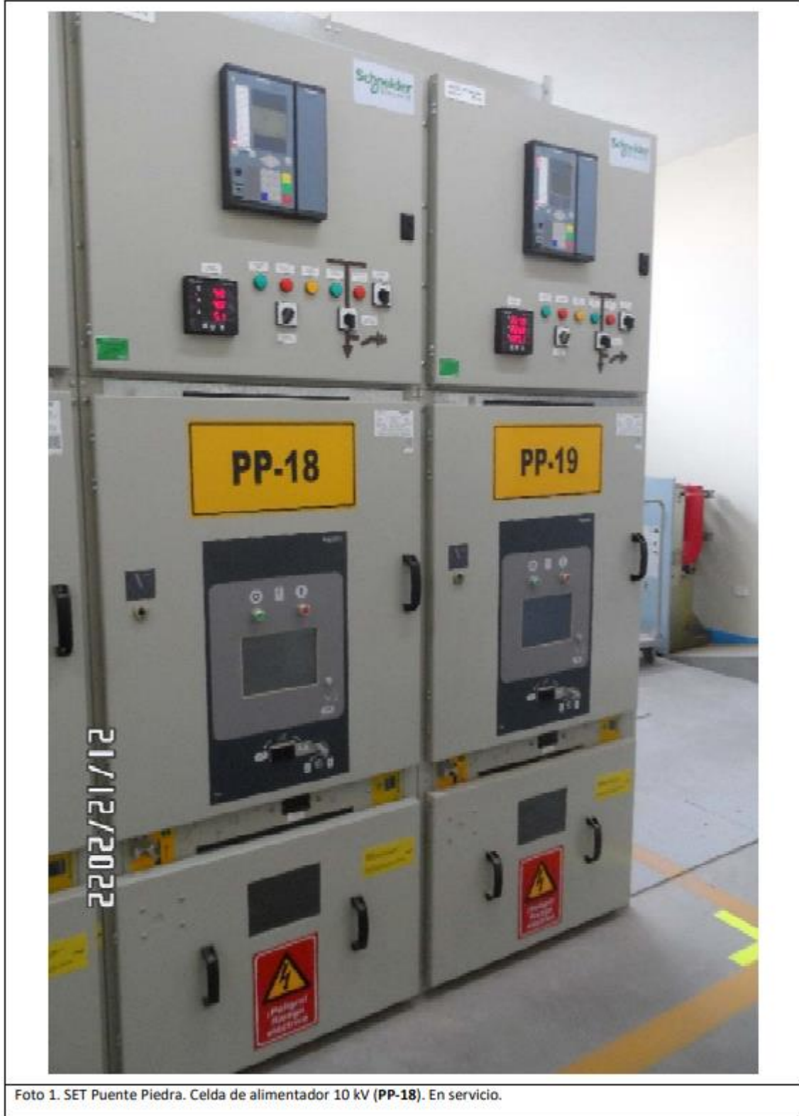
Fotografía N° 1. Celda de Alimentador 10 kV - SET Puente Piedra, ENEL DP
