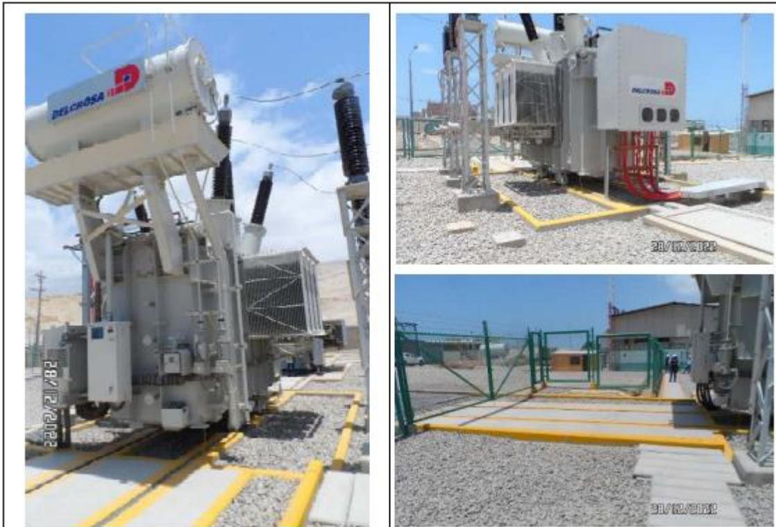
Foto 1. SET La Pampa (Camaná). Nuevo Transformador de potencia de 138/23/10 kV, 30 MVA.
