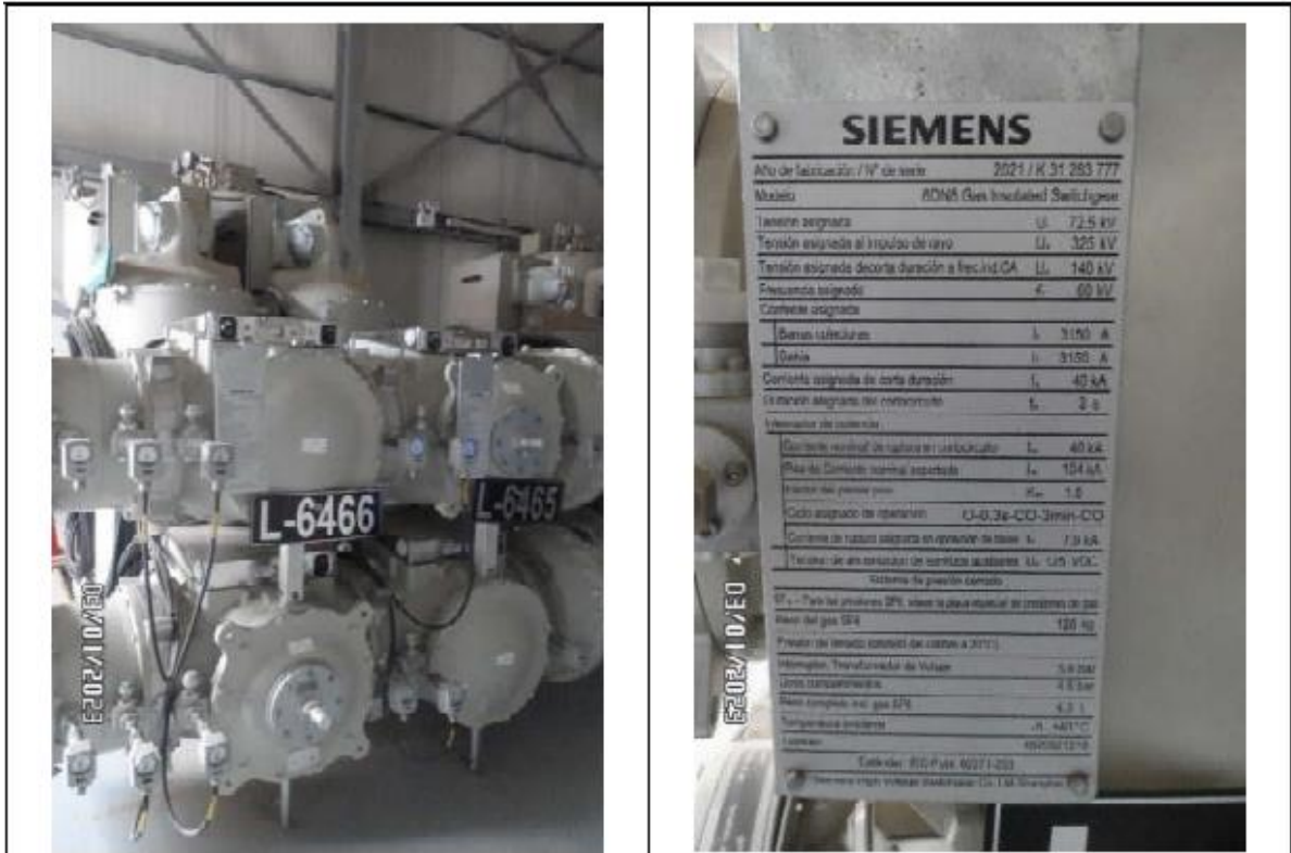
Foto 4. SET Pachacútec. Celda de línea (L-6466) 60 kV. Encapsulada (GIS), interior, simple barra.
