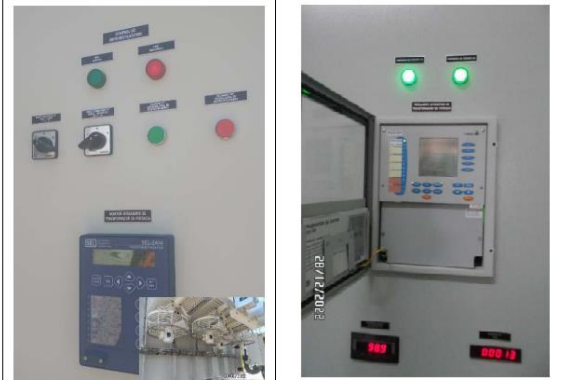
Foto 8. SET La Pampa (Camaná). Tablero de control de motoventiladores.
