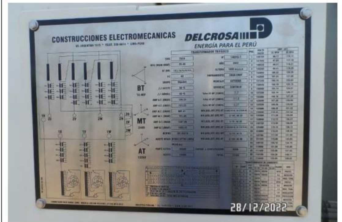
Foto 4. SET La Pampa (Camaná). Placa de características del Nuevo Transformador de potencia de 138/23/10 kV, 30 MVA.
