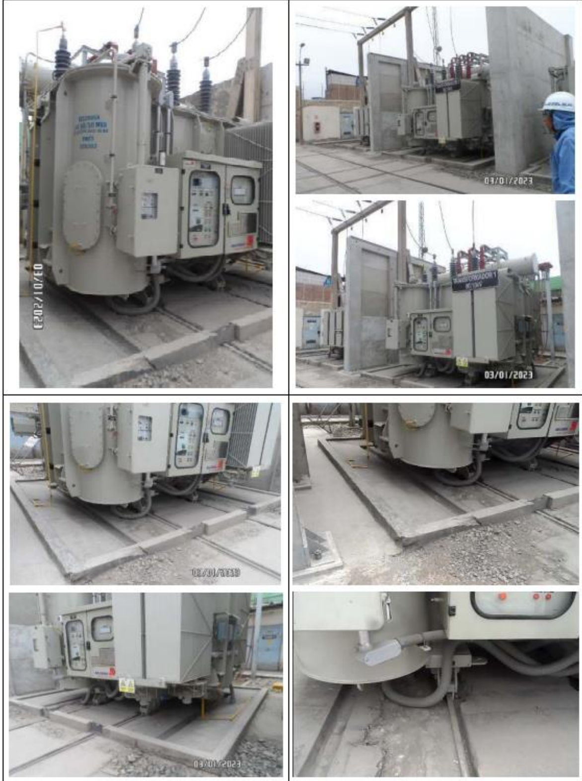
Fotografía N° 1. Transformador de Potencia 30/40/50 MVA 60/10 kV - SET Barranco, Luz del Sur
