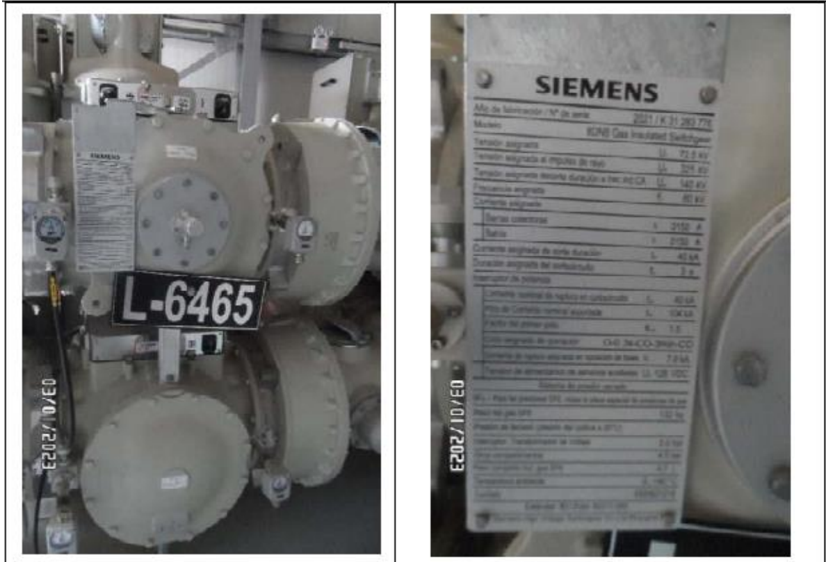
Foto 9. SET Pachacútec. Celda de línea (L-6465) 60 kV. Encapsulada (GIS), interior, simple barra.
