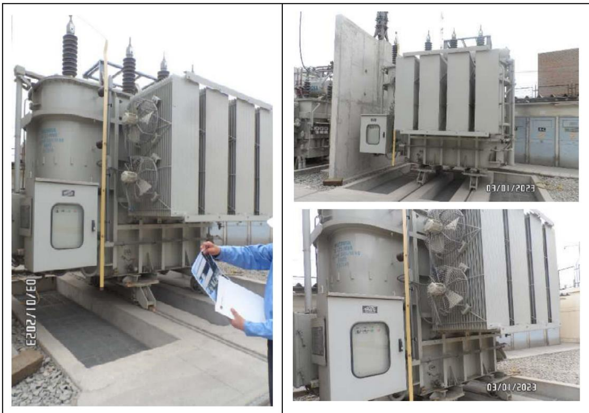
Fotografía N° 3. Transformador de potencia 25 MVA, 60/10 kV retirado de servicio- SET Barranco, Luz del Sur
