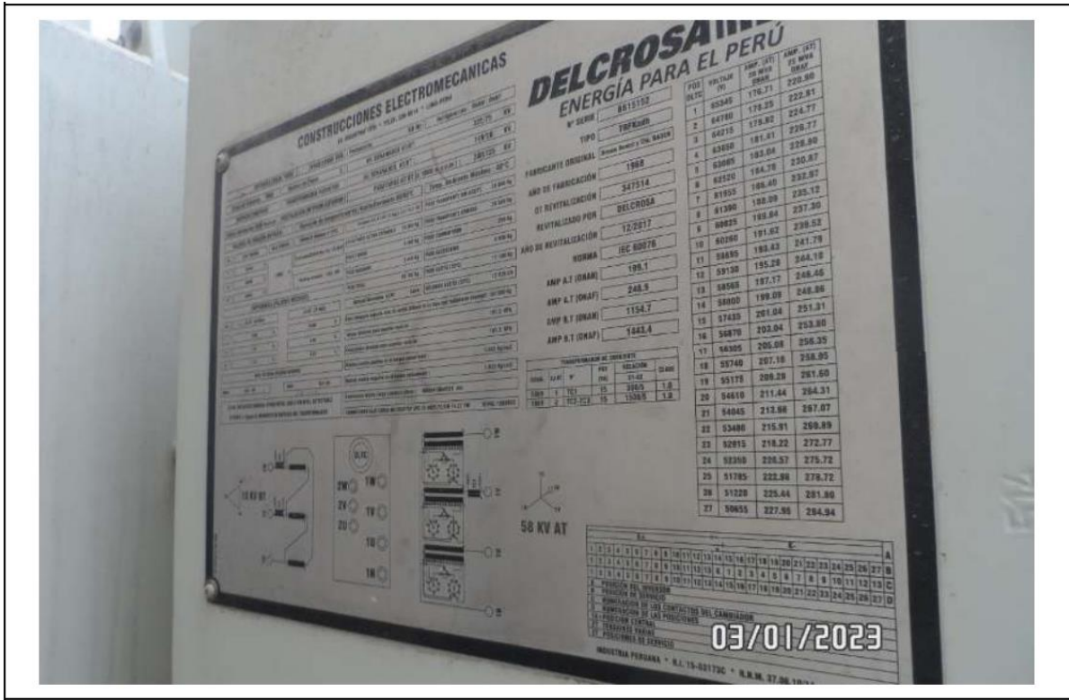
Fotografía N° 4. Placa del Transformador de Potencia 25 MVA, 60/10 kV retirado de servicio- SET Barranco, Luz de Sur
