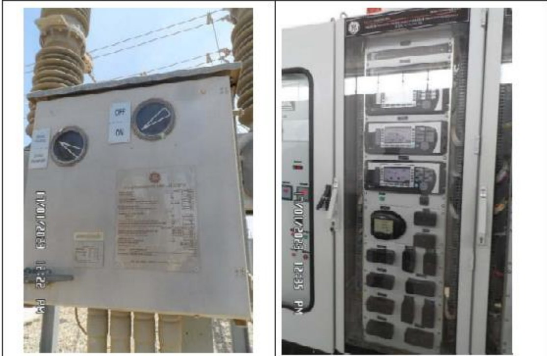
Foto 2. SET Paita Industrial. Celda de transformador 60 kV. Placa de interruptor.
