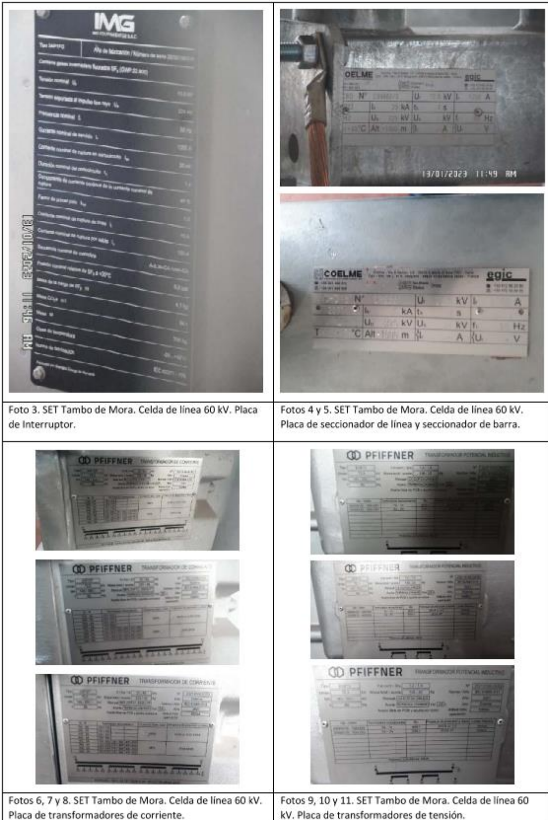
Imagen N° 4. Fotografías de la inspección realizada a la Celda de línea 60 kV de la SET Tambo de Mora, Electro Dunas
