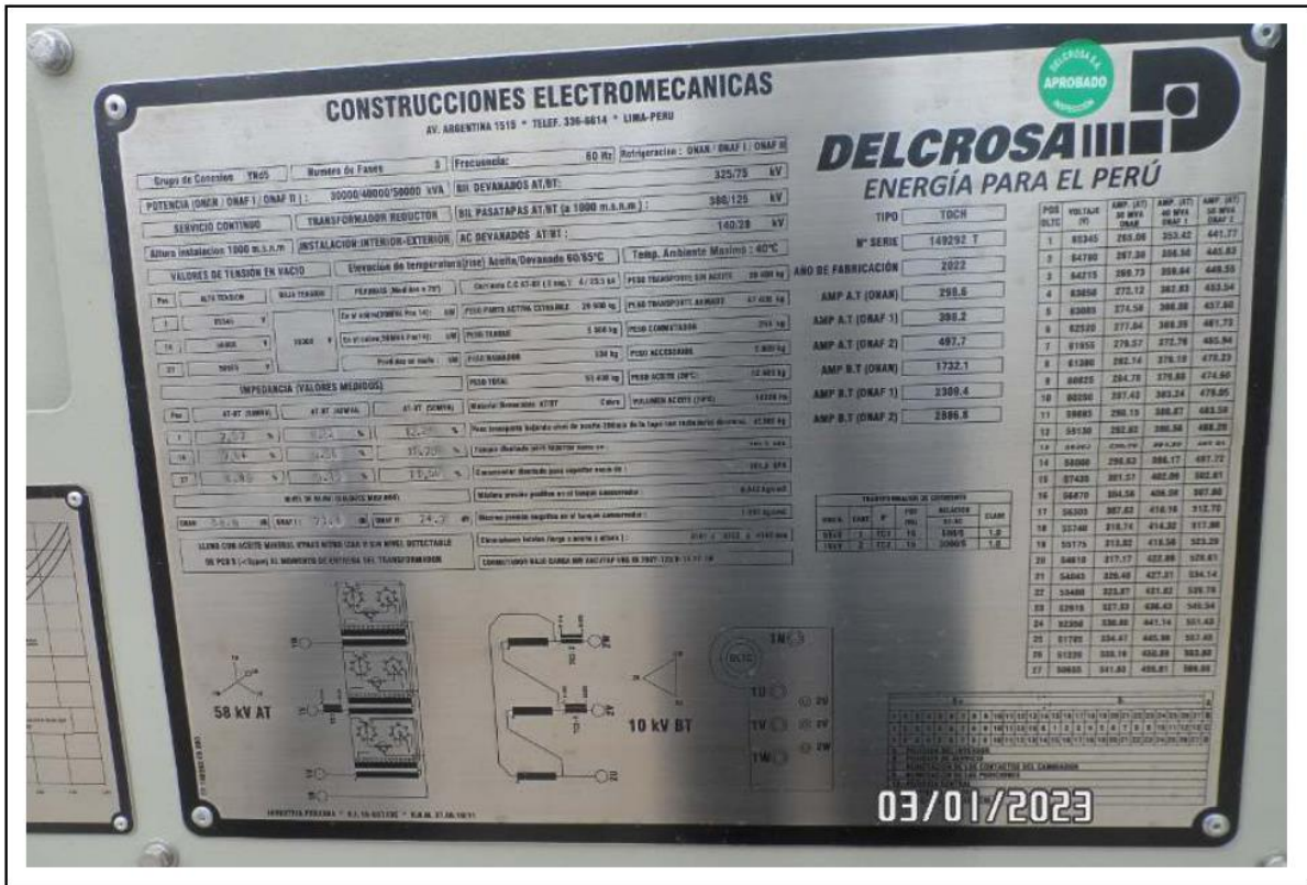
Fotografía N° 2. Placa del Transformador de Potencia 30/40/50 MVA, 60/10 kV - SET Barranco, Luz del Sur
