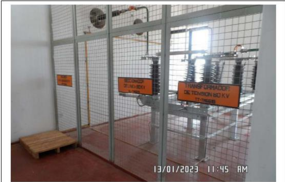
Foto 1. SET Tambo de Mora. Celda de línea 60 kV. En servicio. En la vista el seccionador de línea y transformador de tensión.
