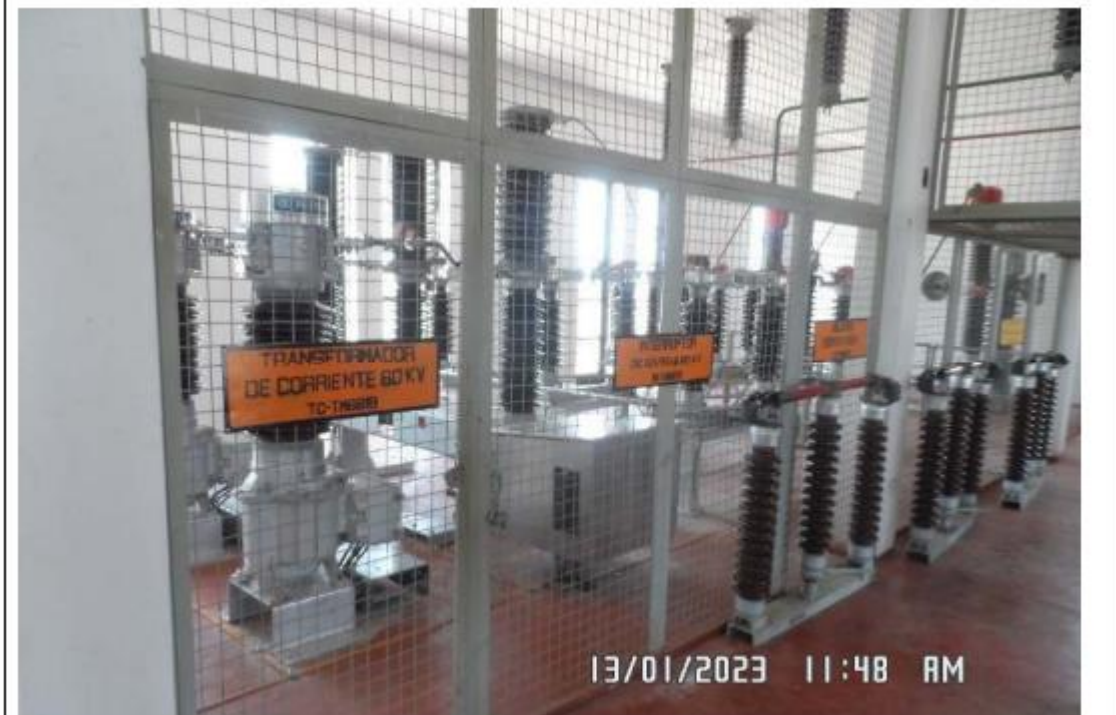
Foto 2. SET Tambo de Mora. Celda de línea 60 kV. En servicio. En la vista el transformador de corriente, interruptor, seccionador de barra.
