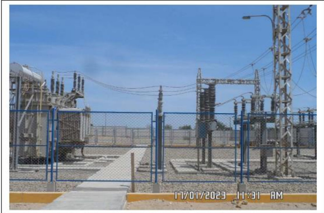
Foto 1. SET Paita Industrial. Celda de transformador 60 kV. En servicio. En la vista el pararrayos, interruptor y seccionador de barra. Se usando los TC's internos del transformador de potencia.
