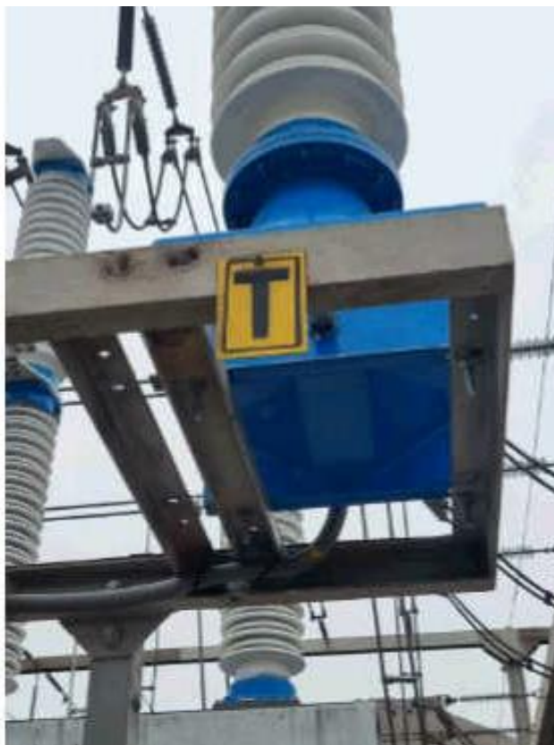
Fotografía N° 3. Transformador de corriente de línea de la celda de TR1 - SET Chavarria, Enel DP
