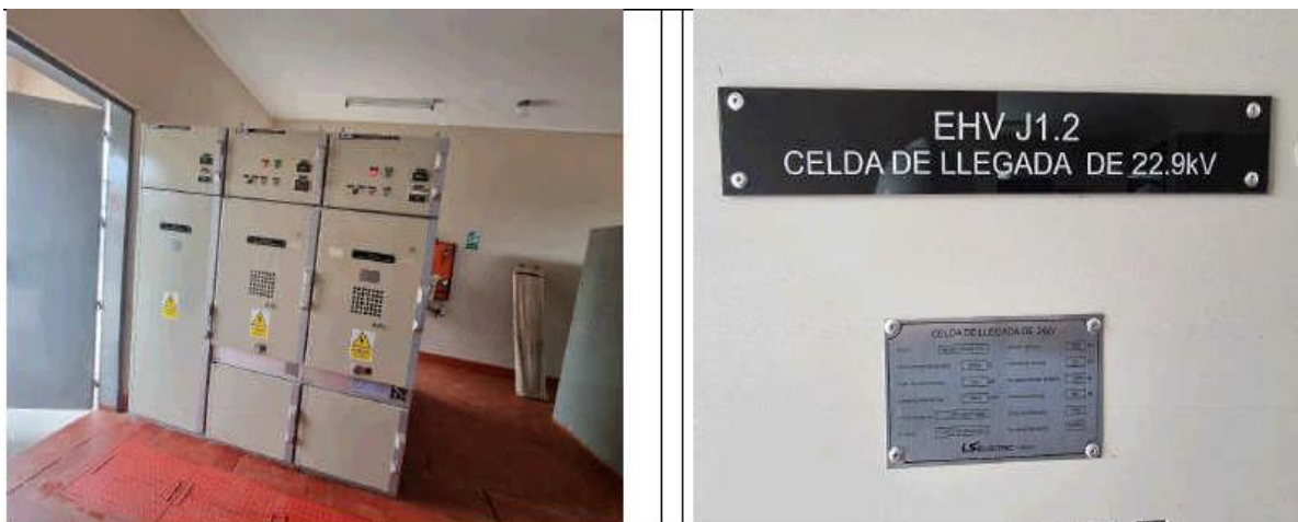
Fotografía N° 4. Celda de Transformador 22.9 kV, CE-023COMCISBTR - SET El Carmen, Electro Dunas
