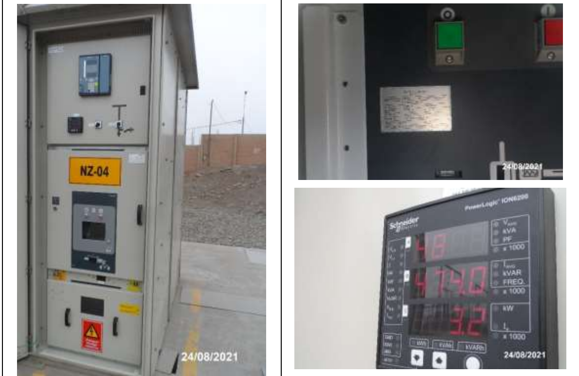
Foto 4. SET Huarangal. Celda de alimentador 10 kV (NZ-04). Celda metal clad, instalación exterior, simple barra
