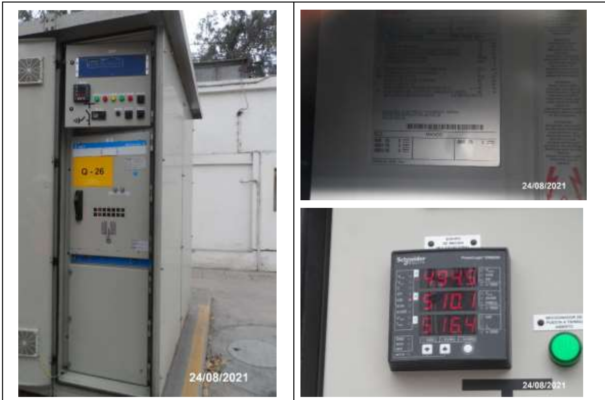
Foto 1 SET Pershing. Celda de alimentador 10 kV (Q-26). Celda metal clad, instalación exterior, simple barra.
