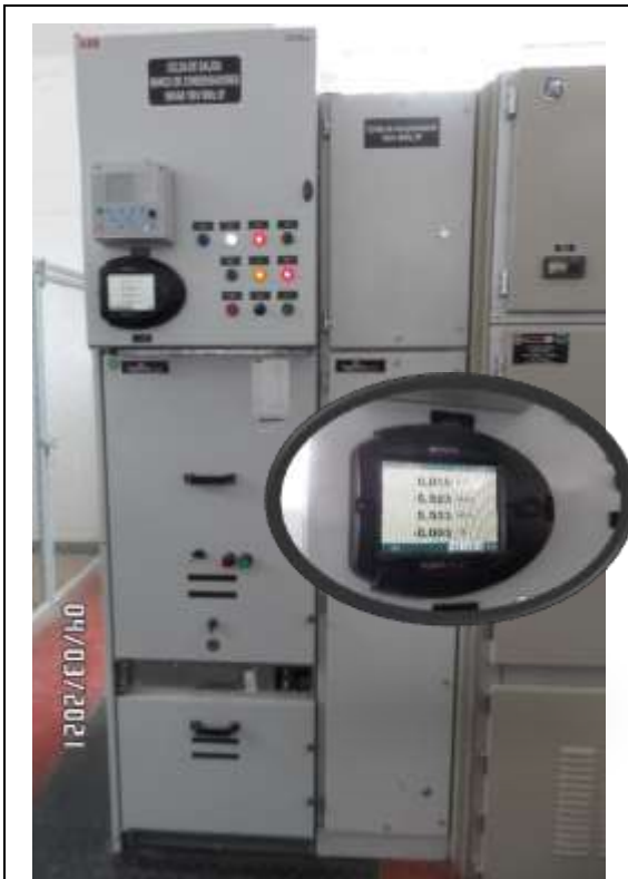
Foto 2. SET SULLANA. Celda de compensador 10 kV, tipo metal clad, interior, simple barra.
