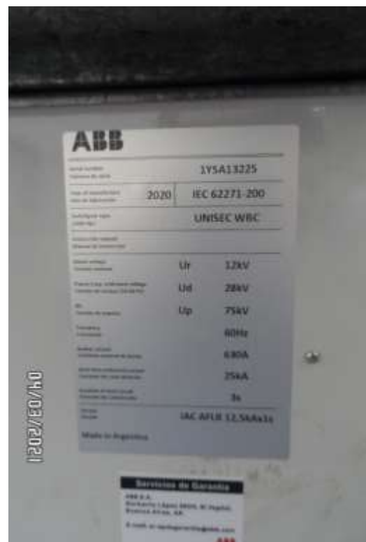
Foto 3. SET SULLANA. Placa de celda de compensador.
