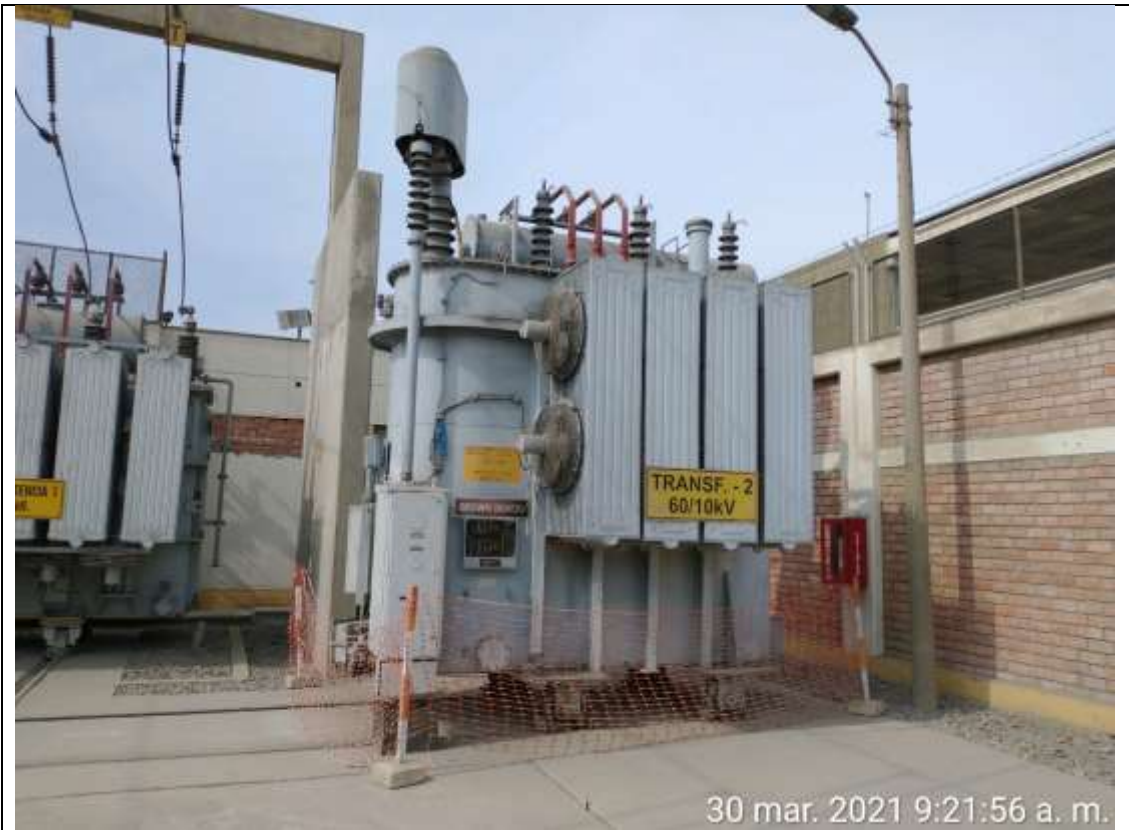
Foto 4. SET Industrial. Transformador retirado definitivamente de operación de 25 MVA, 60/10 kV (Año 1960)
