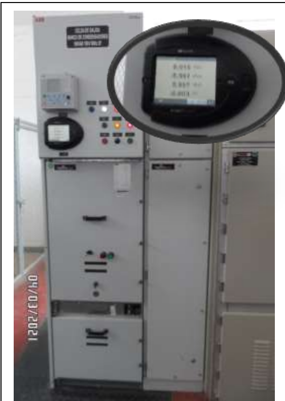
Foto 9. SET PAITA. Celda de compensador 10 kV, tipo metal clad, interior, simple barra.
