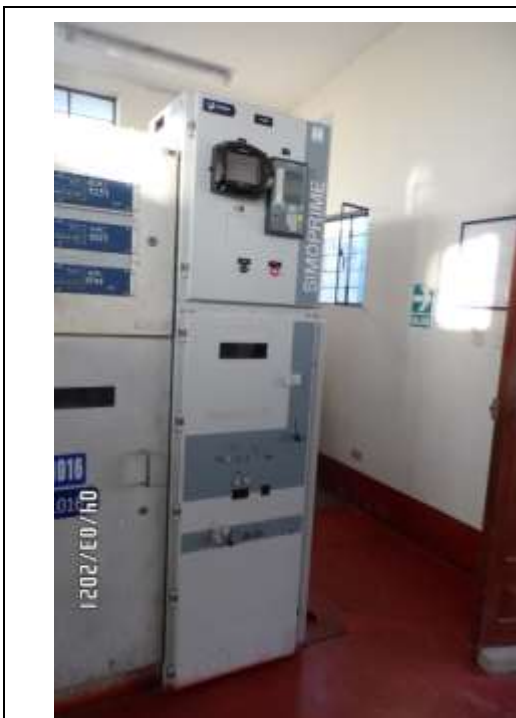
Foto 5. SET ZARUMILLA. Celda de compensador 10 kV, tipo metal clad, interior, simple barra.
