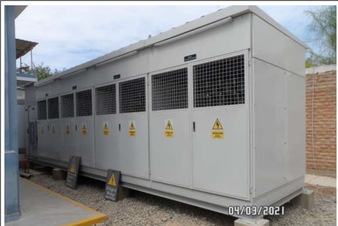
Foto 8. SET PAITA. Banco de condensadores de 4x6x250 KVAR
