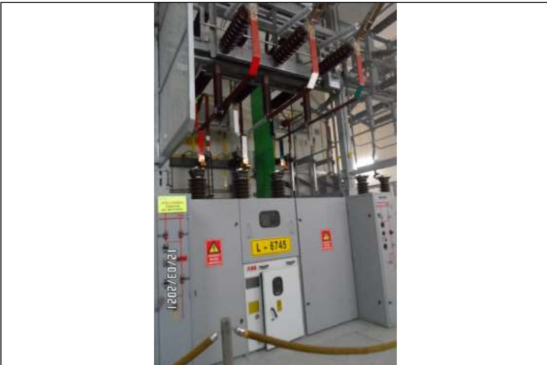
Foto 4. SET Tacna. Celda L-6745 a SET Malvinas. Celda Convencional 60 kV. Doble Barra. Interior. Icc de 31,5 kA.
