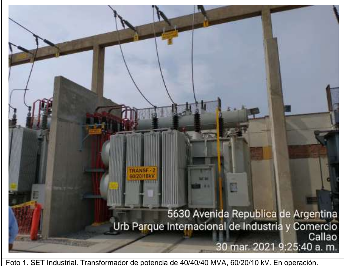
Foto 1. SET Industrial. Transformador de potencia de 40/40/40 MVA, 60/20/10 kV. En operación.
