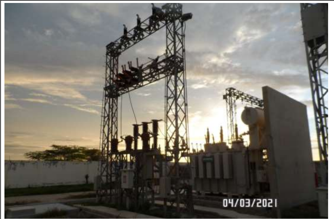
Foto 14. SET ZARUMILLA. Celda de transformador 23 kV. Concluido el montaje electromecánico, falta el conexionado de equipos. Obra paralizada por retiro del contratista.
