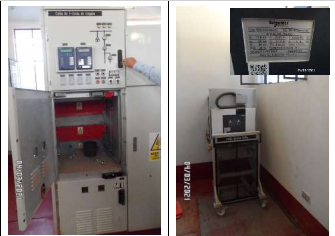
Fotos 15 y 16. SET ZARUMILLA. Celda de transformador 10 kV, tipo metal clad, interior, simple barra. Interruptor sin instalar. Obra paralizada por retiro del contratista.
