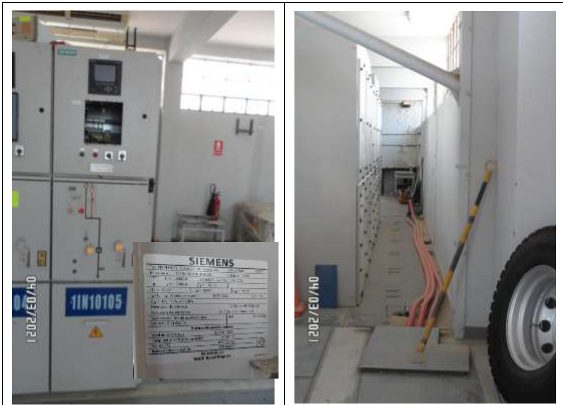
Fotos 11 y 12. SET SULLANA. Celda de Alimentador 10 kV, tipo metal clad, interior, simple barra. Del Año 2013. Incumple numeral 5.8
