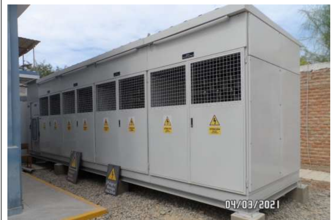
Foto 1. SET SULLANA. Banco de condensadores de 4x6x250 KVAR
