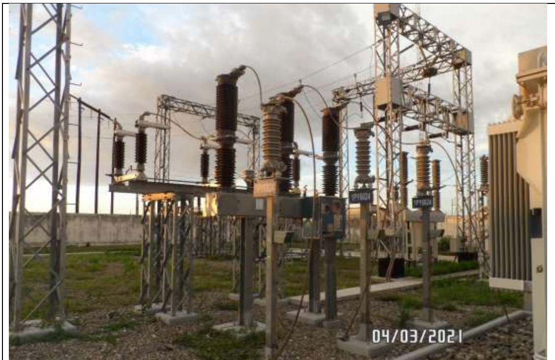
Foto 13. SET ZARUMILLA. Celda de transformador 60 kV. Concluido el montaje electromecánico, falta el conexionado de equipos. Obra paralizada por retiro del contratista.
