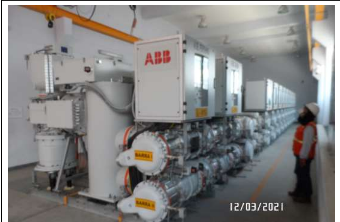
Foto 1. SET Malvinas. Celda GIS 60 kV.
