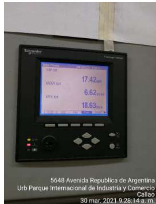
Foto 3. SET Industrial. Lecturas de potencia del nuevo transformador.
