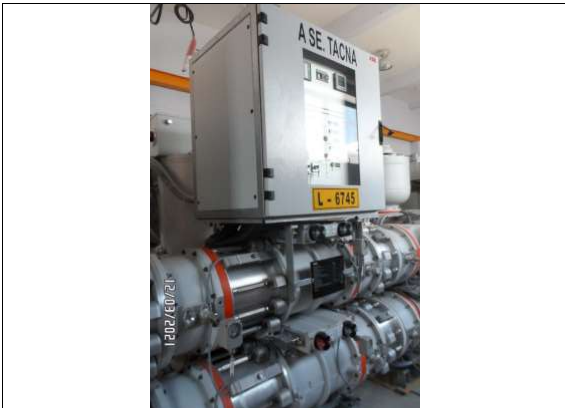
Foto 2. SET Malvinas. Celda L-6745 a SET Tacna. Celda GIS 60 kV. Doble Barra. Interior. Icc de 40 kA.
