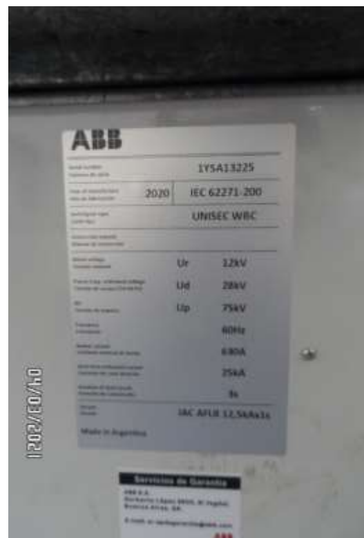
Foto 10. SET PAITA. Placa de celda de compensador.
