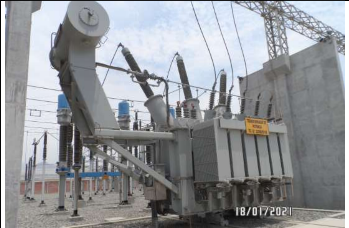
Foto 19. SET MEDIO MUNDO. Transformador de 50 MVA, 220/60/10 kV
