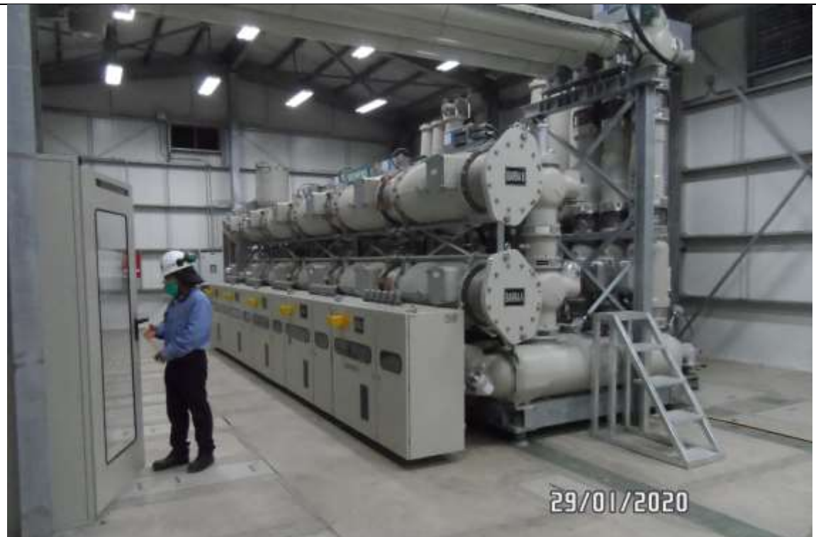
Foto 31. SET SAN LUIS. Sala de celdas GIS de 220 kV
