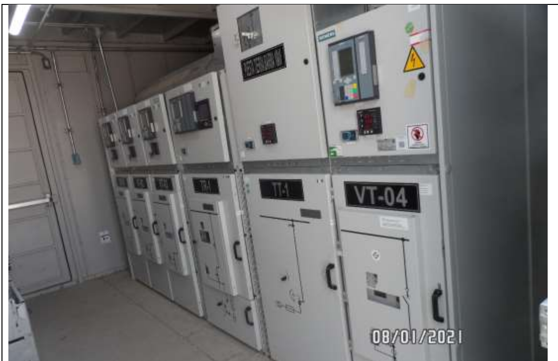
Foto 4. SET VERTIENTES. Celdas metal clad 10 kV. En operación celda VT-04.
