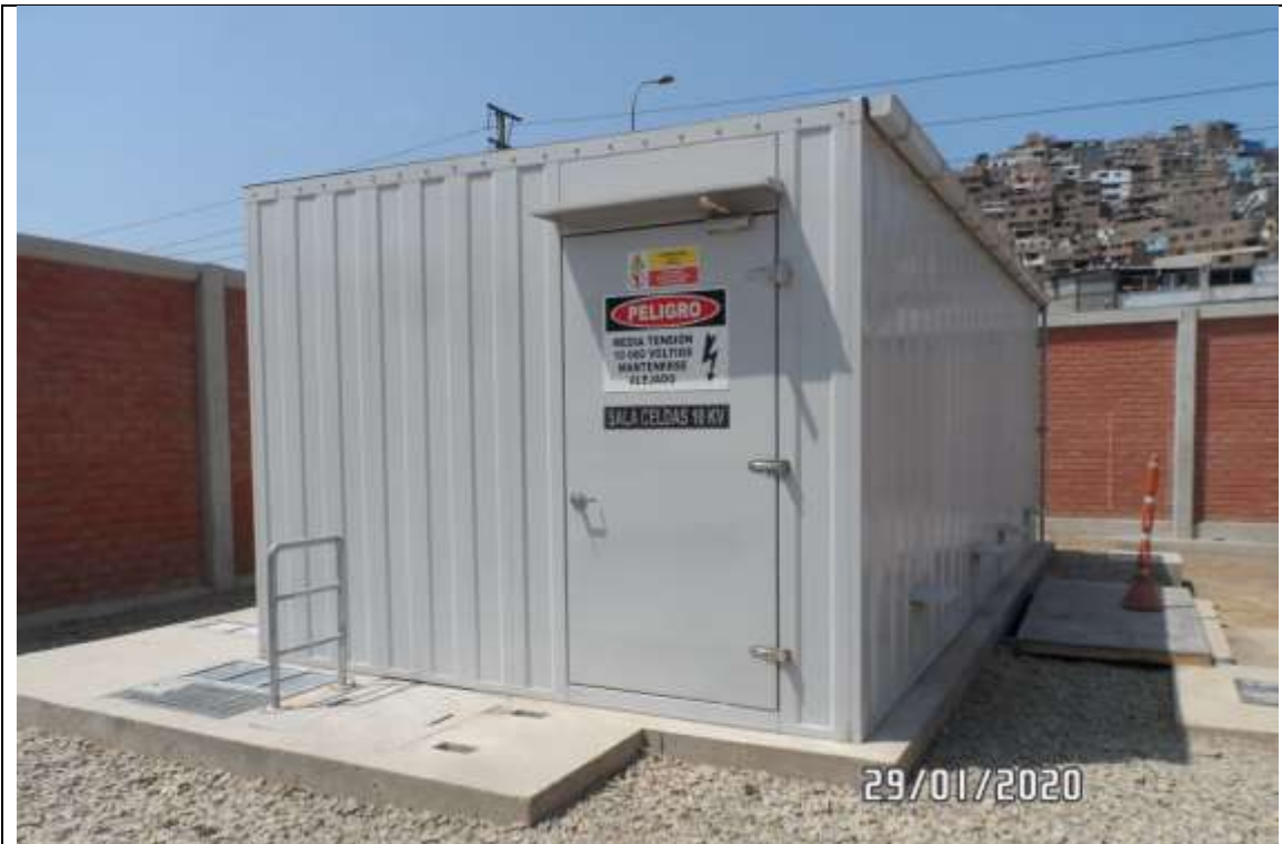
Foto 32. SET SAN LUIS. Celdas metal clad de 10 kV en encerramiento metálico diseñado por SIEMENS
