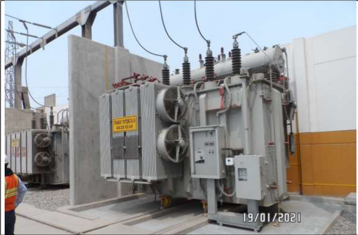
Foto 25. SET PUENTE PIEDRA. Transformador 30/40 MVA, 60/20/10 kV.
