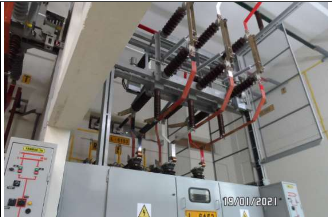
Foto 24. L-6153. SET PERSHING. Celda de línea 60 kV de L-6153.
