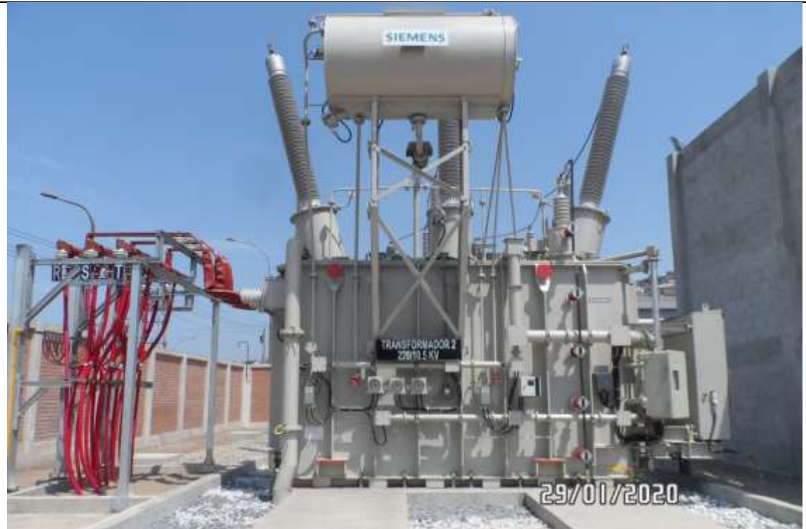
Foto 30. SET SAN LUIS. Transformador de Potencia 50 MVA, 220/10 kV
