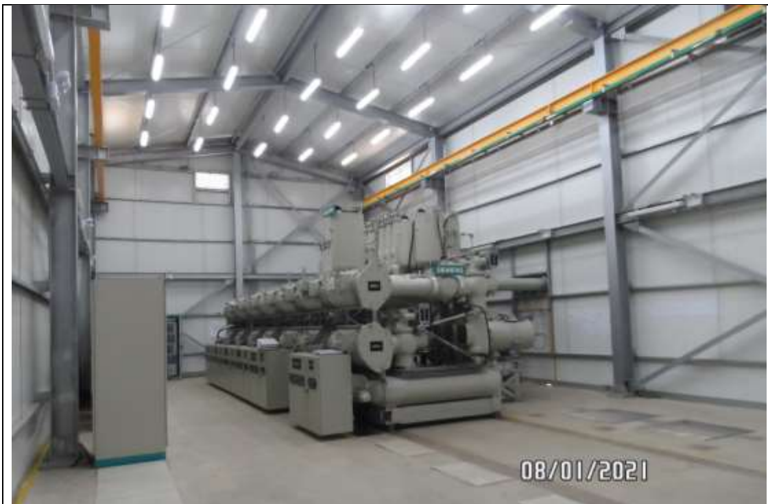
Foto 2. SET PACHACUTEC. Bahías GIS 220 kV. En operación 2 celdas de líneas (hacia SET Manchay), 1 celda de transformación y 1 celda de acoplamiento. Sin servicio 2 celdas de línea (hacia SET Progreso).
