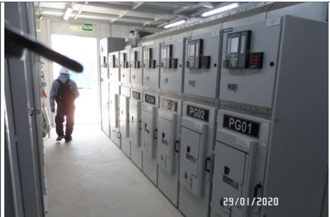
Foto 37. SET PROGRESO. Celdas metal clad en 10 kV
