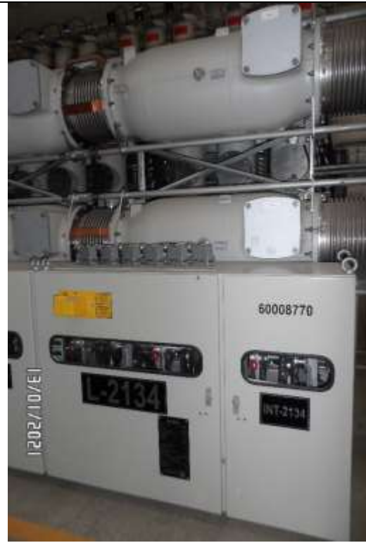
Foto 5. SET MANCHAY. Bahía 220 kV de línea L-2134.
