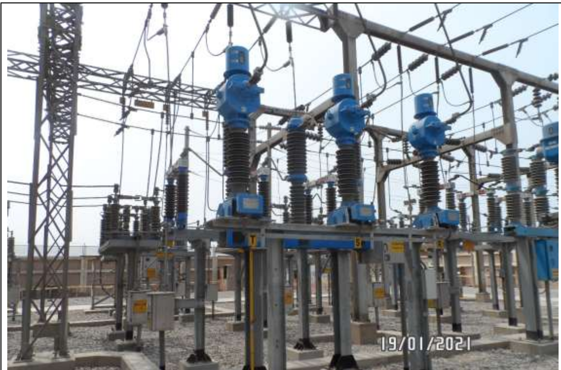
Foto 26. SET PUENTE PIEDRA. Celda de Transformador 60 kV.
