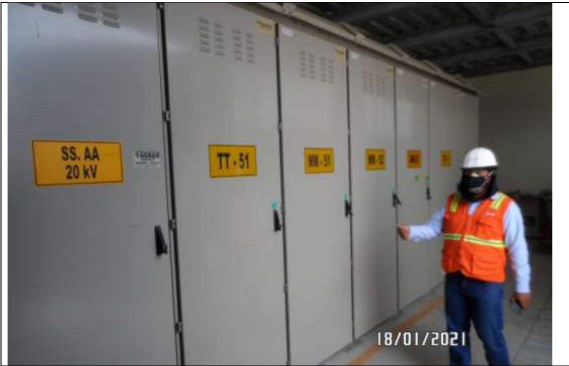
Foto 21. SET MEDIO MUNDO. Celdas metal clad en 22,9 kV
