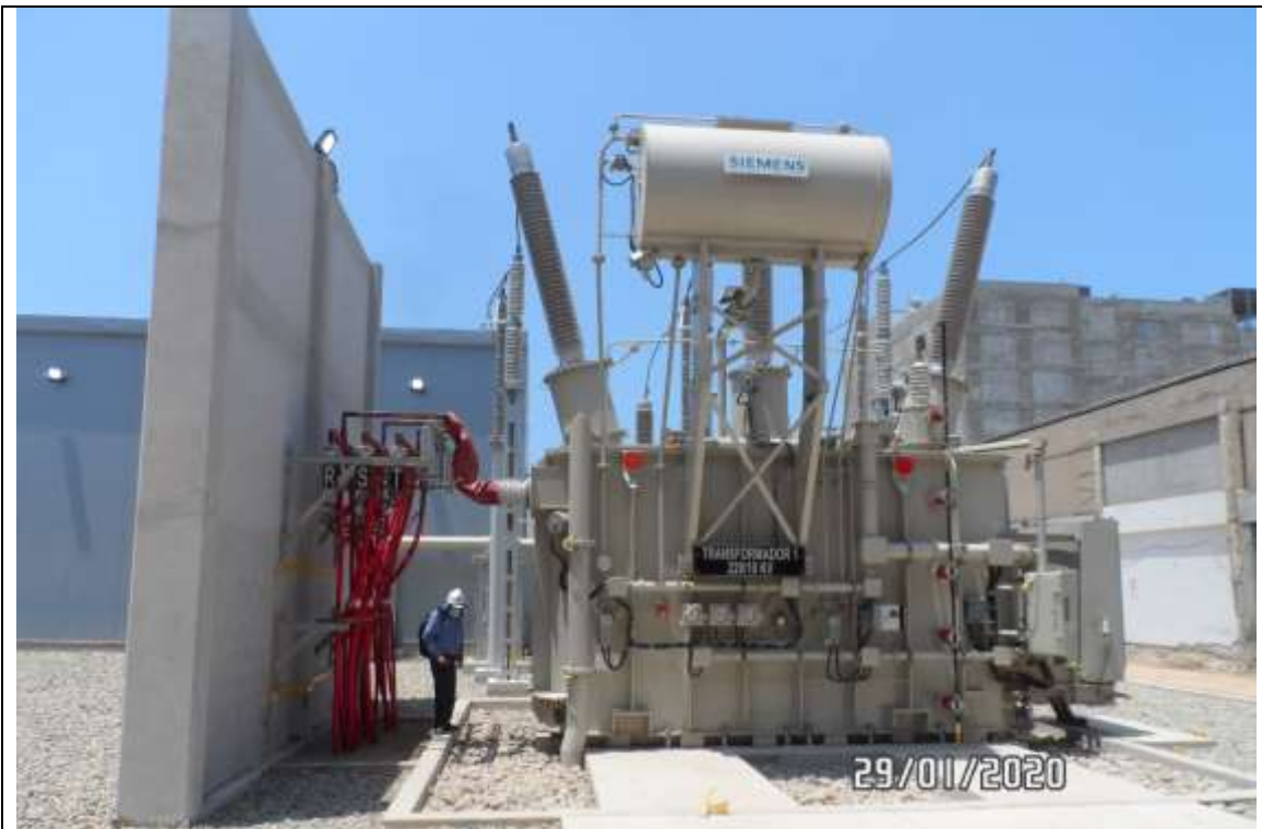
Foto 35. SET PROGRESO. Transformador de Potencia 50 MVA, 220/10 kV
