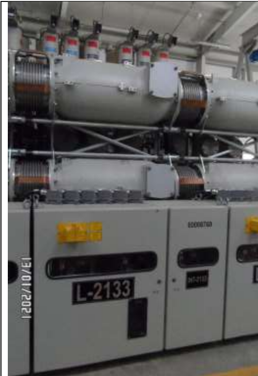
Foto 3. SET MANCHAY. Bahía 220 kV de línea L-2133.
