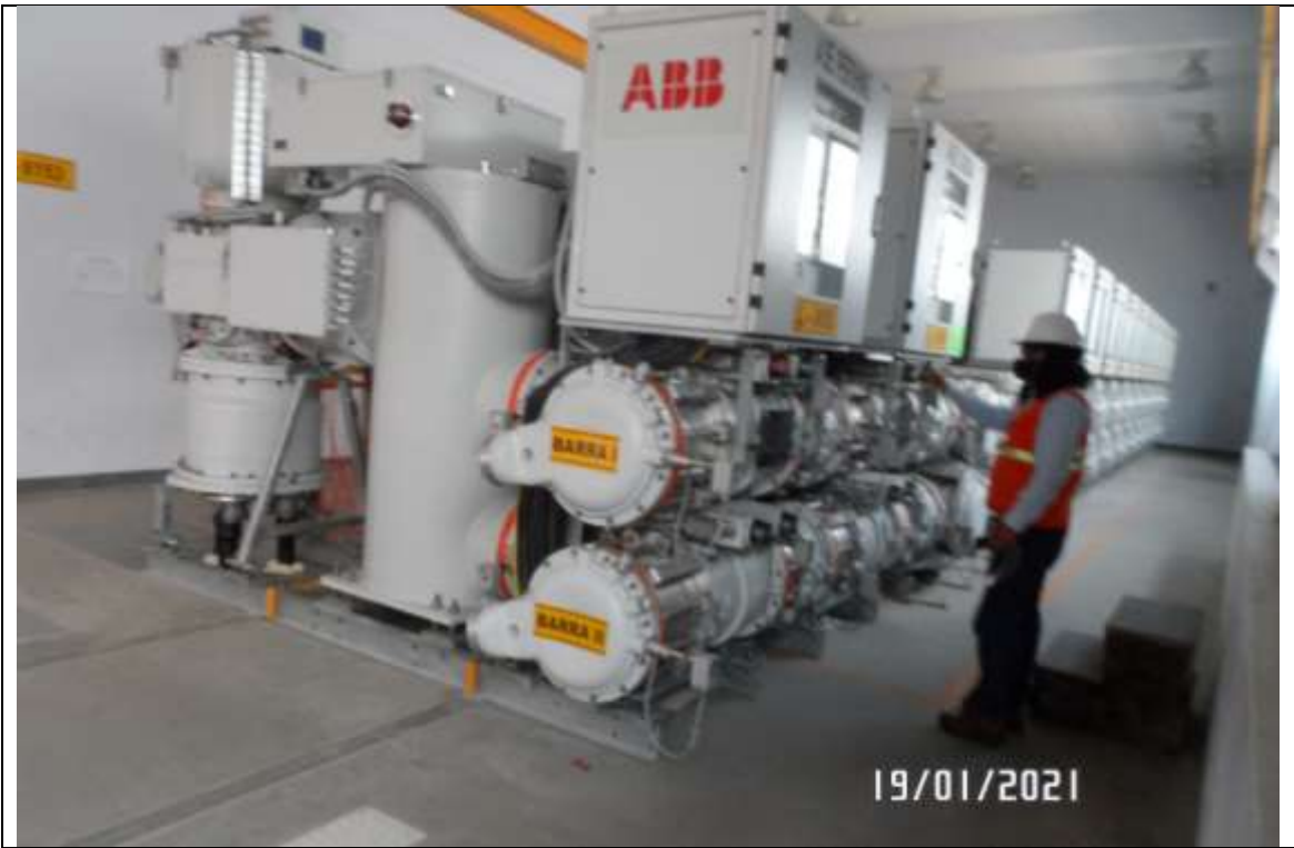
Foto 23. L-6153. SET MALVINAS. Celda de línea 60 kV de L-6153
