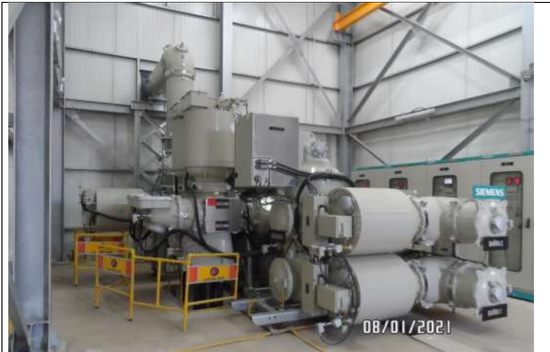
Foto 3. SET PACHACUTEC. Bahías GIS 60 kV. En operación 2 celdas de línea (hacia SET Vertientes), 1 celda de transformación y 1 celda de acoplamiento.
