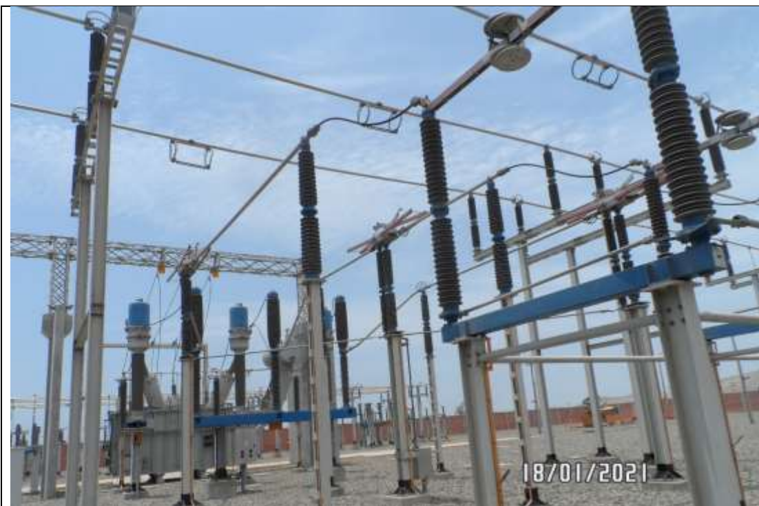
Foto 17. SET MEDIO MUNDO. Celda de transformador 220 kV
