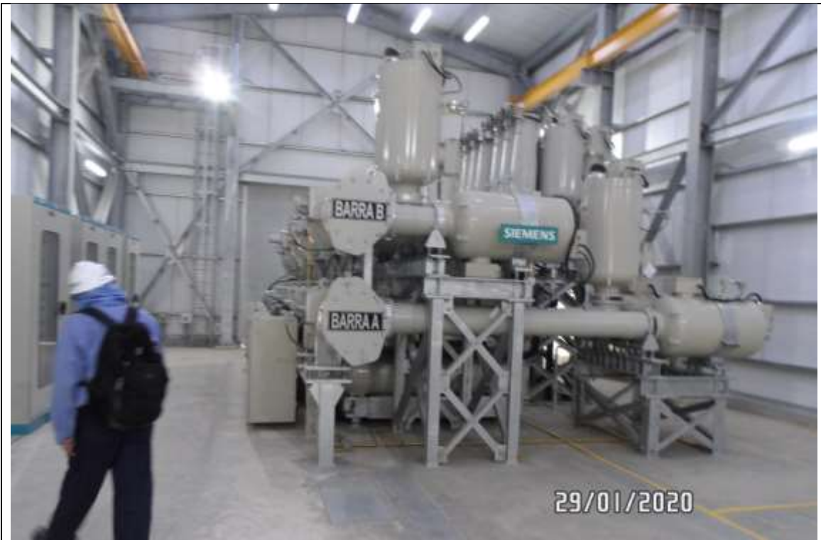
Foto 34. SET PROGRESO. Sala de celdas GIS de 220 kV
