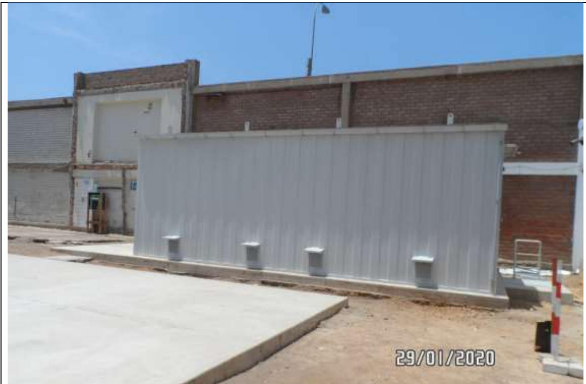
Foto 36. SET PROGRESO. Celdas metal clad de 10 kV en encerramiento metálico diseñado por SIEMENS.
