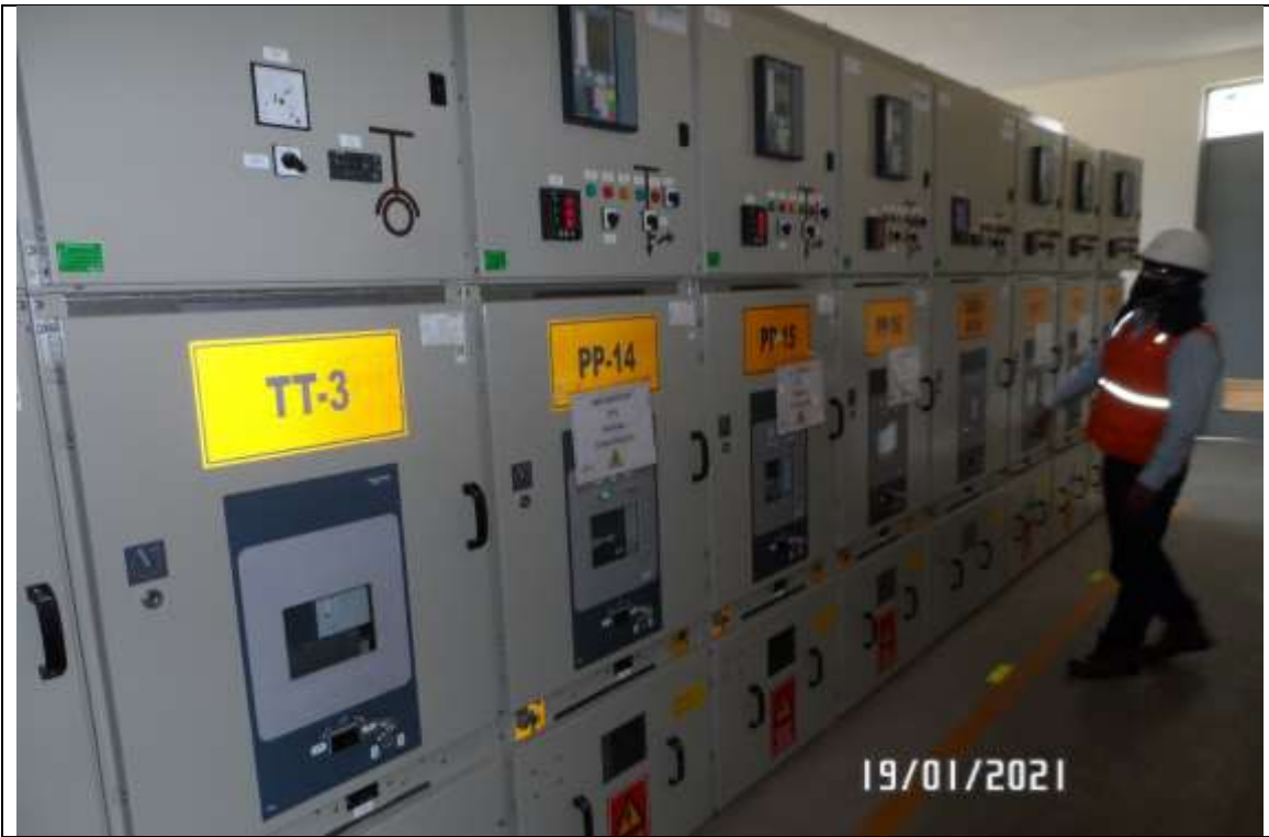
Foto 27. SET PUENTE PIEDRA. Celdas metal clad de 10 kV
