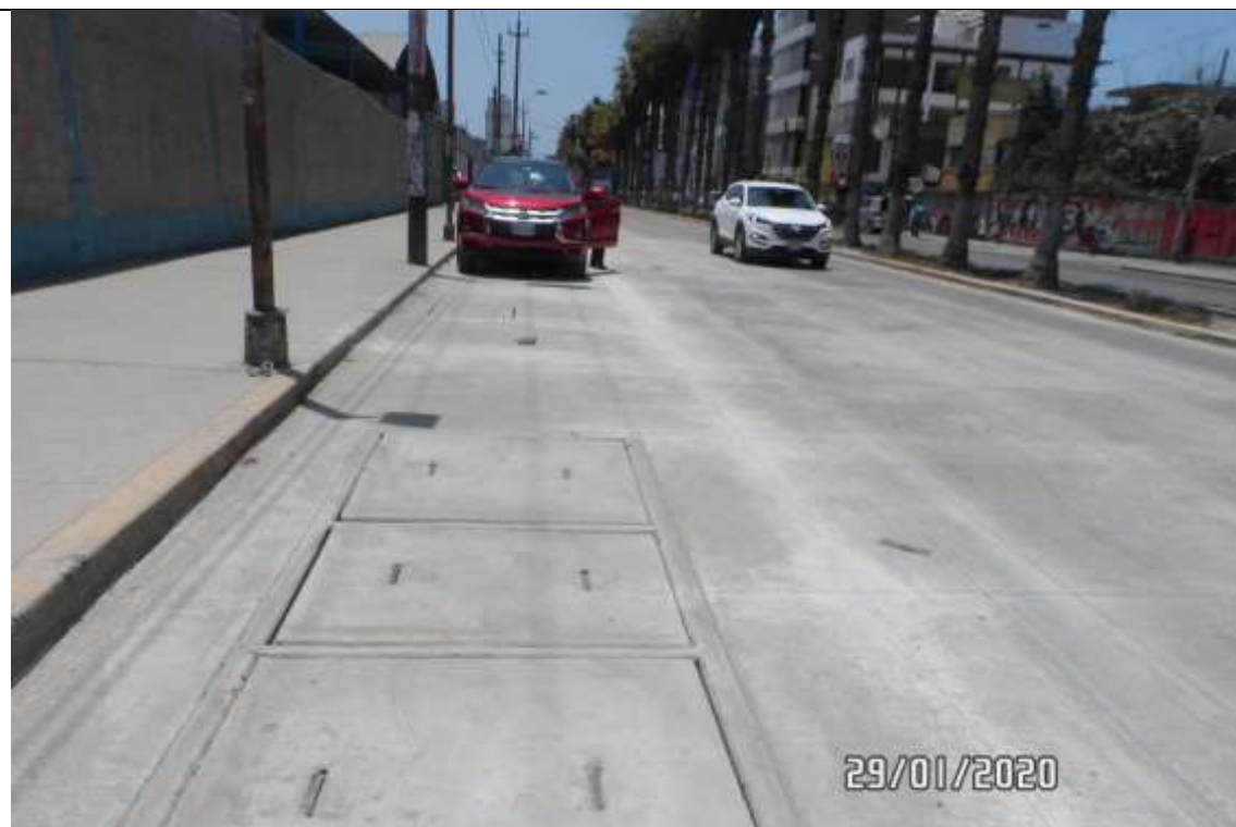
Foto 38. L-2135/I-2136 Pachacutec- Progreso. Recorrido de la línea subterránea Enductada. Cámaras de empalme.
