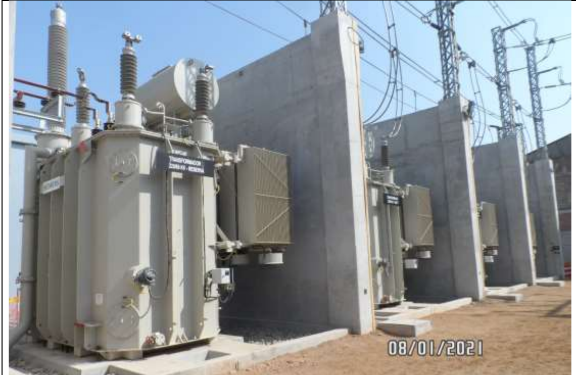
Foto 1. SET PACHACUTEC. Polo de reserva de 80 MVA, 220/60/10 kV.
