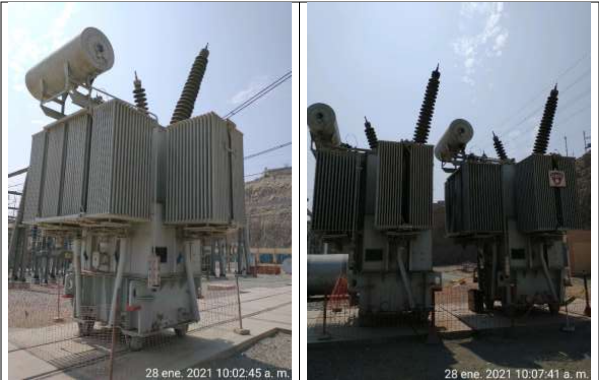
Fotos 28 y 29. Baja de Banco de Transformadores 220/60/10 kV – 3x40 (120) MVA, SET MAT/AT Mirador.
