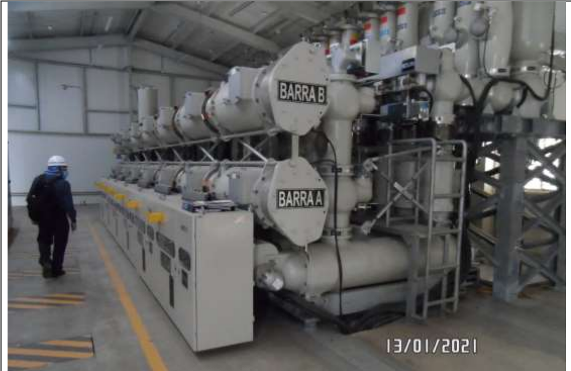
Foto 2. SET MANCHAY. Bahías GIS 220 kV.
