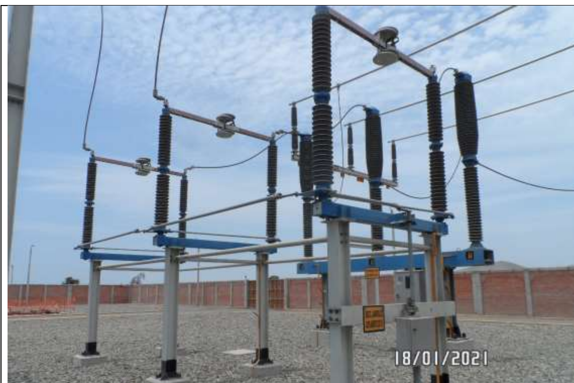
Foto 18. SET MEDIO MUNDO. Celda de acoplamiento 220 kV (seccionadores e interruptor)
