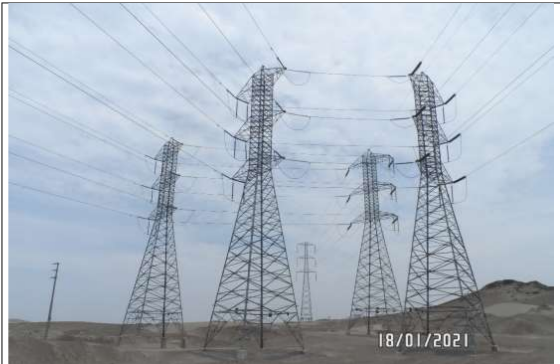
Foto 12. SET MEDIO MUNDO. Línea L-2125/L-2126 (Paramonga – Medio Mundo) y L-2279/L-2213 (Medio Mundo/Huacho). Derivación de la línea doble terna Paramonga – Huacho.
