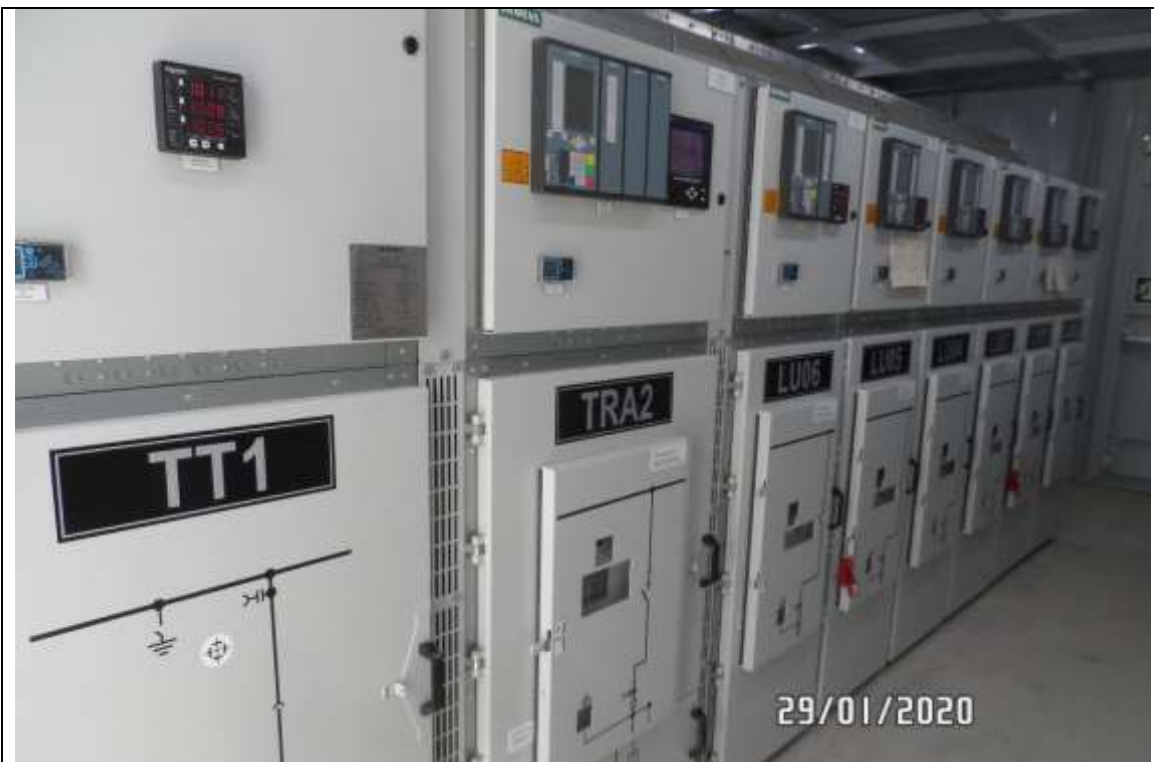
Foto 33. SET SAN LUIS. Celda metal clad de 10 kV.
