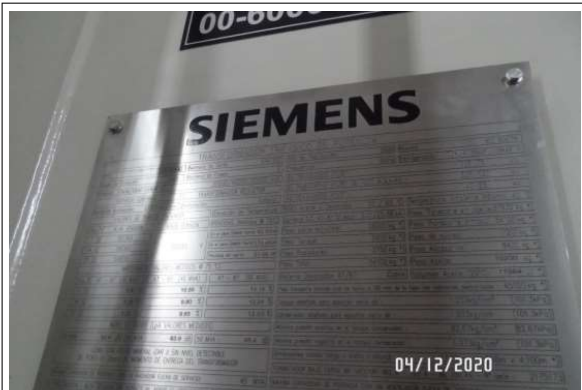
Foto 3. SET BALNEARIOS. Placa de características de transformador de 50 MVA, 60/10 kV.
