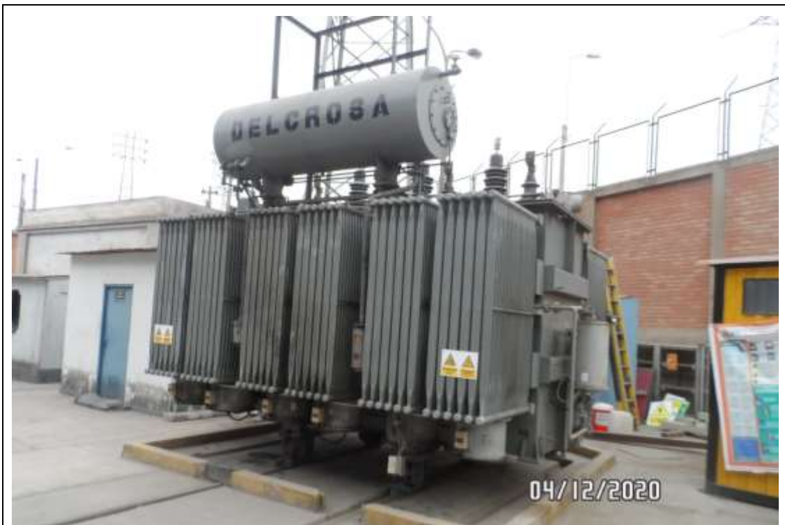
Foto 6. SET BALNEARIOS. Transformador de 25 MVA, 60/10 kV desconectado de la red de transmisión.
