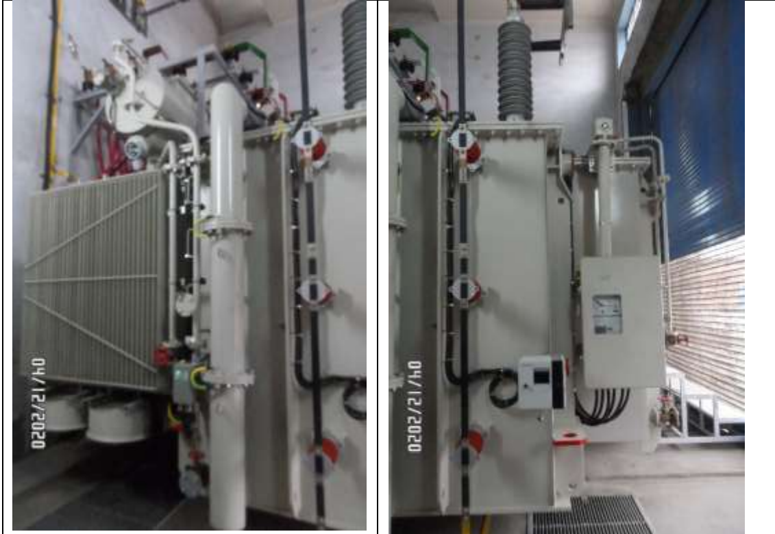
Fotos 1 y 2. SET Balnearios. En operación transformador de 50 MVA, 60/10 kV, de instalación al interior, en reemplazo de transformador de 25 MVA, 60/10 kV del año 1984
