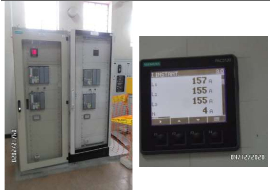
Fotos 4 y 5. SET BALNEARIOS. Tablero de protección, control y medición (lado derecho) del transformador nuevo.
