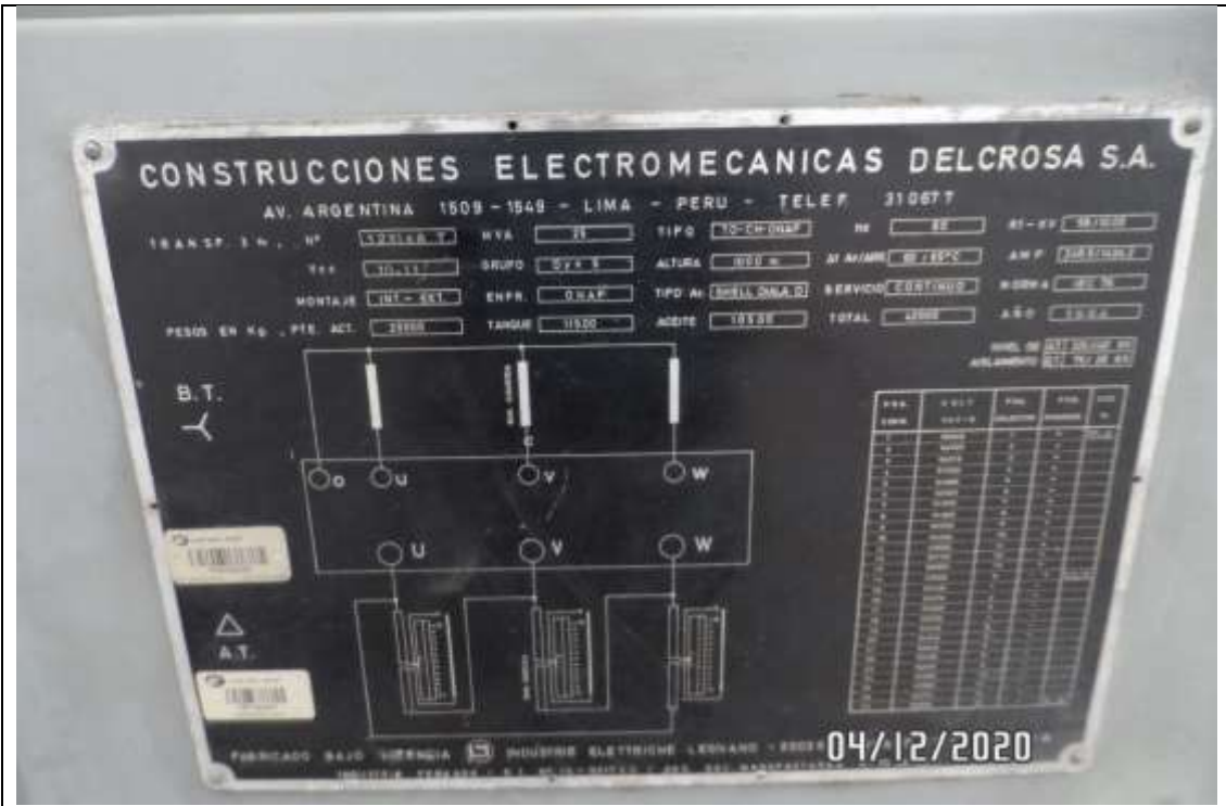
Foto 7. SET BALNEARIOS. Placa de características de transformador de 25 MVA, 60/10 kV, desconectado de la red de transmisión.
