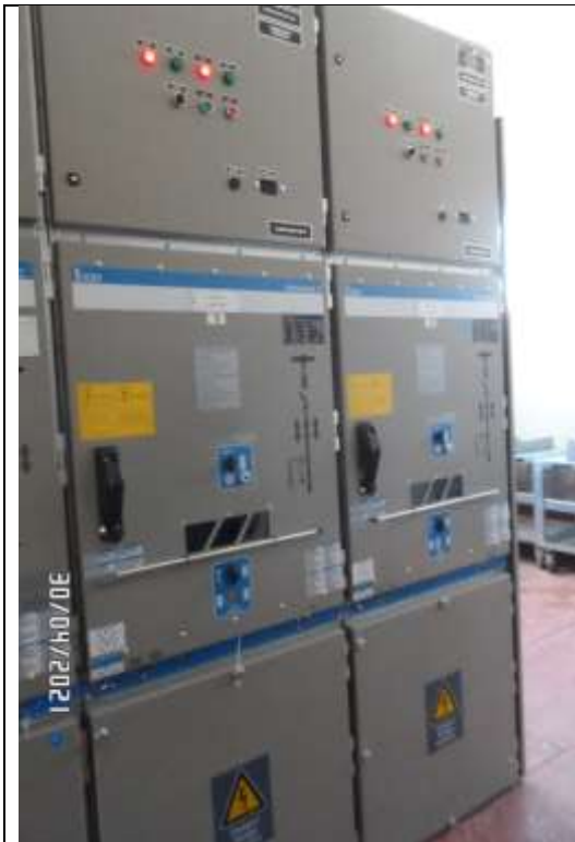
Foto 4. SET PEDREGAL. Celdas metal clad en 10 kV. Códigos PE 106 y PE 107.
