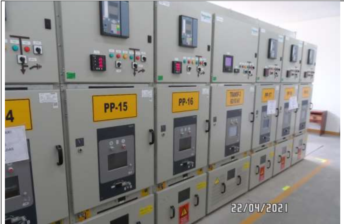
Foto 3. SET Puente Piedra. En operación celdas de alimentador en 10 kV códigos PP-15 y PP-16.
