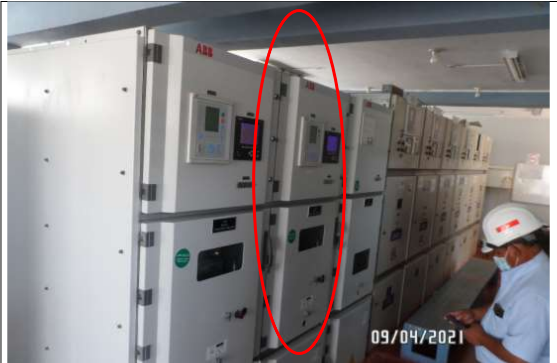
Foto 1. SET Malacas. Celda de alimentador 13,2 kV (2da desde la izquierda). En operación. Código A-1306.
