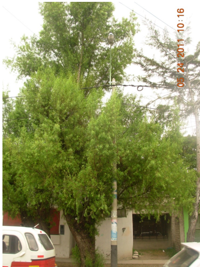
Foto N° 02. Conductor de BT y cable de acometida en contacto con árboles. Av. Los Sauces Cdra. 3, frente al SUM 45496207
