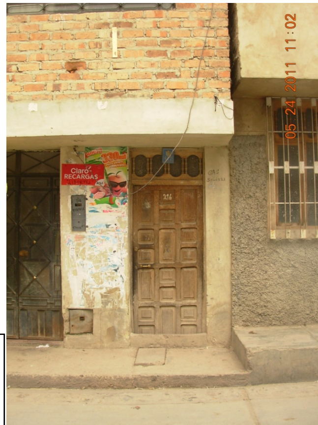
Foto N° 04. Cable de acometida no cumple la distancia de seguridad al nivel del piso. Jr. Amancaes 422. Referencia SUM 45565636.
