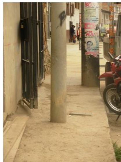
Foto N° 01. Poste de concreto de BT, instalado en medio de la vereda. Av. San Martín N° 736. Referencia SUM 45838448.
