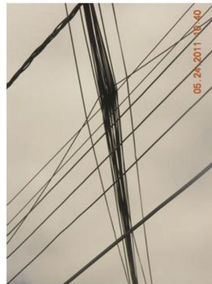
Foto N° 06. Cruce de redes eléctricas con cables telefónicos, están en contacto. Esquina de Arnaldo Marquez con Jr. Amancaes. Referencia SUM 45406872.
