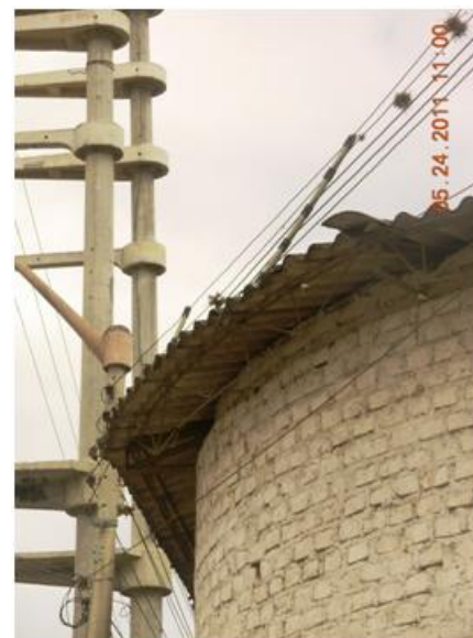
Foto N° 05. Conductor de BT en contacto con techo de edificación. Arnaldo Marquez con Jr. Amancaes. Referencia SUM 45643358.
