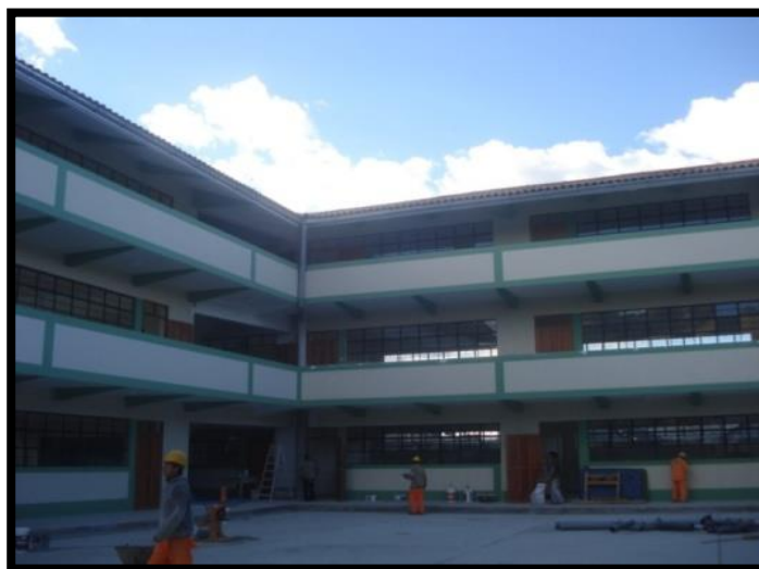
Mejoramiento y ampliación del servicio educativo en el colegio ESPMA San Nicolás (Huamachuco, La Libertad)
