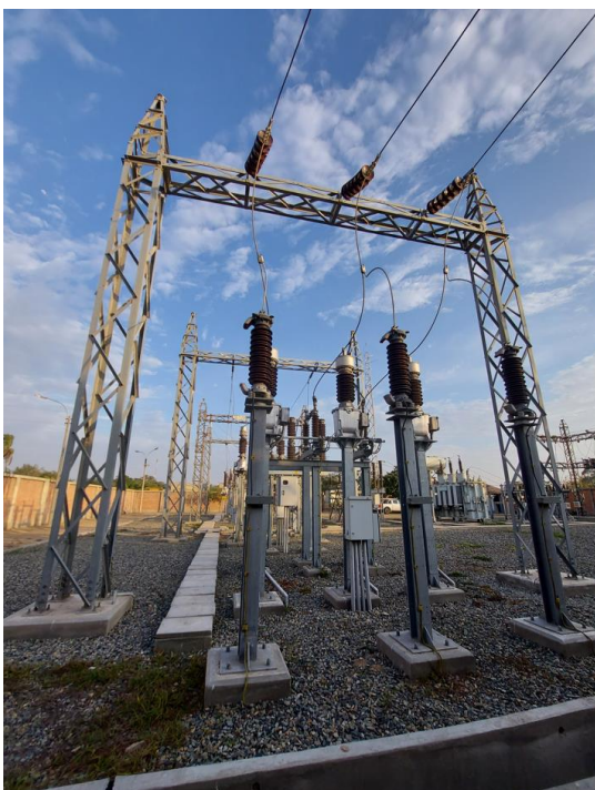
Fotos de equipos de celda 60 kV en la SET Cayaltí
