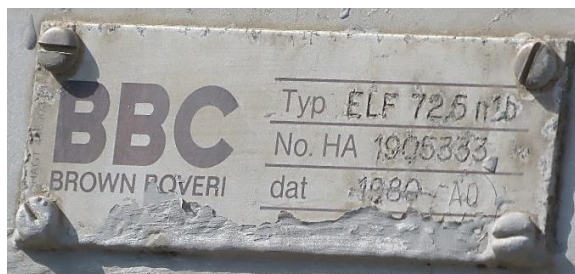
CELDA DE LLEGADA TRANSFORMADOR IN 1009 (TP 6003)
