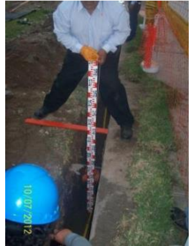
Registro fotográfico del cumplimiento de la distancia mínima a interferencias
