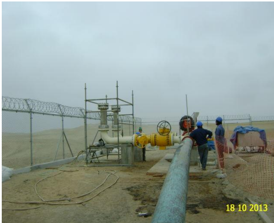
Válvula de seccionamiento (PK 20+650).
