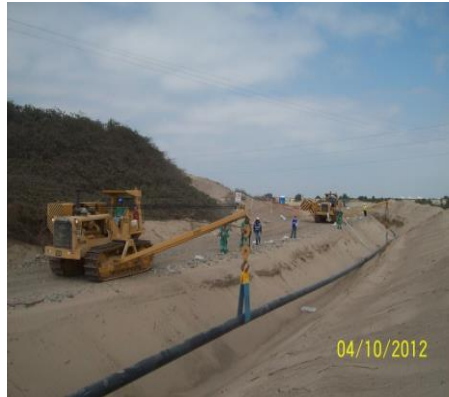
Bajada de una tubería curvada.
