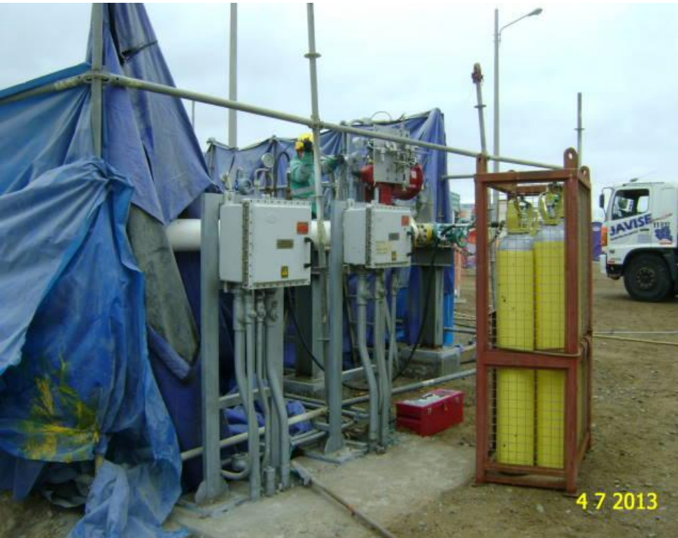
Cilindros de nitrógeno para realizar la inertización
