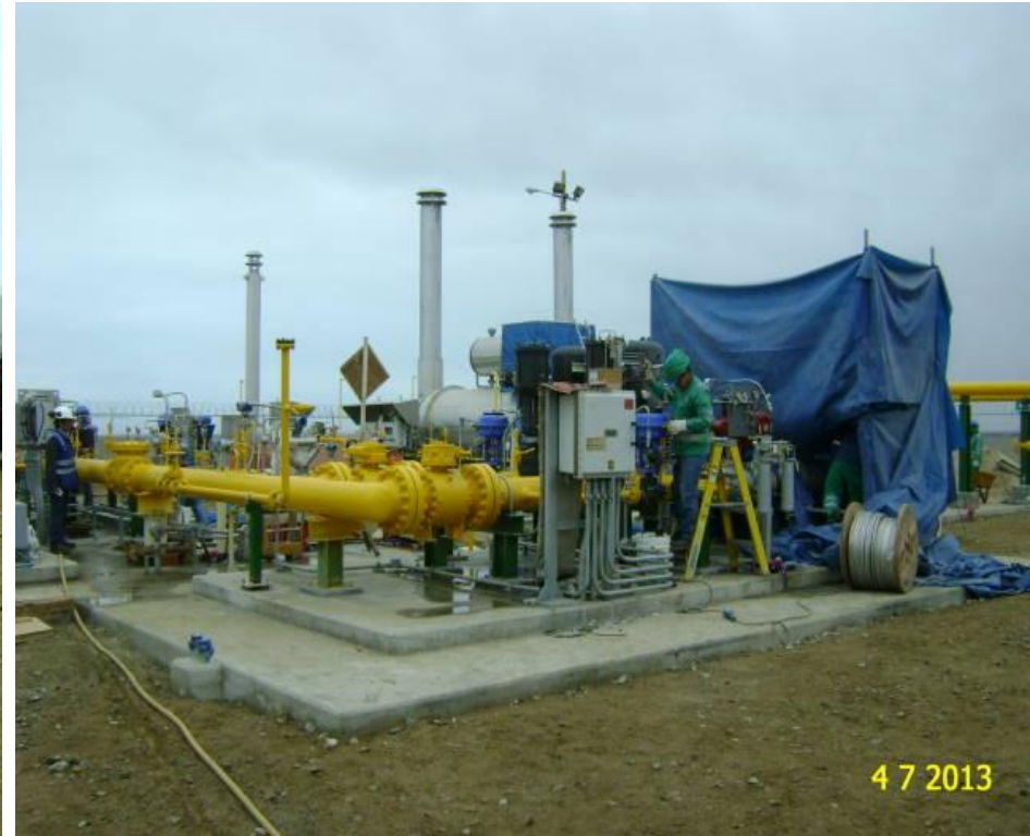
Conexiones eléctricas en unidad de regulación
