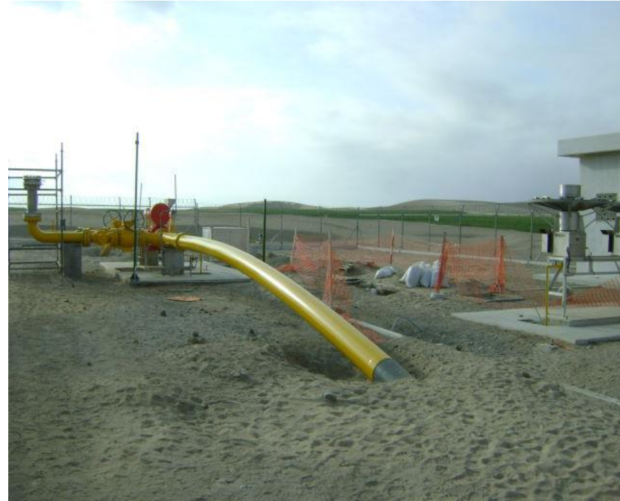
Válvula de seccionamiento (PK 20+650).
