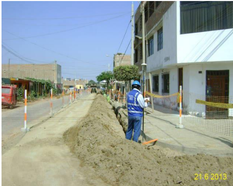
Registro de tubería de PE hacia interferencias.
