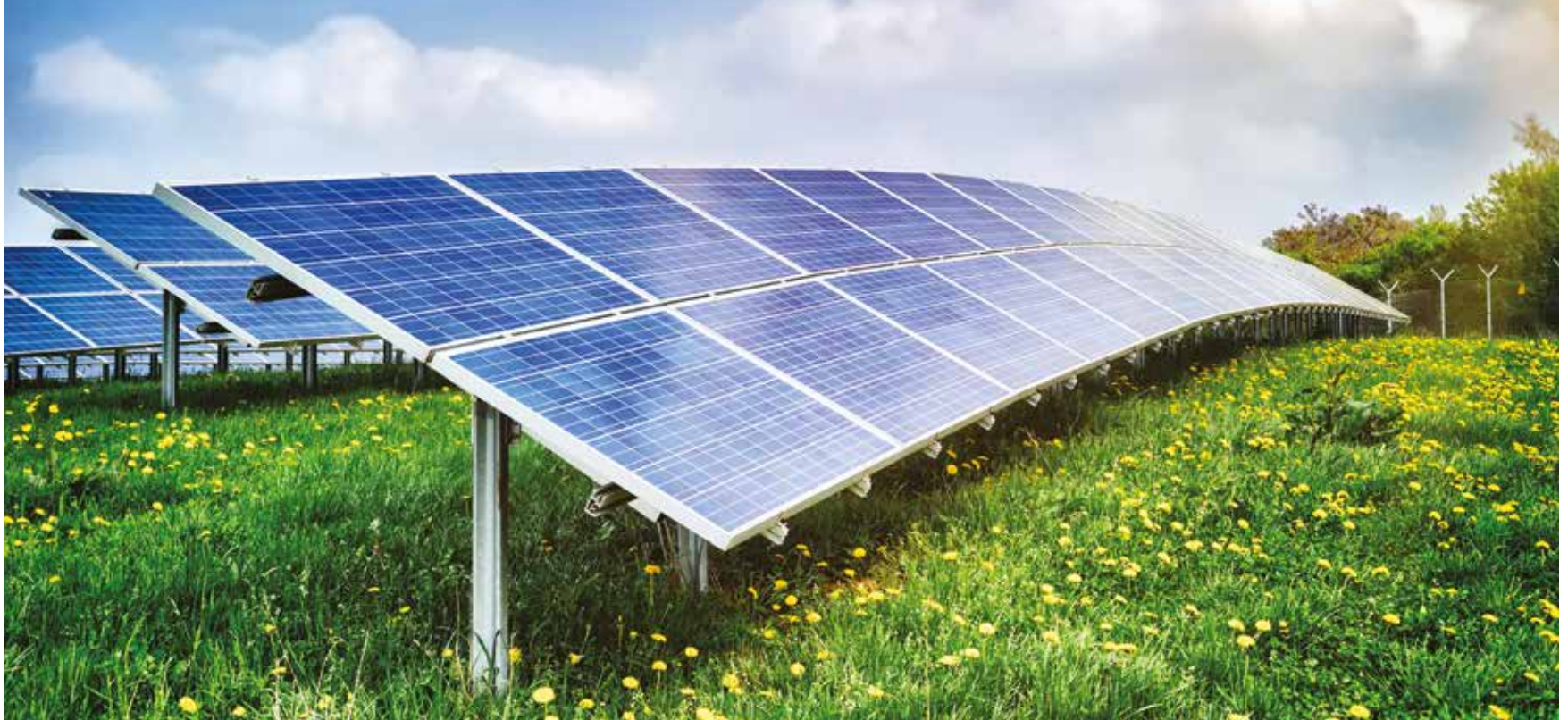
Paneles de energía solar.
