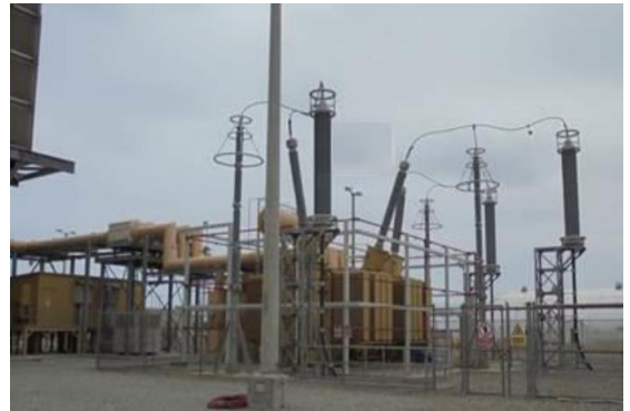
Transformador de una unidad de generación
