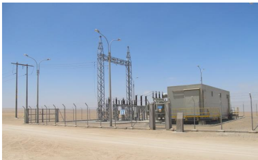
Subestación de transformación
