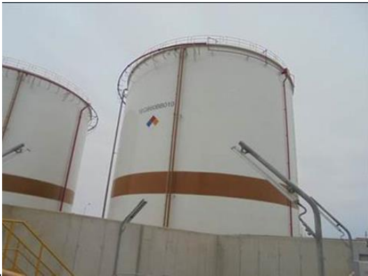
Vista de tanques de combustible CT. Reserva Fría ETEN
