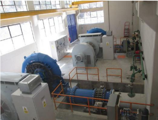
Sala de Máquinas
