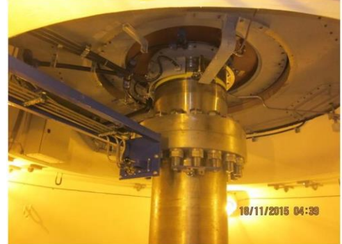
Parte superior del eje turbina - generador
