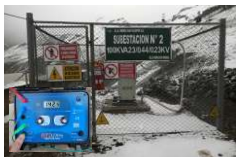
Medición de puesta a tierra de SE. N° 2 en San Valentín, que sobrepasa el nivel de resistencia máximo que debe tener la puesta a tierra. Fuente: Osinergmin
