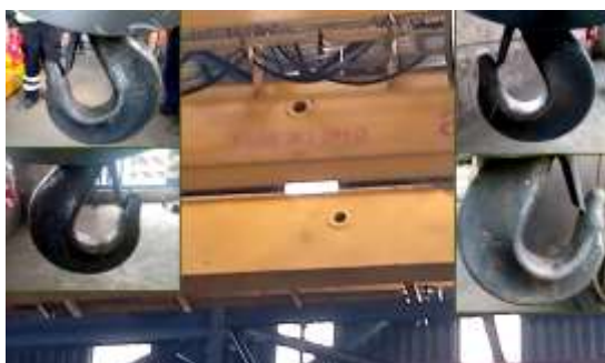
Ganchos del puente grúa N° 4 del depósito de concentrados de Matarani de TISUR, no cuenta con los puntos de control para deformación. Fuente: Osinergmin
